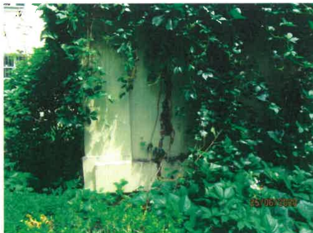
Fot. 4 - Mur graniczny - widok od strony południowej, pęknięcie pionowe, odchylenie od pionu.
