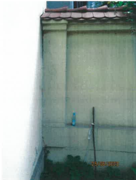
Fot. 9 - Mur graniczny - widok od strony zachodniej, pęknięcie poziome z przesunięciem
