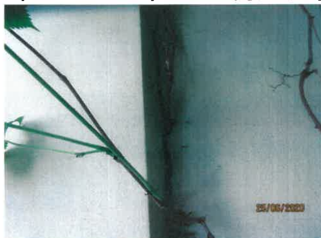
Fot. 7 - Mur graniczny - widok od strony zachodniej, pęknięcie pionowe
