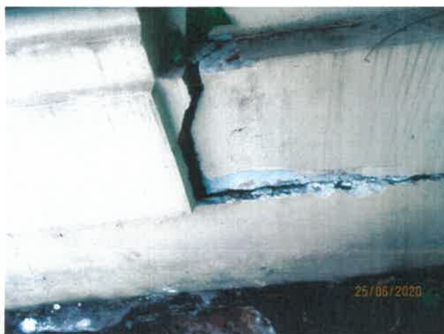
Fot. 6 - Mur graniczny - widok od strony zachodniej, pęknięcie pionowe i poziome
