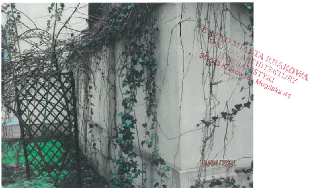
Fot. 3 Mur graniczny na terenie wewnętrznego dziedzińca budynku, ul. Gołębia 9, Kraków, wł. Uniwersytet Jagielloński. Od lewej: elewacja zachodnia i narożnik muru. Stan przed konserwacją. Kwiecień 2021. Fot. K. Sułkowska
