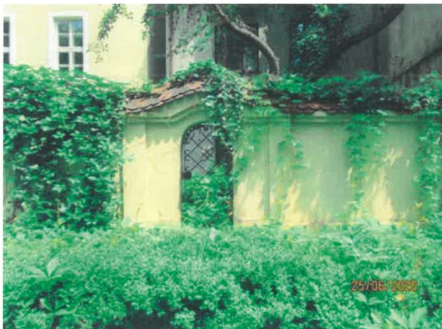
Fot. 1 Mur graniczny na terenie wewnętrznego dziedzińca budynku, ul. Gołębia 9, Kraków, wł. Uniwersytet Jagielloński. Elewacja południowa muru, brama. Stan przed konserwacją. Czerwiec 2020. Fot. K. Sułkowska
