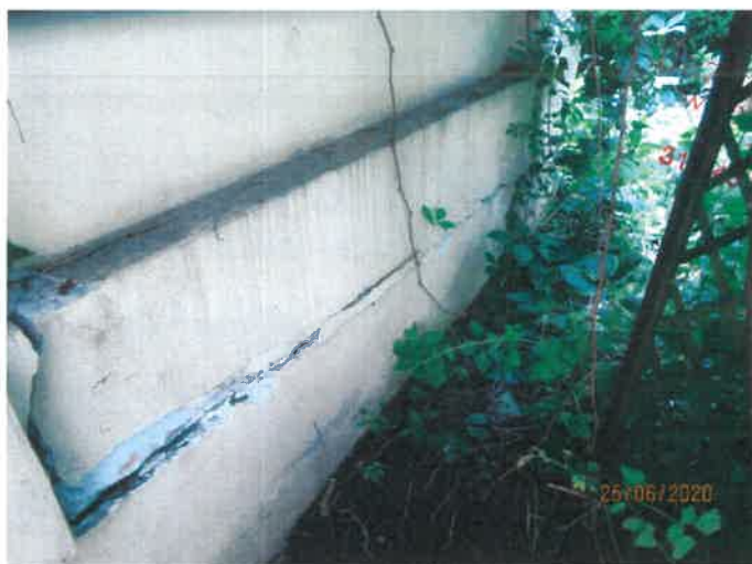
Fot. 10 - Mur graniczny - widok od strony zachodniej, pęknięcie poziome z przesunięciem
