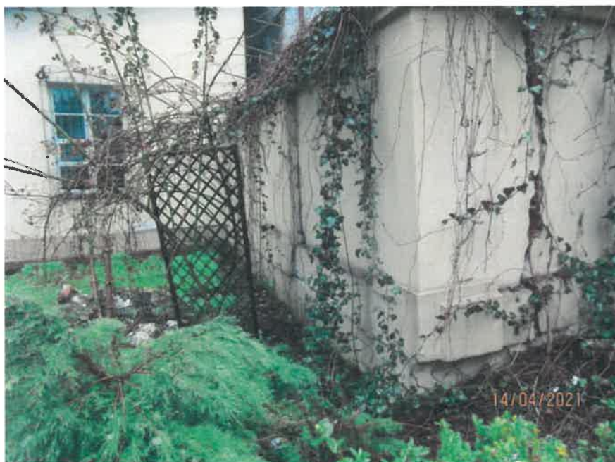
Fot. 4 Mur graniczny na terenie wewnętrznego dziedzińca budynku, ul. Gołębia 9, Kraków, wł. Uniwersytet Jagielloński. Narożnik muru. Stan przed konserwacją. Kwiecień 2021. Fot. K. Sułkowska
