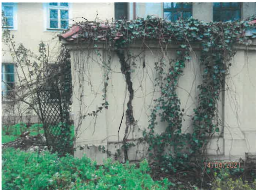
Fot. 2 Mur graniczny na terenie wewnętrznego dziedzińca budynku, ul. Gołębia 9, Kraków, wł. Uniwersytet Jagielloński. Elewacja południowa muru. Stan przed konserwacją. Kwiecień 2021. Fot. K. Sułkowska
