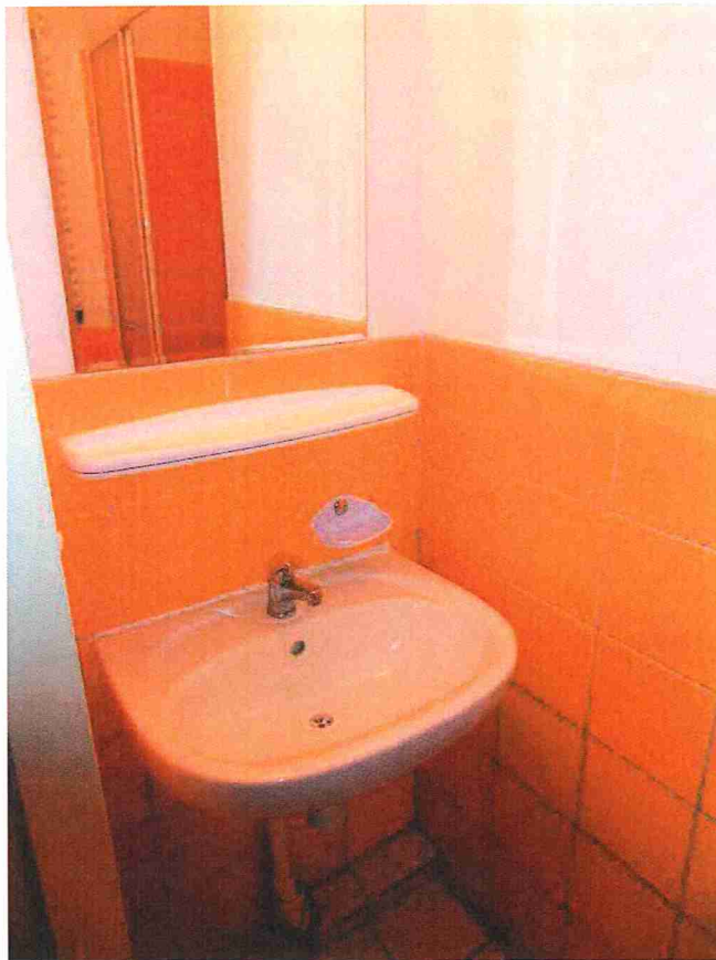
Fot. 2. Stan istniejący – widok na umywalkę
