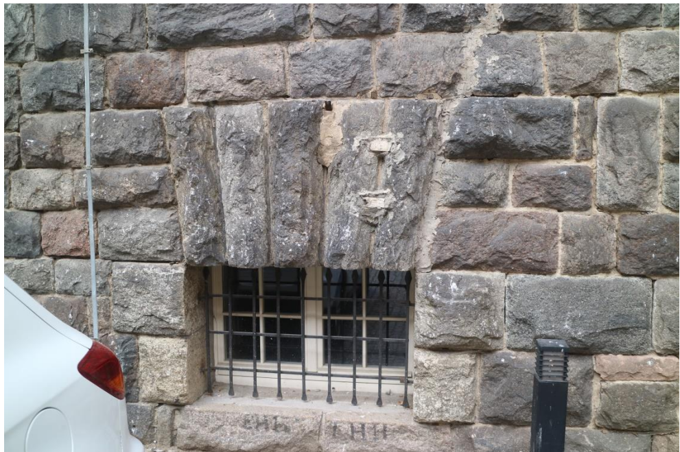
Fragmenty cokołu, uszkodzenia związane z pękaniem oraz miejsce uzupełnienia- jasny kamień, źle dobrana wielkość ciosów.
