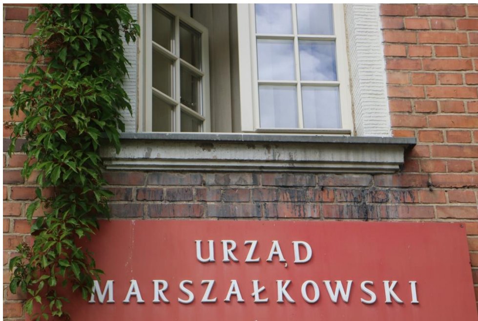
Widok czarnych zacieków smołą.
