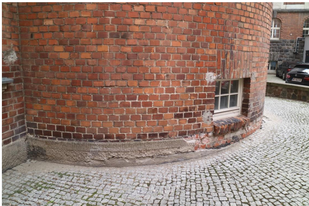
Widok ogólny i zbliżenie rotundy, w partii cokołu liczne uszkodzenia
