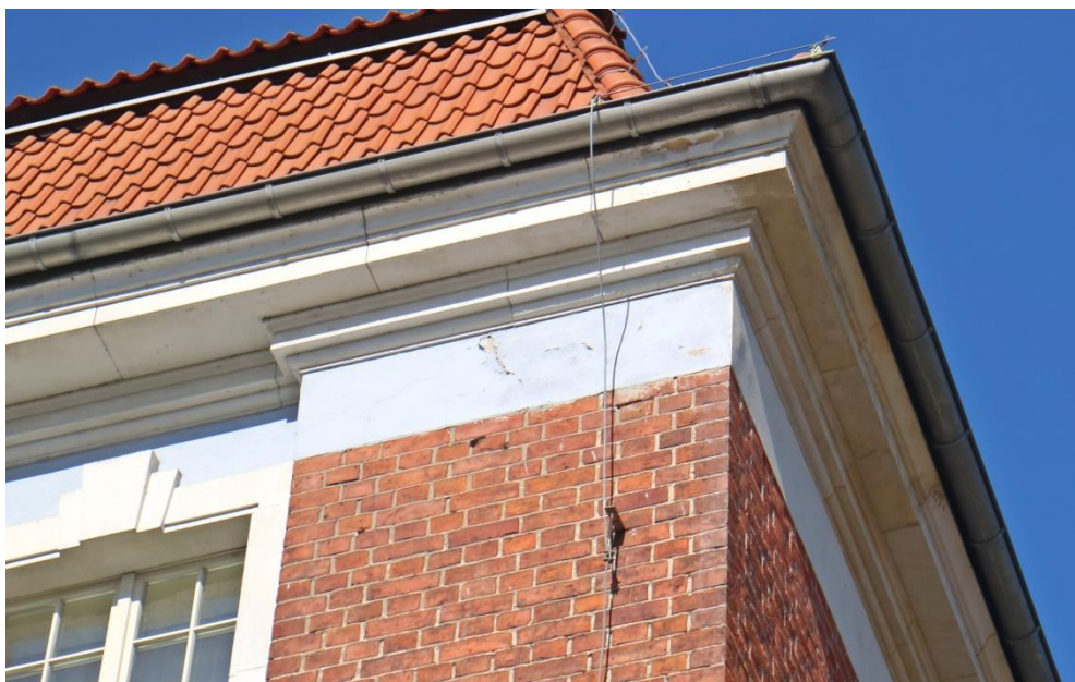
Widok partii pod okapami- złuszczenia po dawnych zawilgoceniach, widok fragmentu po konserwacji
