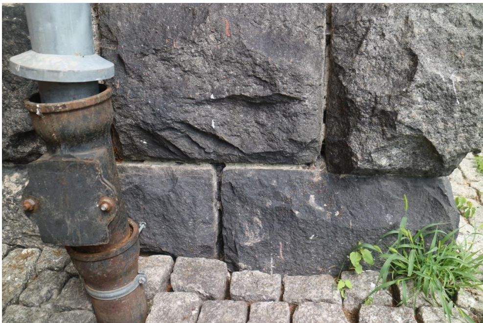
Wypłukane spoiny w przyziemiu
