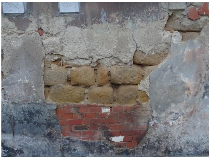
Fot. 5 Wietrzenie i ubytki tynków w przyziemiu elewacji frontowej.
