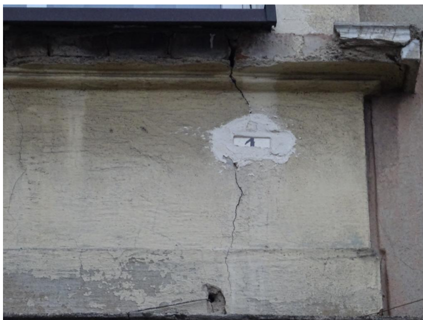
Fot. 2 Zarysowania między oknami widoczne na elewacji północno – wschodniej.
