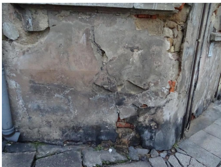
Fot. 7. Zarysowania w narożniku przyziemia elewacji frontowych.
