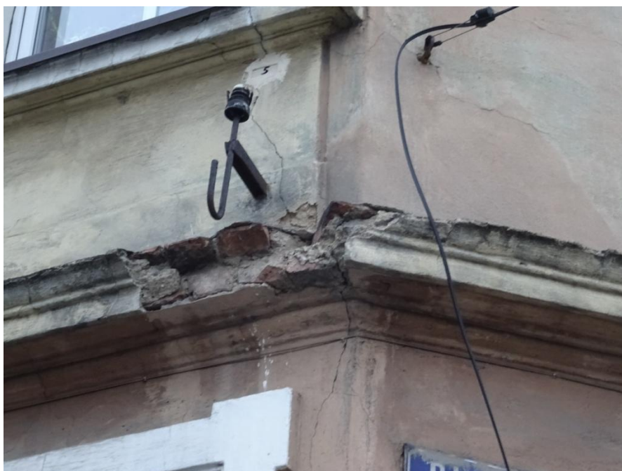
Fot. 4 Pęknięcia w narożniku elewacji południowej.
