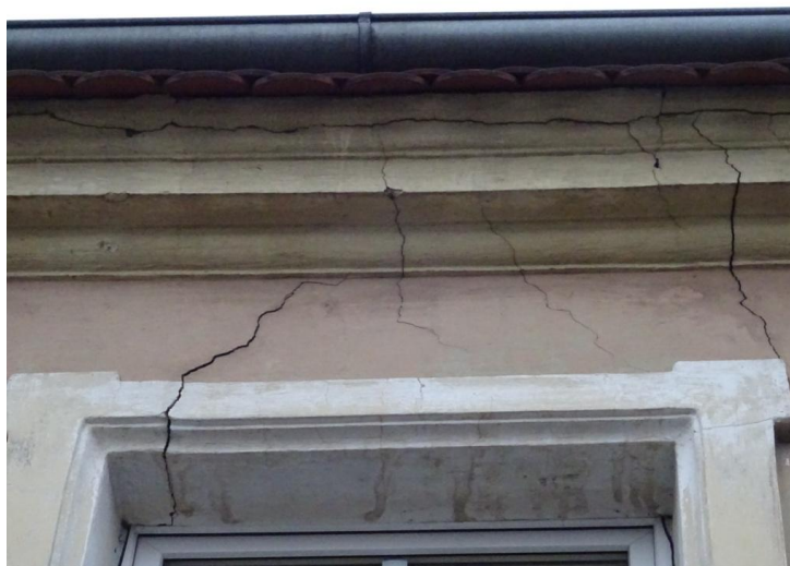
Fot. 6. Zarysowania nadproża, ściany i gzymsu nad oknem piętra el. północno - wschodniej
