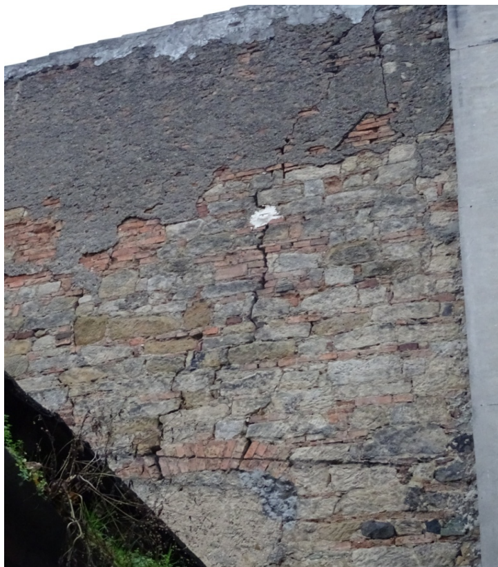
Fot.3 Pęknięcia widoczne na elewacji szczytowej – zachodniej.
