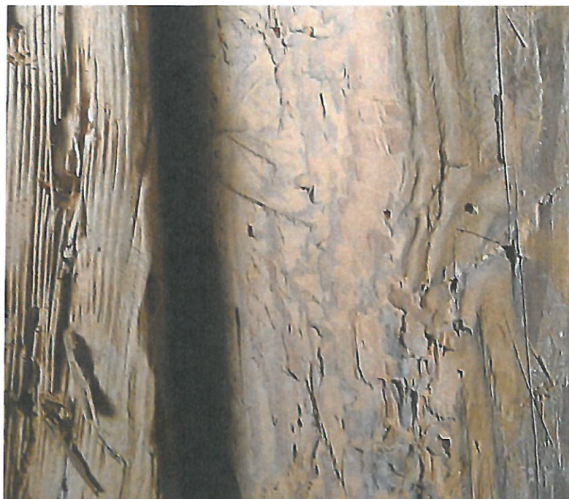
Fot.6. Powiększenie fragmentu fot.5 z widocznymi otworami wylotowymi owadów.
