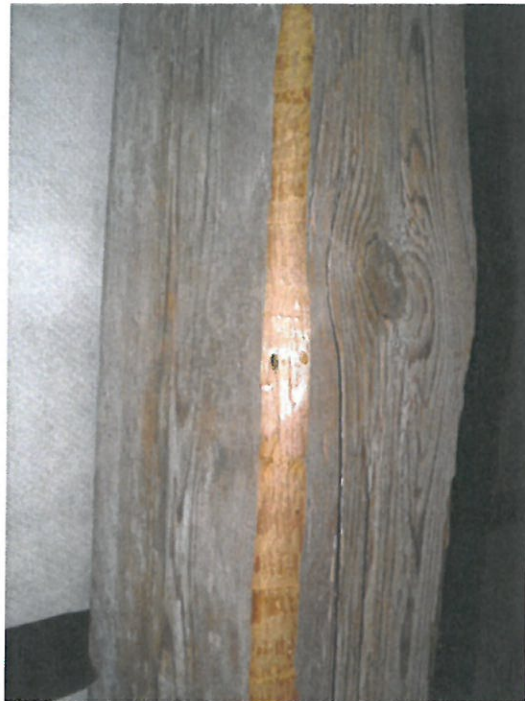
Fot.2. Widok przykładowej krokwi z widocznym otworem wylotowym spuszczela.
