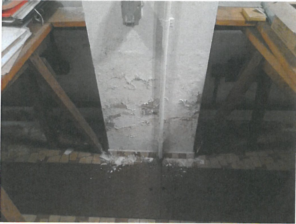
Fot.11. Widok dolnej części pilastra w ścianie zachodniej z objawami destrukcji wilgotnościowej.
