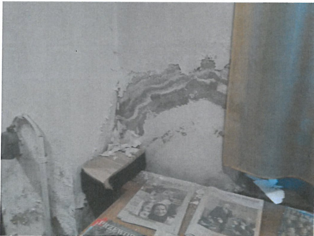
Fot.12. Widok dolnej części ściany z destrukcją wilgotnościową spowodowaną podciąganiem kapilarnym wody w wyniku braku izolacji poziomej.
