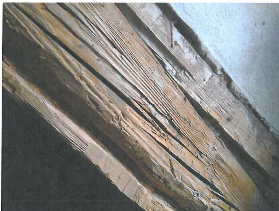
Fot.7. Przykładowy widok krokwi w połaci wschodniej. Widoczne spękania skurczowe drewna.
