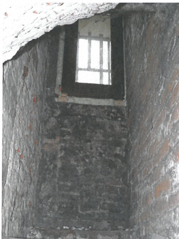
Fot. 14. Widok nieotynkowanej powierzchni wewnętrznej ściany zachodniej.
