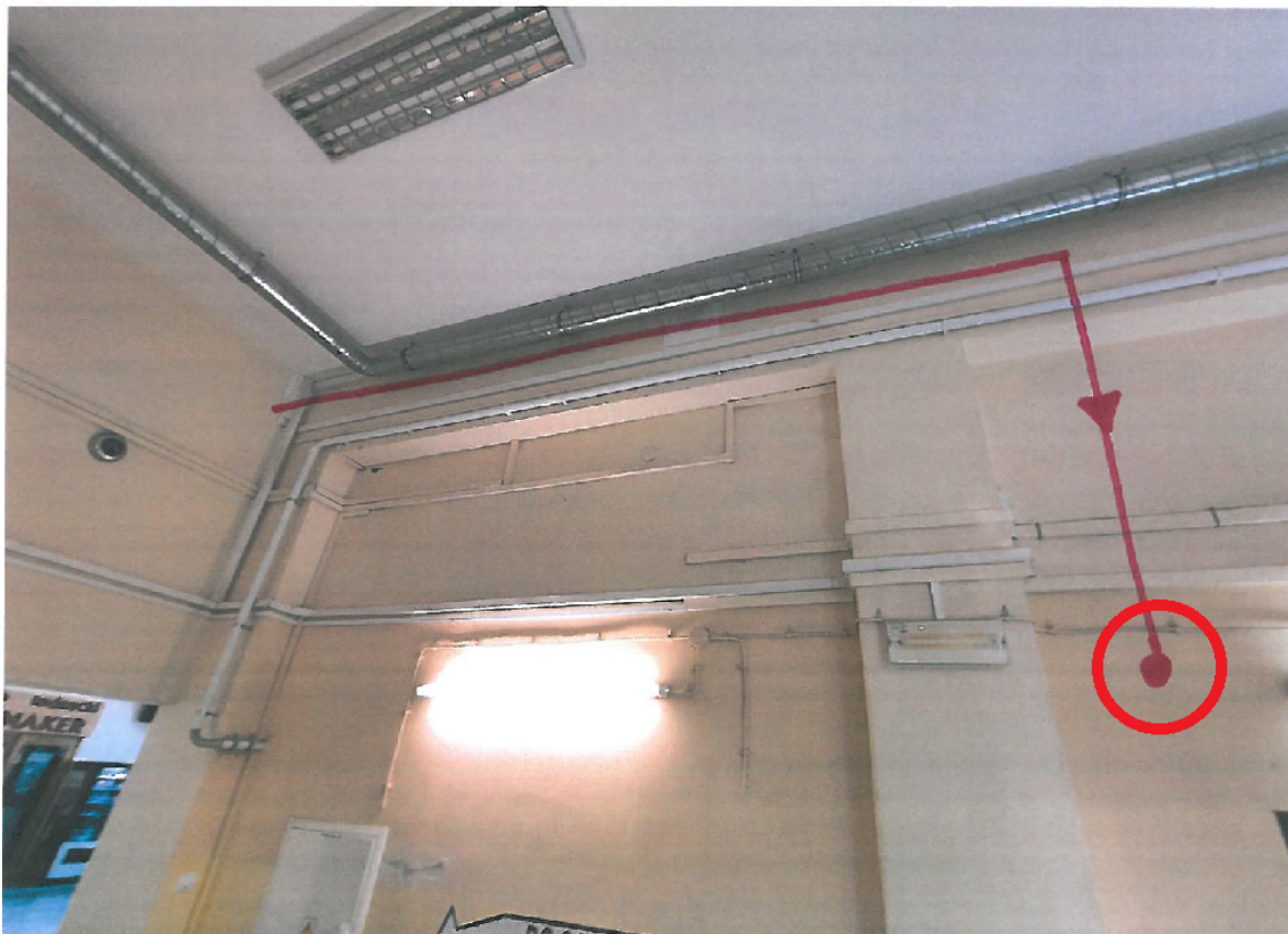
Rys. 12. Czerwoną linią oznaczono trasę kabla w bud. 5. Kółkiem oznaczono miejsce wprowadzenia kabla światłowodowego do pomieszczenia Oficera Dyżurnego.
