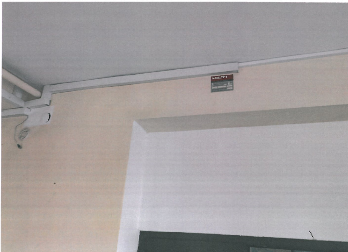
Rys. 8. Miejsce przejścia z przestrzeni nad sufitem podwieszanego do holu bez sufitu w bud. 5. Na fotografii widoczny podciąg. W dalszej części budynku nr 5 kabel układać należy w listwach instalacyjnych E90.
