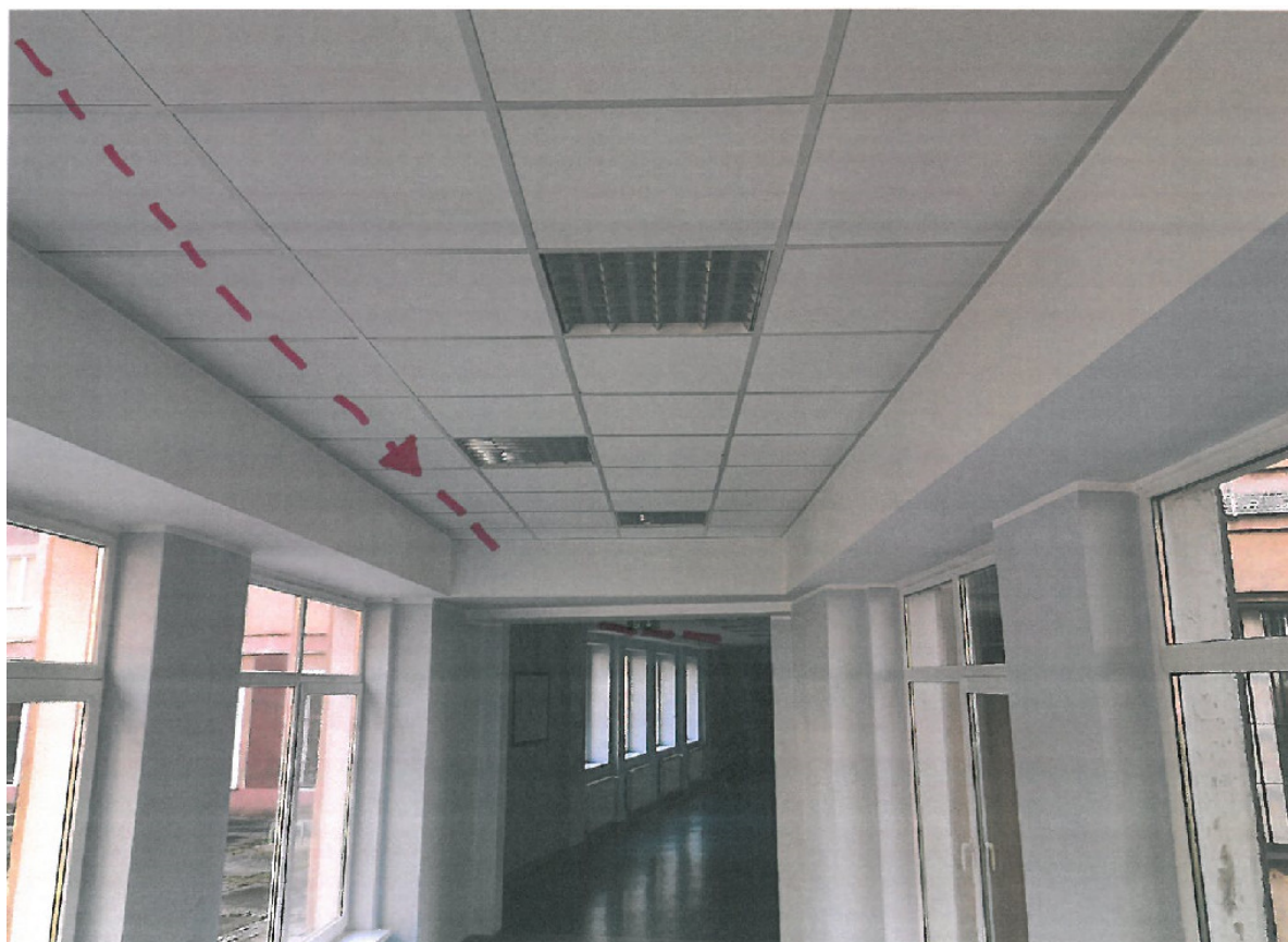
Rys. 6. Czerwoną linią oznaczono trasę kabla w łączniku, kabel prowadzony w przestrzeni sufitu podwieszanego.
