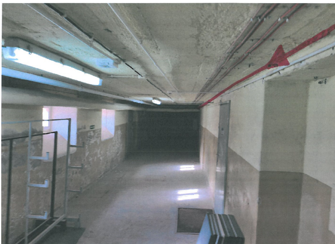
Rys. 3. Czerwoną strzałką oznaczono trasę kabla w korytarzach piwnicznych w bud. nr 10.
