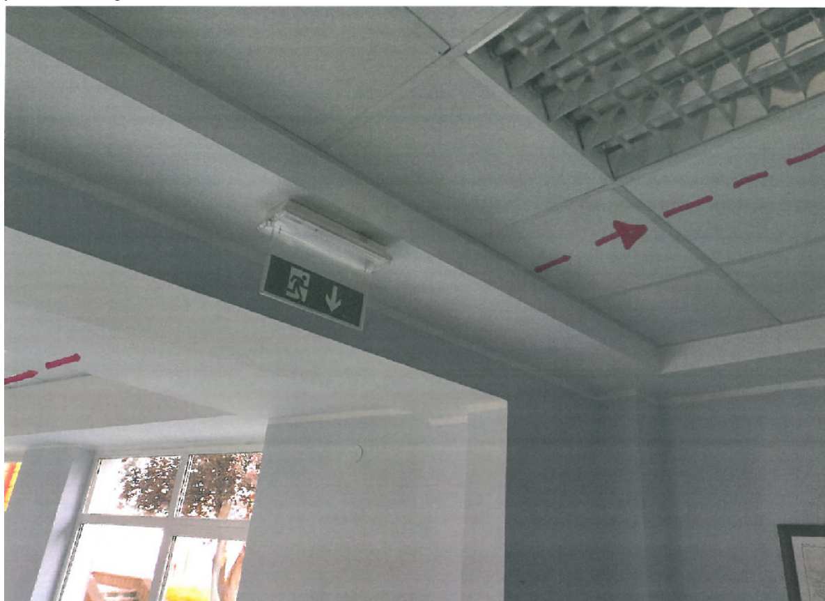
Rys. 7. Czerwoną linią oznaczono trasę kabla w łączniku, kabel prowadzony w przestrzeni sufitu podwieszanego. Na fotografii widoczny podciąg pomiędzy łącznikiem a budynkiem nr 5. W bud. 5 w holu kabel prowadzony w przestrzeni nad sufitem podwieszanym.
