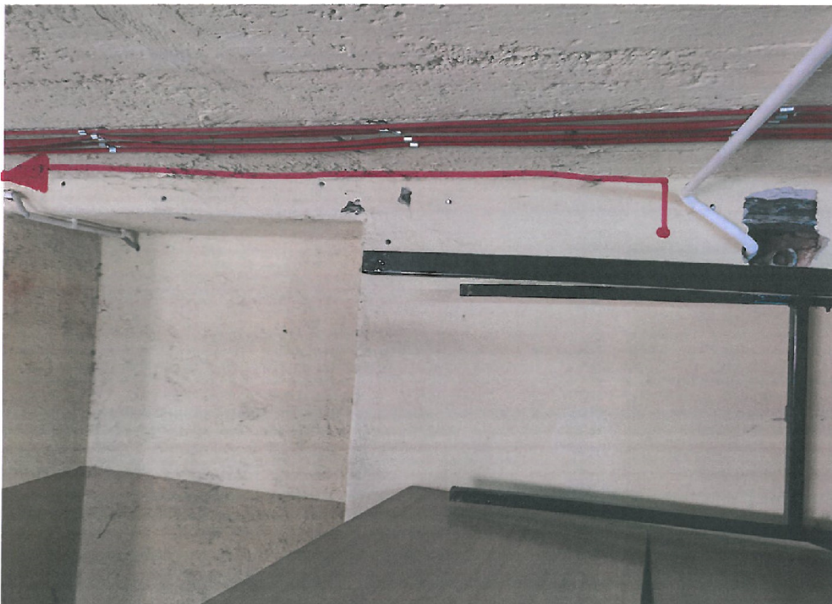
Rys. 2. Czerwoną strzałką oznaczono miejsce przejścia przez ścianę i trasę kabla na korytarzach piwnicznych.
