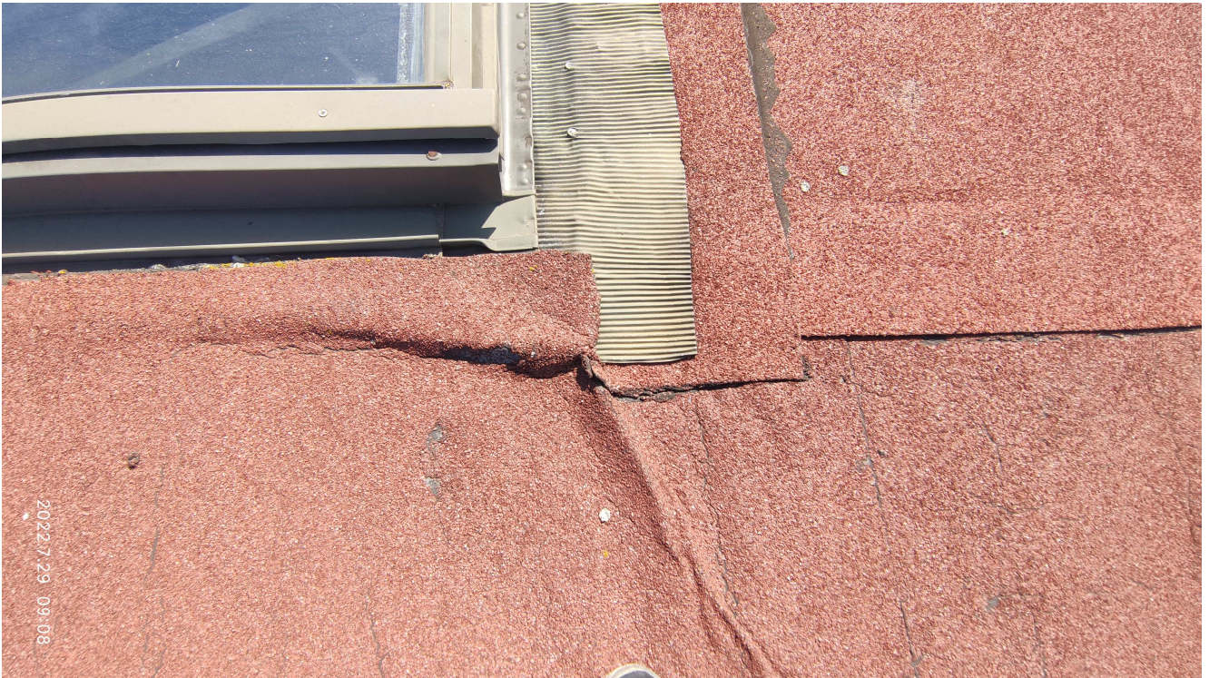
Pokrycie z papy – elementy papy zdeformowane rozwarstwiona warstwa bitumu i lepiszcza od wkładki z włókna szklanego, widoczny ślizg na wkładce warstwy wierzchniej. Błędnie wykonane obróbki okien na płaszczyźnie połaci dachu.
