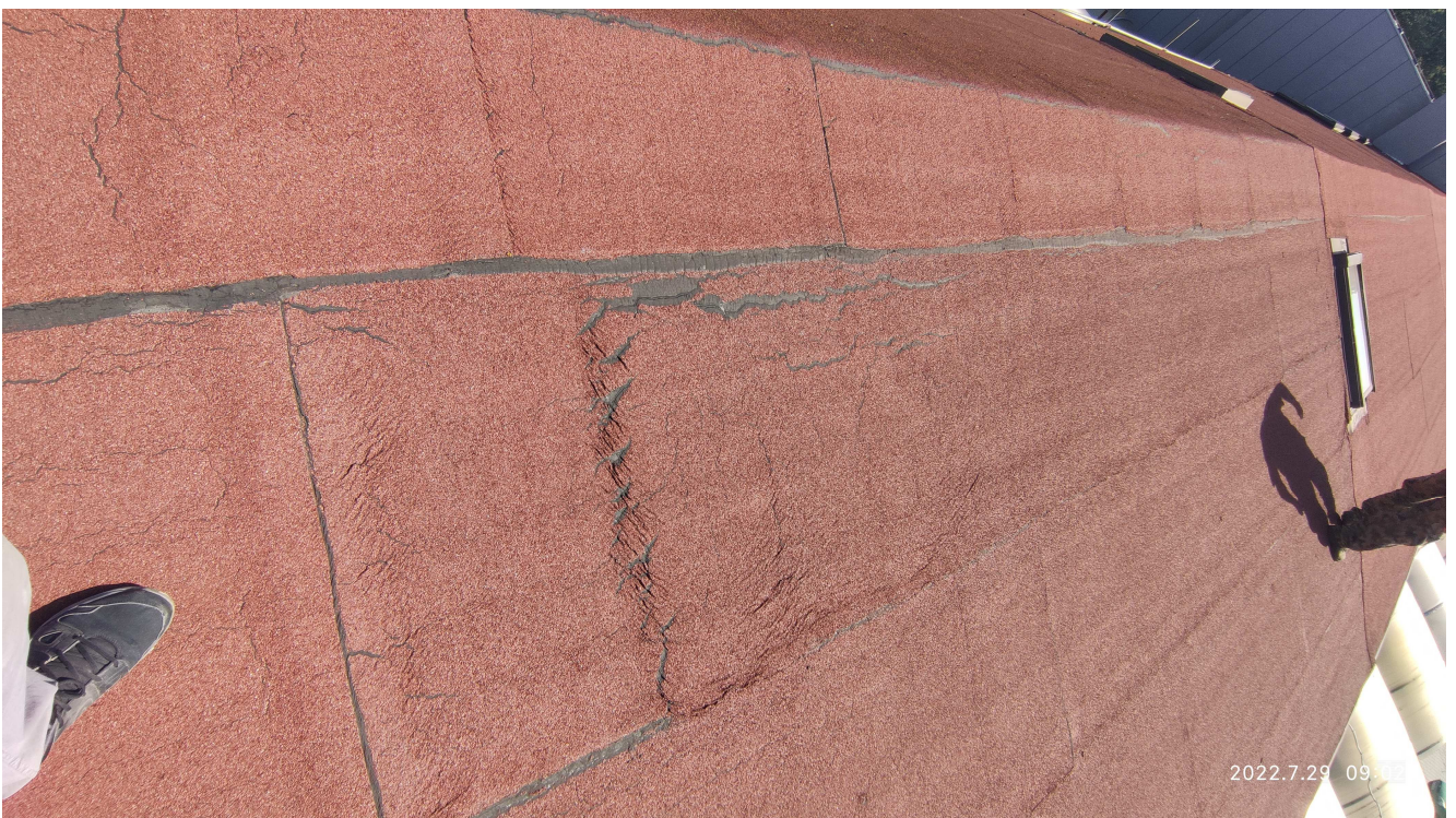
Pokrycie z papy – widoczny ślizg warstwy wierzchniej – papa wyjechała z pod górnej warstwy, całkowite uplastycznienie się bitumu, elementy papy zdeformowane rozwarstwiona warstwa bitumu i lepiuszcza od wkładki z włókna szklanego, widoczny ślizg na wkładce warstwy wierzchniej
