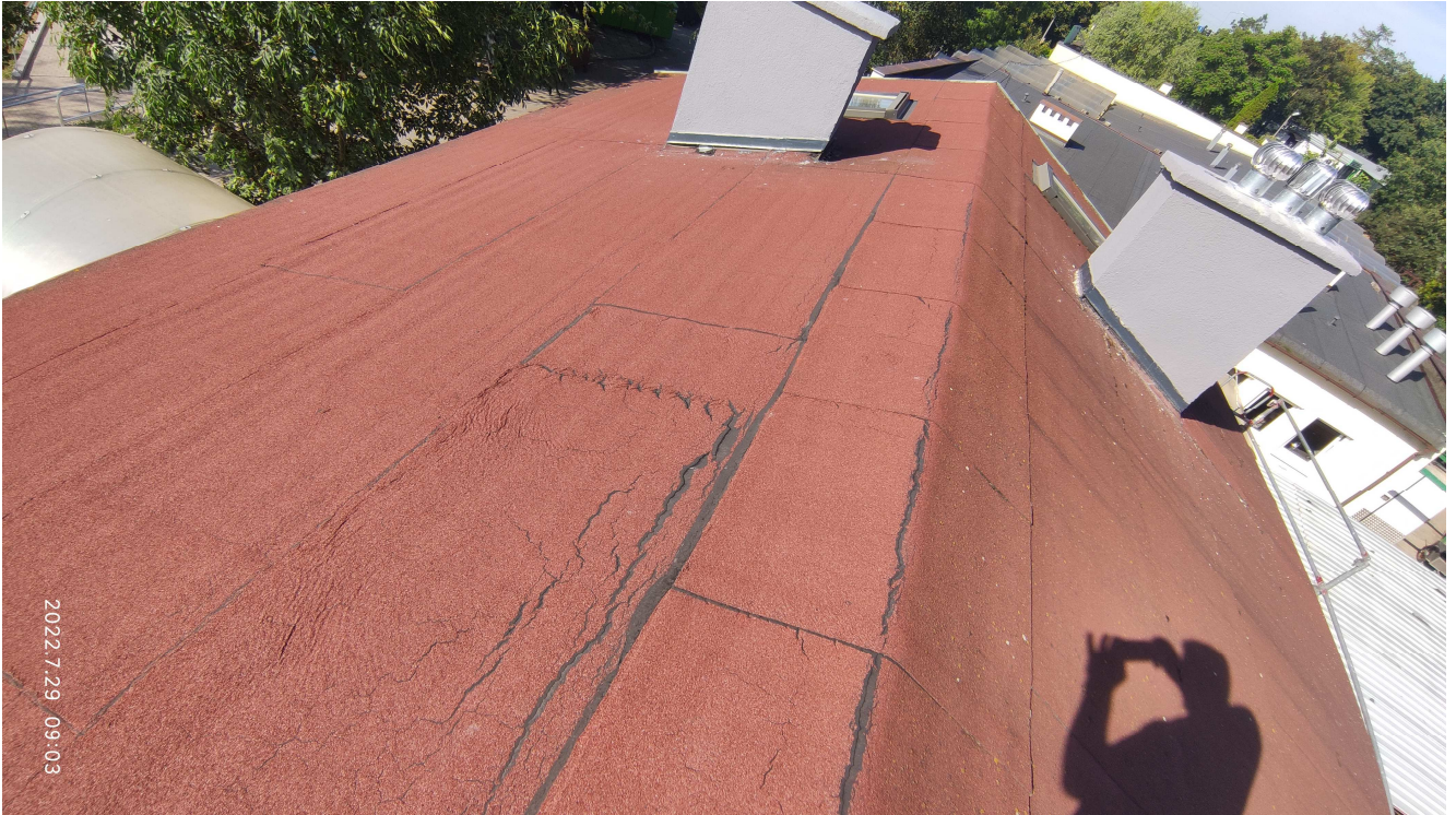
Pokrycie z papy – widoczny ślizg warstwy wierzchniej – papa wyjechała z pod górnej warstwy, całkowite uplastycznienie się bitumu, elementy papy zdeformowane rozwarstwiona warstwa bitumu i lepiszcza od wkładki z włókna szklanego, widoczny ślizg na wkładce warstwy wierzchniej
