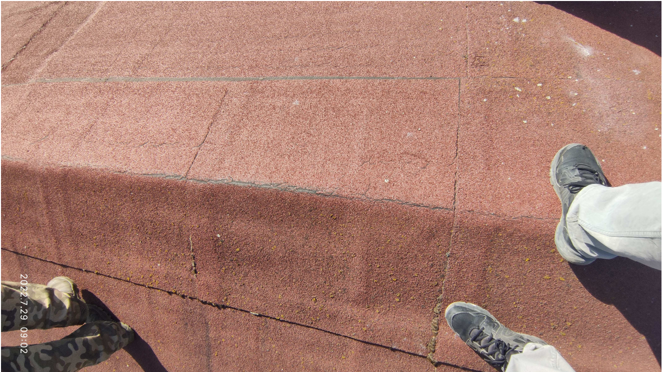
Pokrycie z papy – elementy papy zdeformowane rozwarstwiona warstwa bitumu i lepiuszcza od wkładki z włókna szklanego, widoczny ślizg na wkładce warstwy wierzchniej
