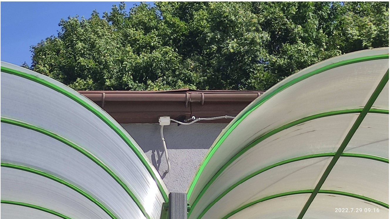
Widoczne rozwarstwienie papy na łączeniu a także uszkodzenia rynien PVC.
