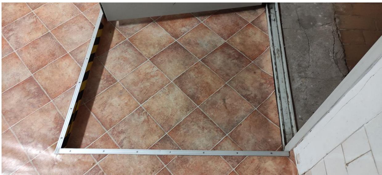
Fot. 4 Pomieszczenie gospodarcze – uskok w posadzce przy wejściu
