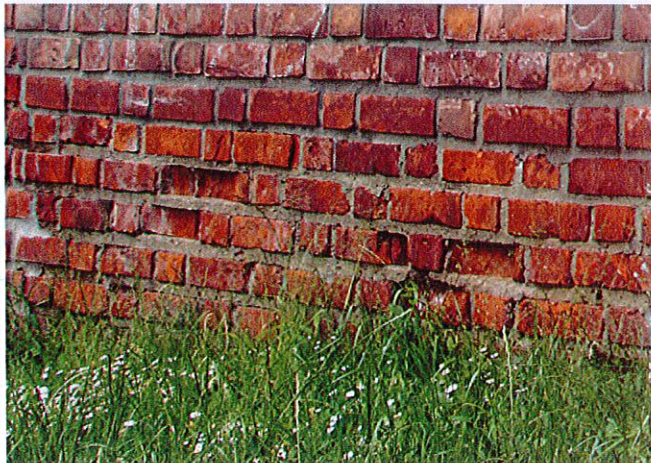
Fot. 3. – lokalne zawilgocenie, wykwity, uszkodzenia mrozowe cegieł, miejscowe osłabienie i ubytki w spoinowaniu
