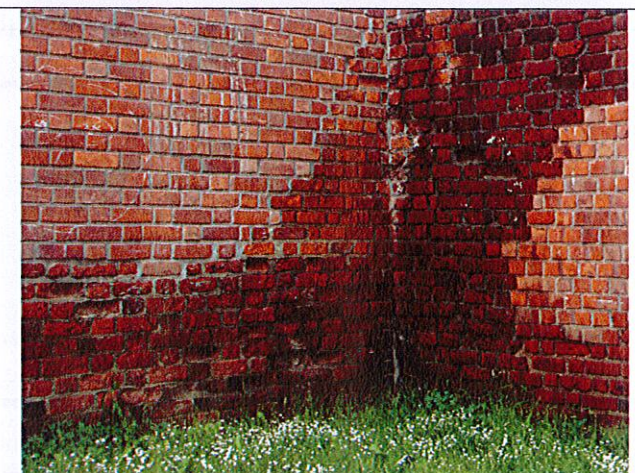
Fot. 6. – lokalne zawilgocenie, wykwity, uszkodzenia mrozowe cegieł, miejscowe osłabienie i ubytki w spoinowaniu
