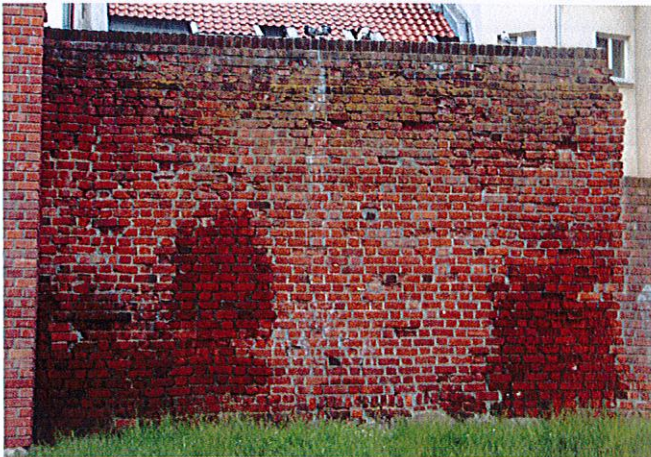
Fot. 1. – lokalne zawilgocenie, wykwity, uszkodzenia mrozowe cegieł, miejscowe osłabienie i ubytki w spoinowaniu
