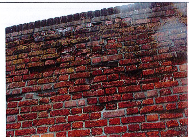
Fot. 5. – lokalne zawilgocenie, wykwity, uszkodzenia mrozowe cegieł, miejscowe osłabienie i ubytki w spoinowaniu
