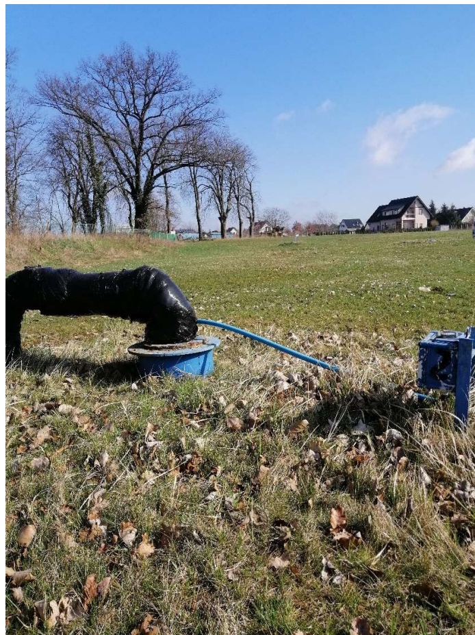
Studnia głębinowa nr 2 na dz. nr 33
