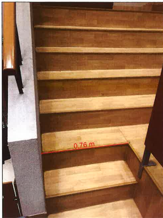
Fotografia 3 Zawężona szerokość drogi ewakuacyjnej w pomieszczeniu sali seminaryjnej (2.41) do 0,76 m
