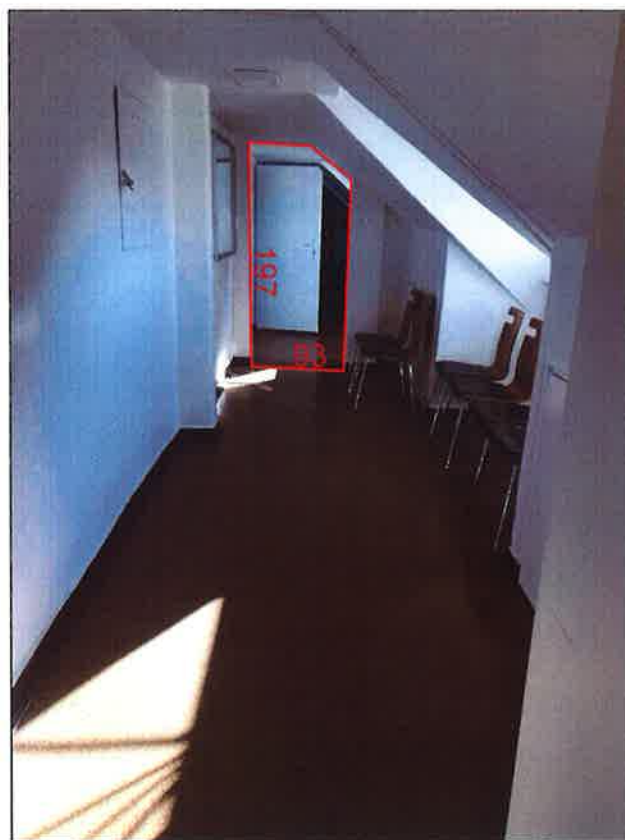
Fotografia 2 Zaniżona i zawężona szerokość dojść ewakuacyjnych na kondygnacji IV piętra
