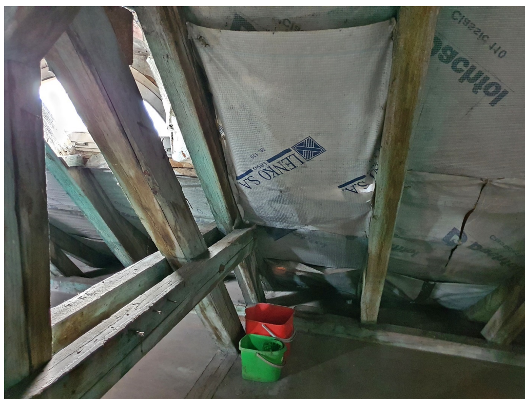
Fot. 2; nieszczelności i łatana folia od str. południowej;
