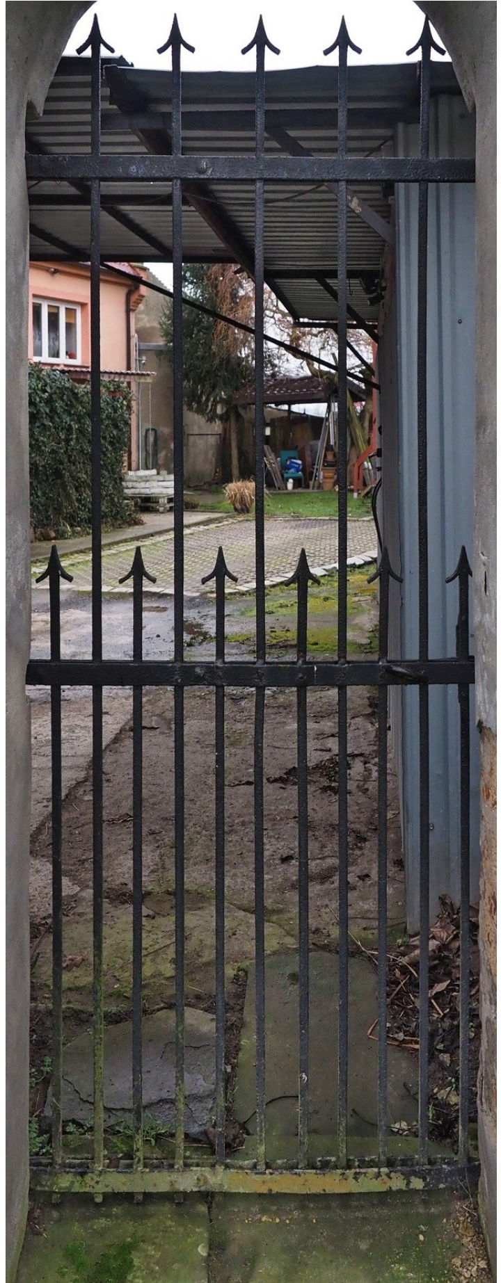
Fot. 42, 43. Stan zachowania kraty bramy zachodniej. Na zdjęciu po lewej przykład miejsca złuszczenia się powłok malarskich z widocznym układem stratygraficznym
