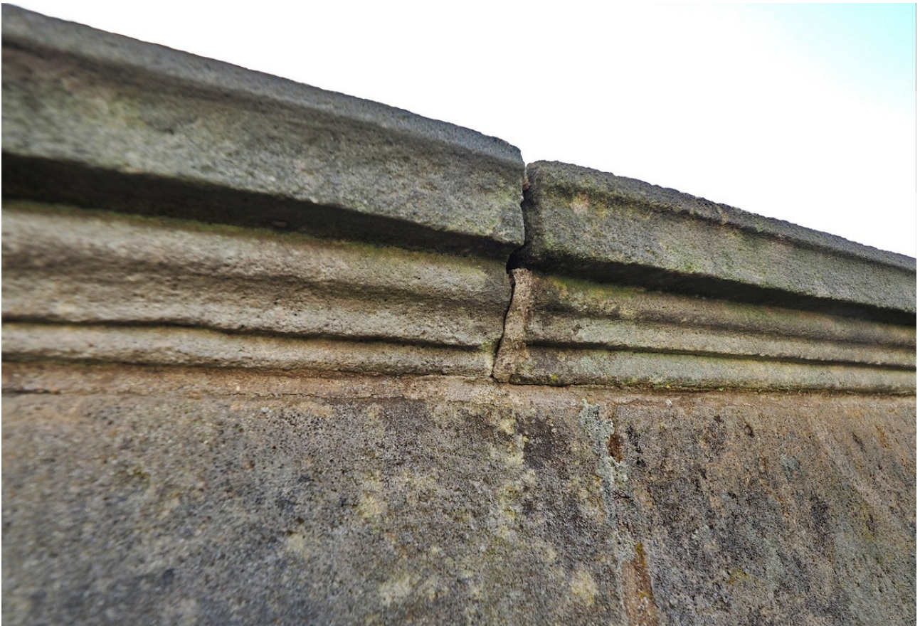
Fot. 24, 25. Stan zachowania kamieniarki piaskowcowej południowej części muru: od strony kościoła.
