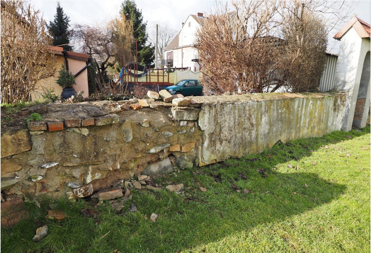
Fot. 40. Rozpadająca się partia muru – przykład z części zachodniej.
