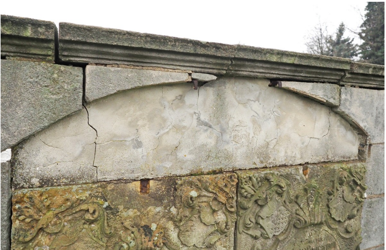
Fot. 27. Stan zachowania kamieniarki i tynku nad epitafiami w centralnej części muru południowego.
