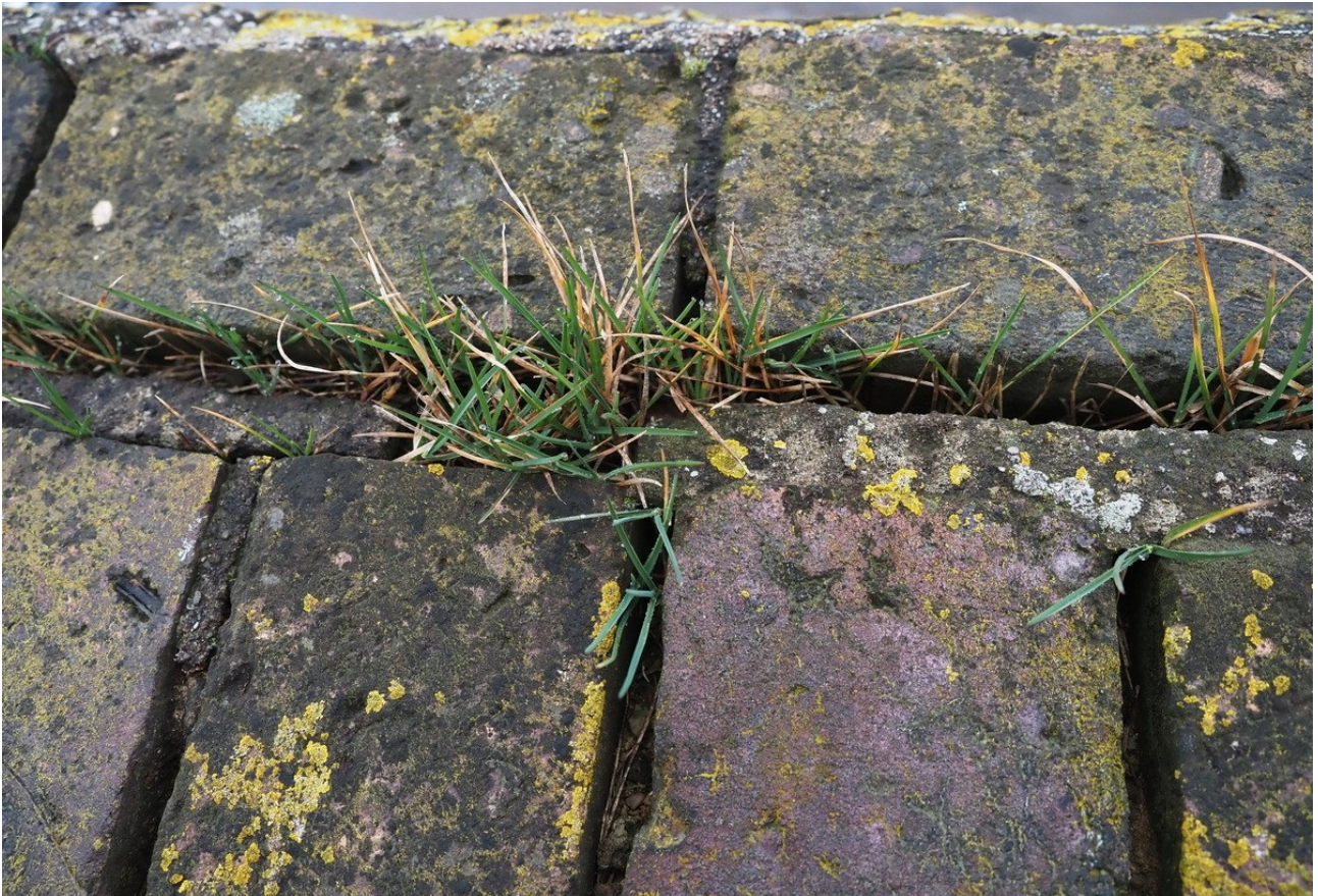
Fot. 19, 20. Stan zachowania ceglanej nakrywy na wschodniej części muru.
