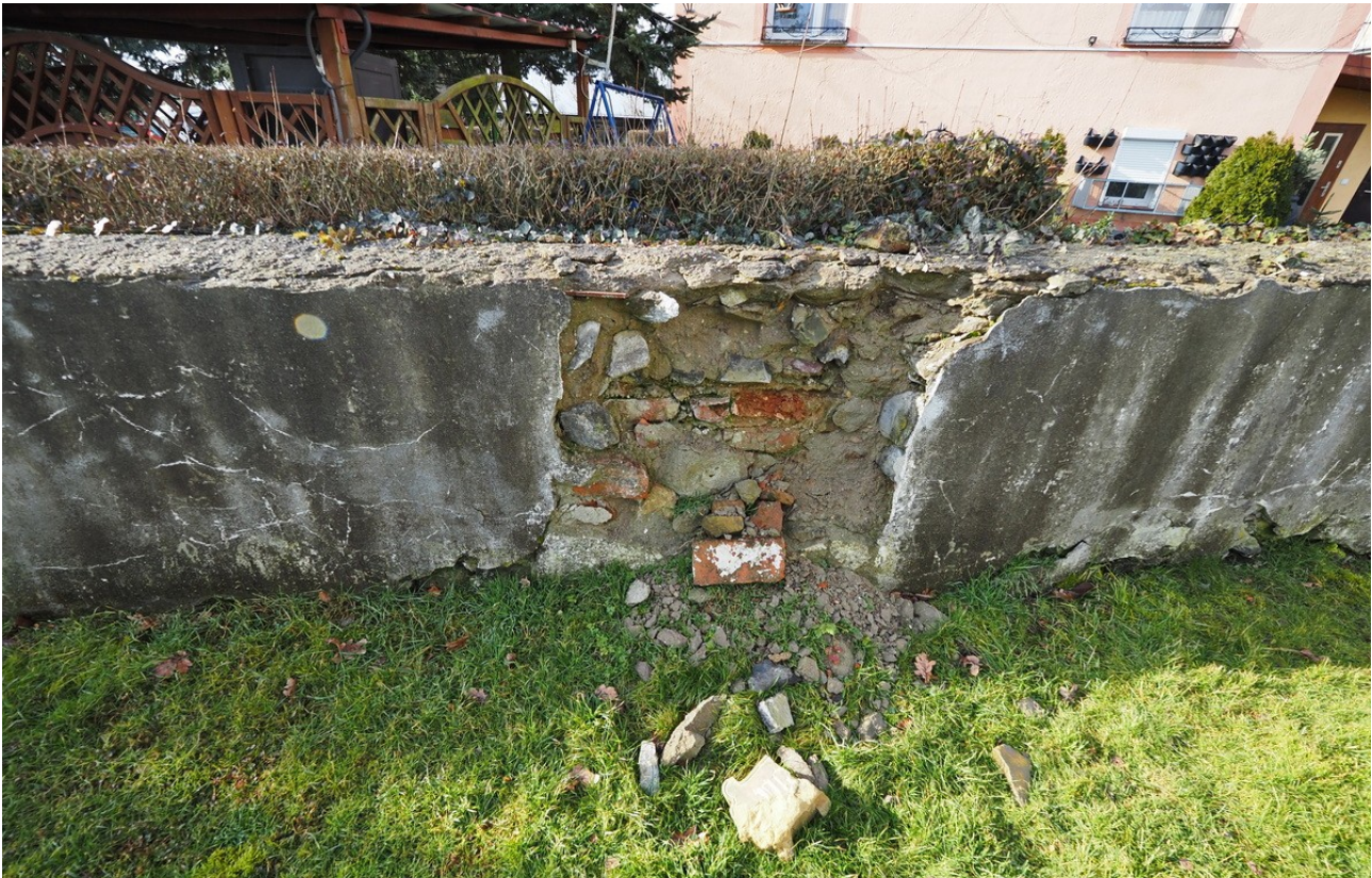
Fot. 38. Rozpadająca się partia muru – przykład z części zachodniej.
