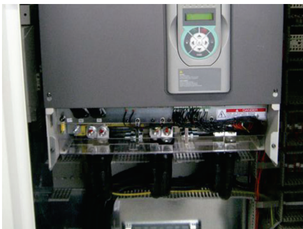
140 Widok przekształtnika (szafa rozdzielcza) bez pokrywa
