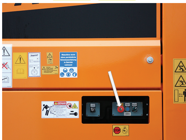
44 Zatrzymanie awaryjne na skrzynce rozdzielczej, z przodu z prawej strony
