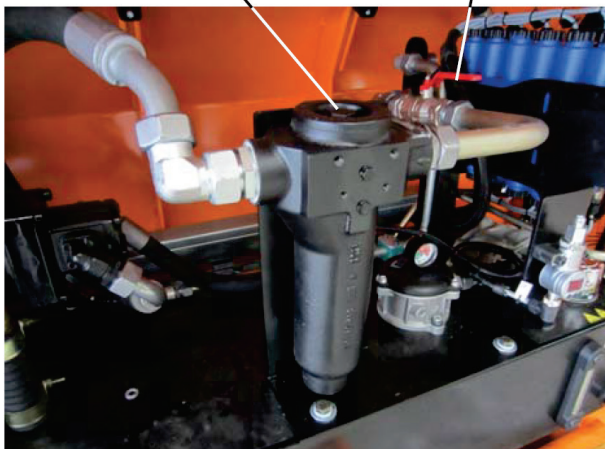
131 Obudowa filtra na agregacie hydraulicznym
