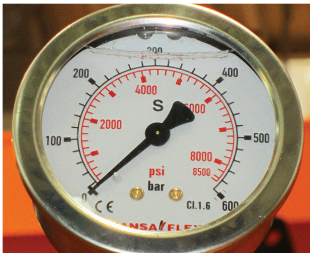
18 Manometr ciśnieniowy, agregat hydrauliczny
