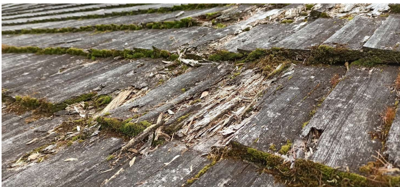
Fot. 9,10 Zbliżenie na pokrycie dachowe budynku Dworu – zły stan techniczny gontu.
