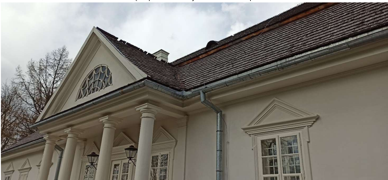
Fot.14 Widoczne ubytki gontu na kalenicy portyku elewacji frontowej
