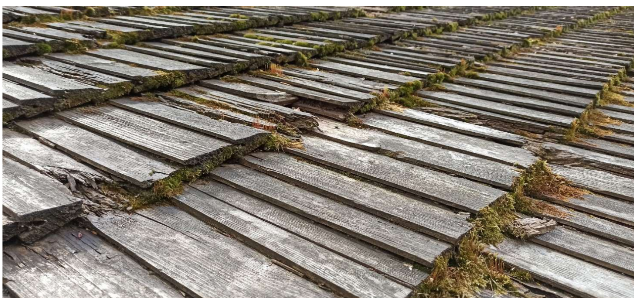
Fot. 7,8 Zbliżenie na pokrycie dachowe wirydarza – zły stan techniczny gontu.
