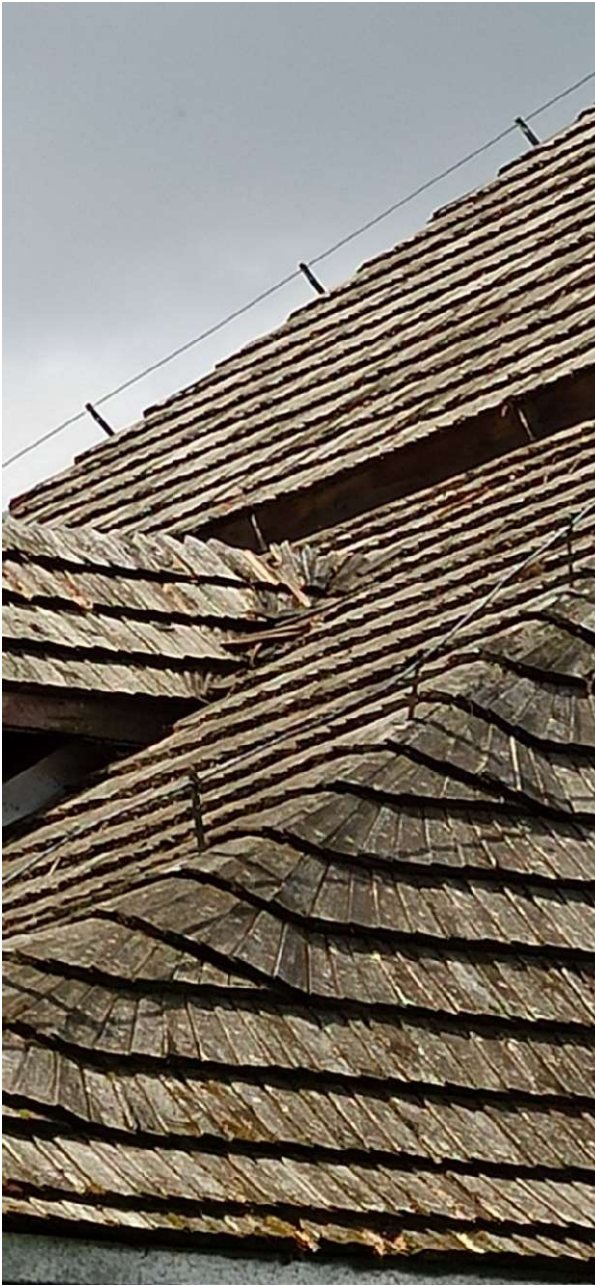
Fot. 4 Widoczne ubytki pokrycia przy „wolim oczku” połaci frontowej
