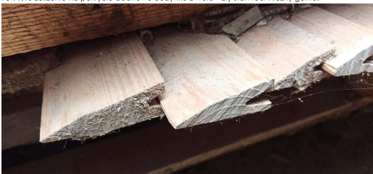
Fot. 11 Deszczutki widoczne od wnętrza budynku – gont surowy
