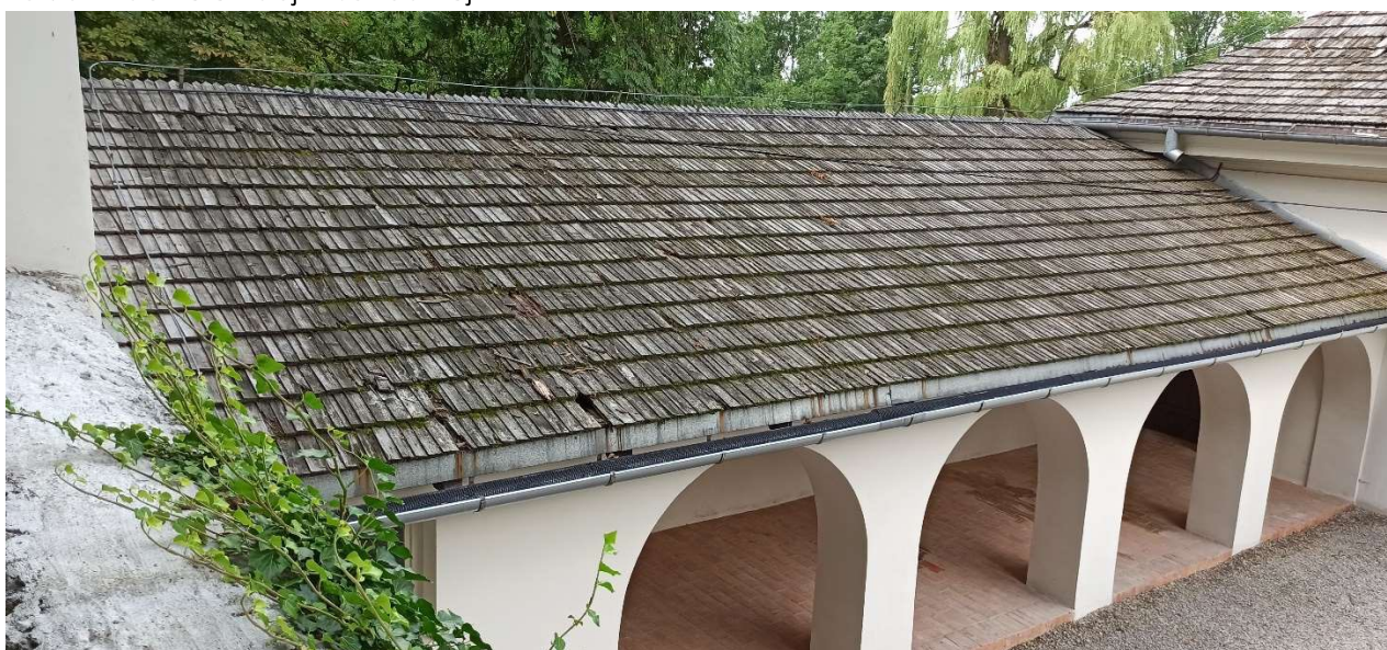
Fot. 6 Dach wirydarza – widoczne znaczne ubytki w pokryciu dachowym
