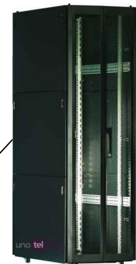
GTS - skrzynka typu RACK w piwnicy obok RG
