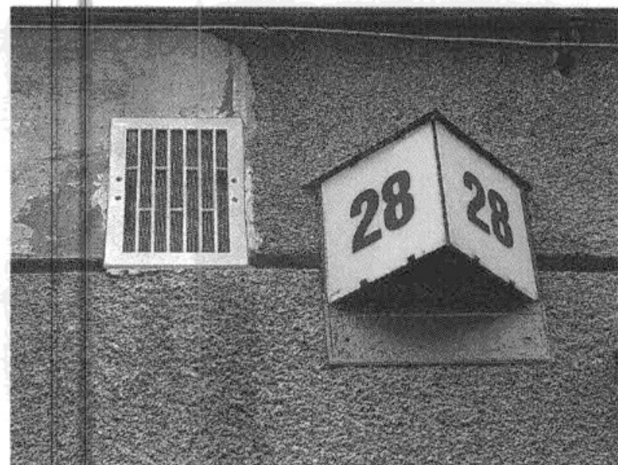
fot. 3: Wtórny otwór wentylacyjny, zachodzący na detal sztyldu i skrzynka z numerem budynku
