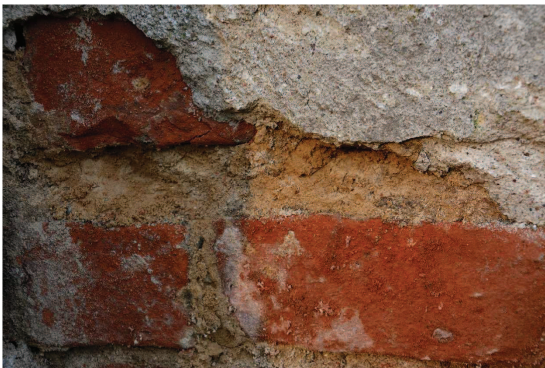
Fot. 2 Zabudowania pocysterskiego klasztoru w Owińskach. Ośrodek Szkolno- Wychowawczy dla Dzieci Niewidomych. Mur graniczny od strony ul. Poznańskiej. Odkrywka sondażowa z widocznymi wysoleniami oraz silnie spudrowanym licem cegły.
