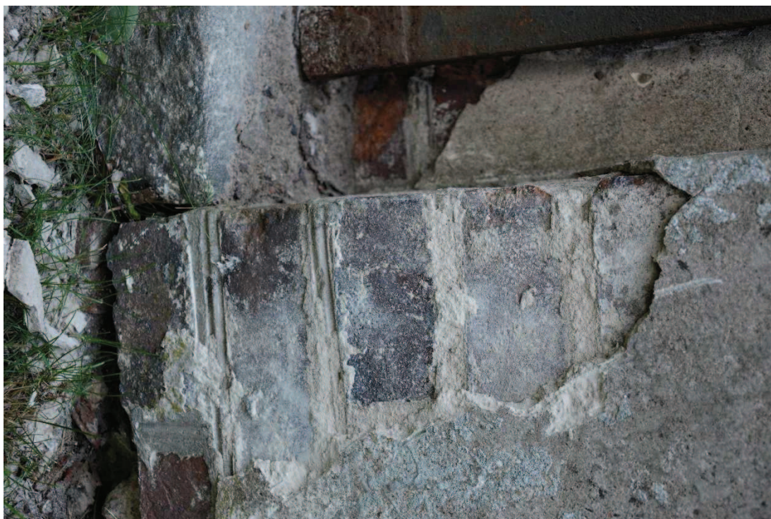
Fot. 5 Zabudowania pocysterskiego klasztoru w Owińskach. Ośrodek Szkolno- Wychowawczy dla Dzieci Niewidomych. Mur graniczny od strony ul. Poznańskiej. Wtórnie wykonany otwór przejściowy. Widok od strony zewnętrznej. Widoczne rozwarstwienie muru jak również ślady niekorzystnego oddziaływania wilgoci.
