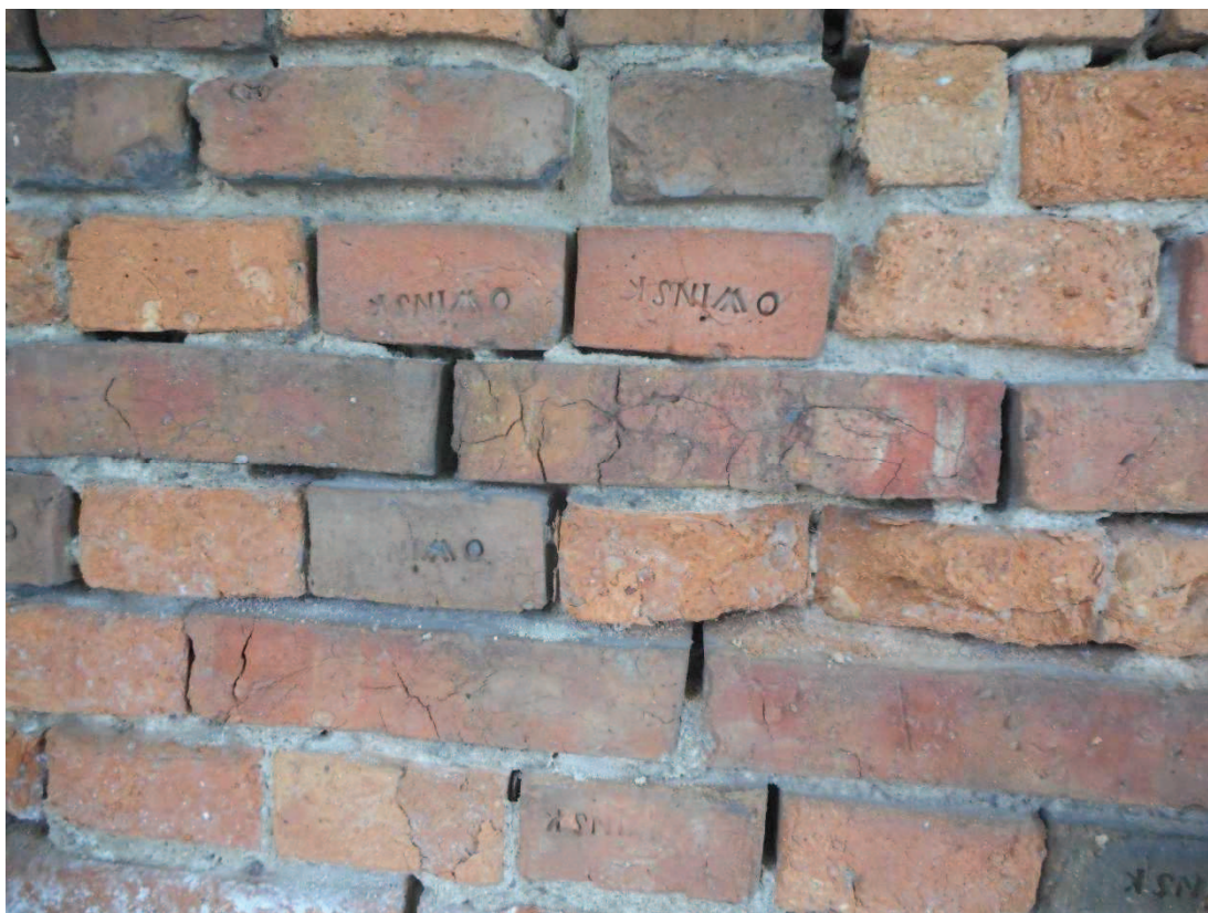
Fot. 9 Zabudowania pocysterskiego klasztoru w Owińskach. Ośrodek Szkolno- Wychowawczy dla Dzieci Niewidomych. Mur graniczny od strony ul. Cysterek. Na zdjęciu widoczne liczne ubytki spoiny oraz odcisk cegielni „Owinsk” świadczące o ich pochodzeniu.
