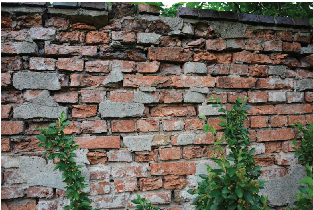
Fot. 1 Zabudowania pocysterskiego klasztoru w Owińskach. Ośrodek Szkolno- Wychowawczy dla Dzieci Niewidomych. Mur graniczny od strony ul. Poznańskiej. Fragment z daleko posuniętą destrukcją wypełnienia ceramicznego oraz zaprawy.
