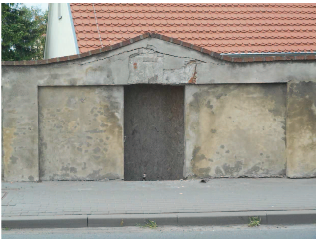
Fot. 6 Zabudowania pocysterskiego klasztoru w Owińskach. Ośrodek Szkolno- Wychowawczy dla Dzieci Niewidomych. Mur graniczny od strony ul. Cysterek. Widok od strony wewnętrznej. Odkrywkowa sondażowa z widoczną bardzo związłą warstwą zaprawy cementowej.
