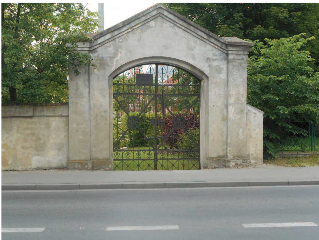
Fot. 4 Zabudowania pocysterskiego klasztoru w Owińskach. Ośrodek Szkolno- Wychowawczy dla Dzieci Niewidomych. Mur graniczny od strony ul. Poznańskiej. Brama wjazdowa. Widok od strony zewnętrznej. Widoczne liczne spękania oraz odspojenia wyprawy tynkarskiej oraz niefachowo wykonanych uzupełnień metaloplastyki.
