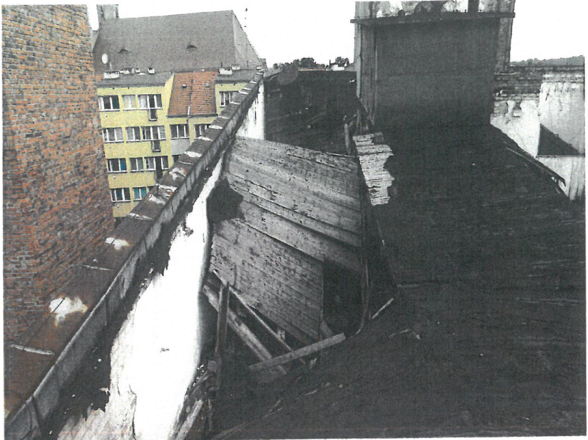
Widok stropodachu w postępującej degradacji.
