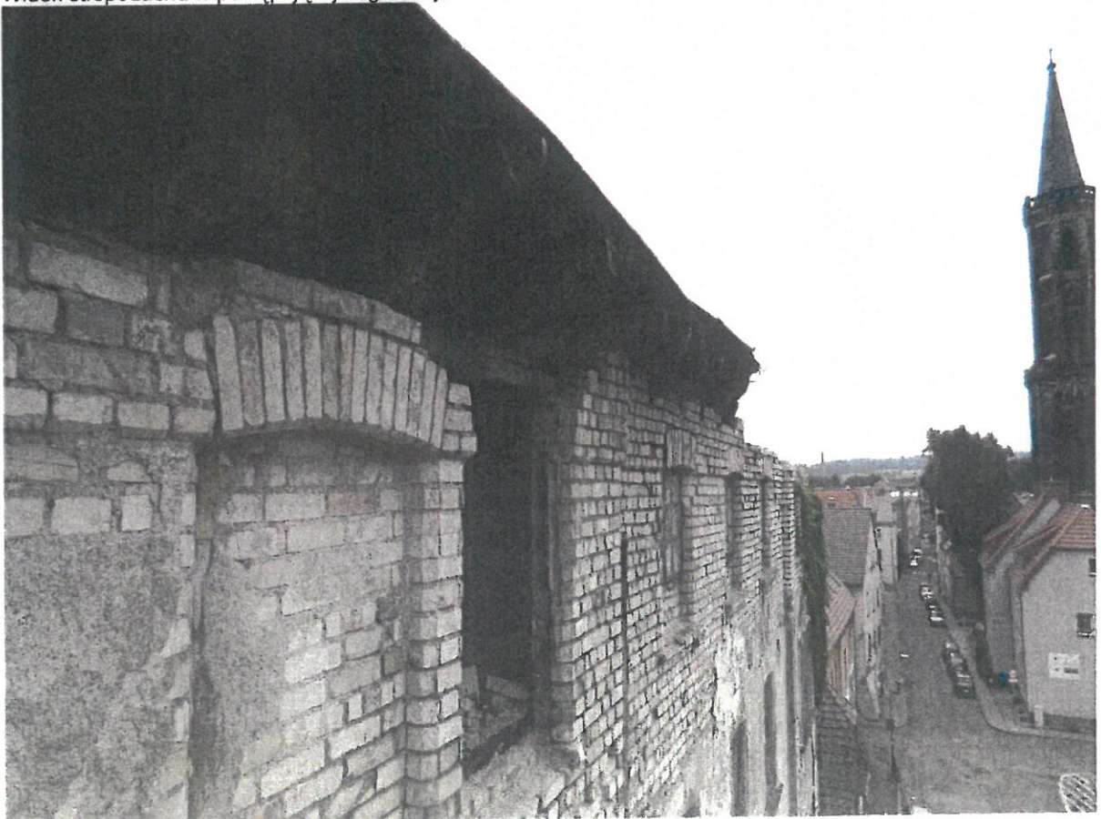
Zagrożenie wyparcia muru (strona południowa) przez elementy stropodachu.
