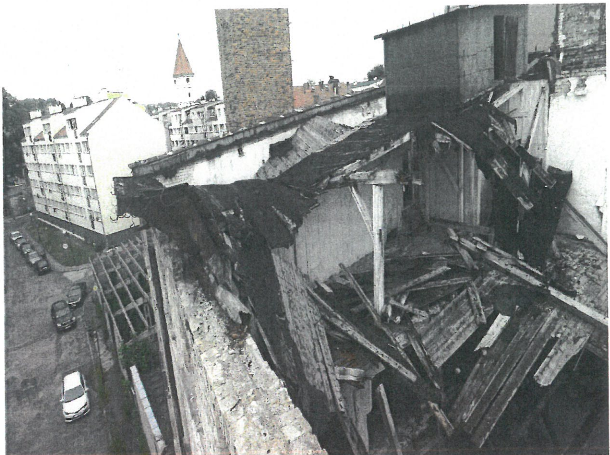
Widok stropodachu i stropów międzykondygnacyjnych w postępującej degradacji.
