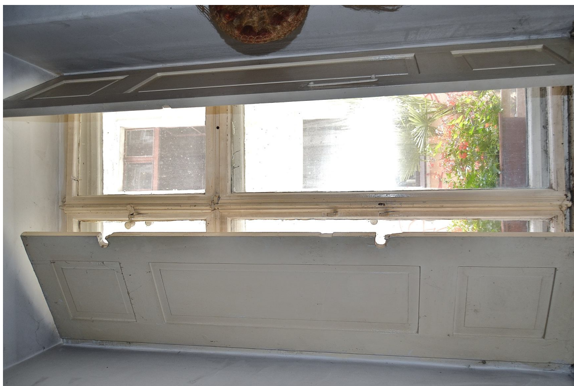
II. 6 Grudziądz, Kamienica przy ul. Pańskiej 2/ ul. Reja 1- elewacja północna (parter) - stolarka TYP O/IA – widok na pierwotną stolarkę okienną - rewers
