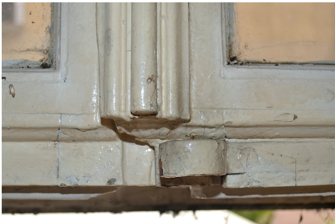
Il. 20 Grudziądz, Kamienica przy ul. Pańskiej 2/ ul. Reja 1- elewacja północna (parter) - pierwotna stolarka TYP O/IA – widok na fragment uszkodzonej zawrotnicy oraz hak fot. Ewa Bożejewicz 2018 r.
