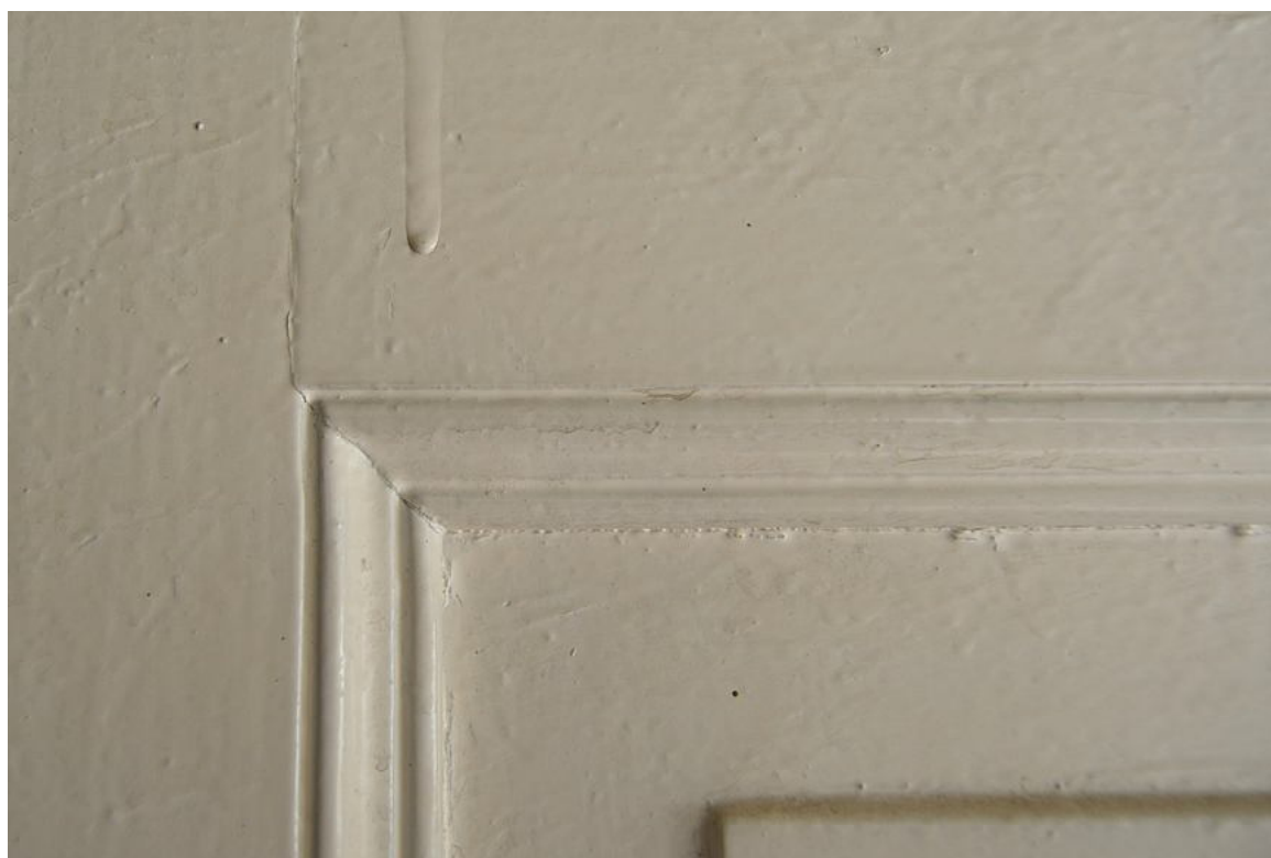
Il. 24 Grudziądz, Kamienica przy ul. Pańskiej 2/ ul. Reja 1- elewacja północna (parter) - pierwotna stolarka TYP O/IA – widok na profilowanie ramiaka okiennicy
