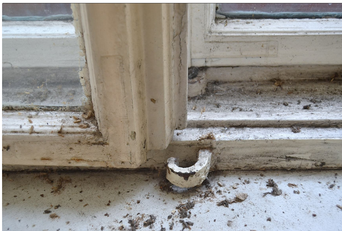
Il. 16 Grudziądz, Kamienica przy ul. Pańskiej 2/ ul. Reja 1- elewacja północna (parter) - pierwotna stolarka TYP O/IA – widok na próg skrzynki, skrzydło oraz hak zawrotnicy
