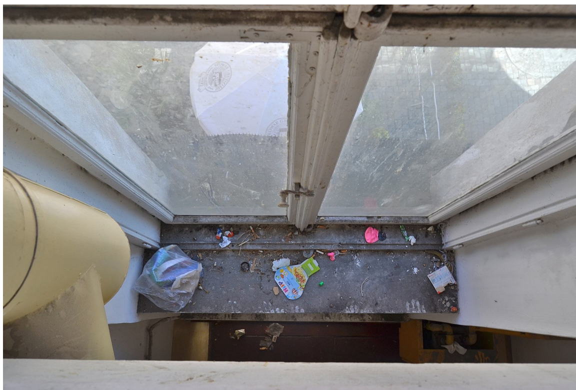
Il. 33 Grudziądz, Kamienica przy ul. Pańskiej 2/ ul. Reja 1- elewacja północna (klatka schodowa) - pierwotna stolarka TYP O/IB – widok na skrzydła zew., parapet oraz ościeżnicę ze zdemontowanymi skrzydłami wew. fot. Ewa Bożejewicz 2018 r.
