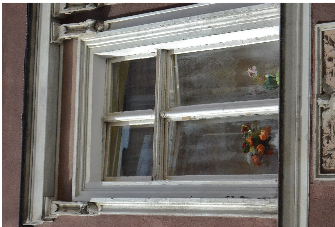
Il. 29 Grudziądz, Kamienica przy ul. Pańskiej 2/ ul. Reja 1- elewacja północna (I i II piętro) - stolarka TYP O/IB – pierwotna stolarka okienna - awers
