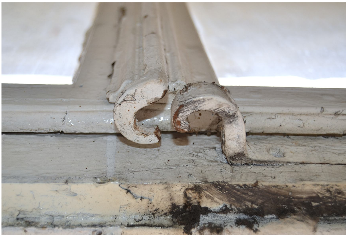
Il. 21 Grudziądz, Kamienica przy ul. Pańskiej 2/ ul. Reja 1- elewacja północna (parter) - pierwotna stolarka TYP O/IA – widok na haki zawrotnicy
