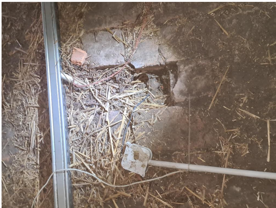
Rys. 45 Uszkodzona powierzchnia stropu kolebkowego.
