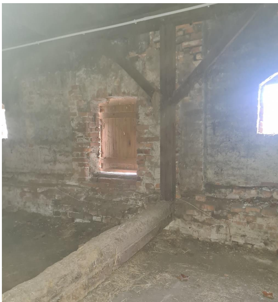
Rys. 48 Brak rozpór w ramie drewnianej.
