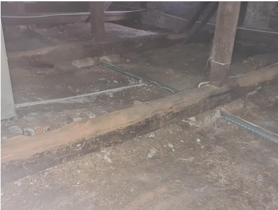
Rys. 40 Belka podwalinowa w środku rozpiętości uległa korozji biologicznej.
