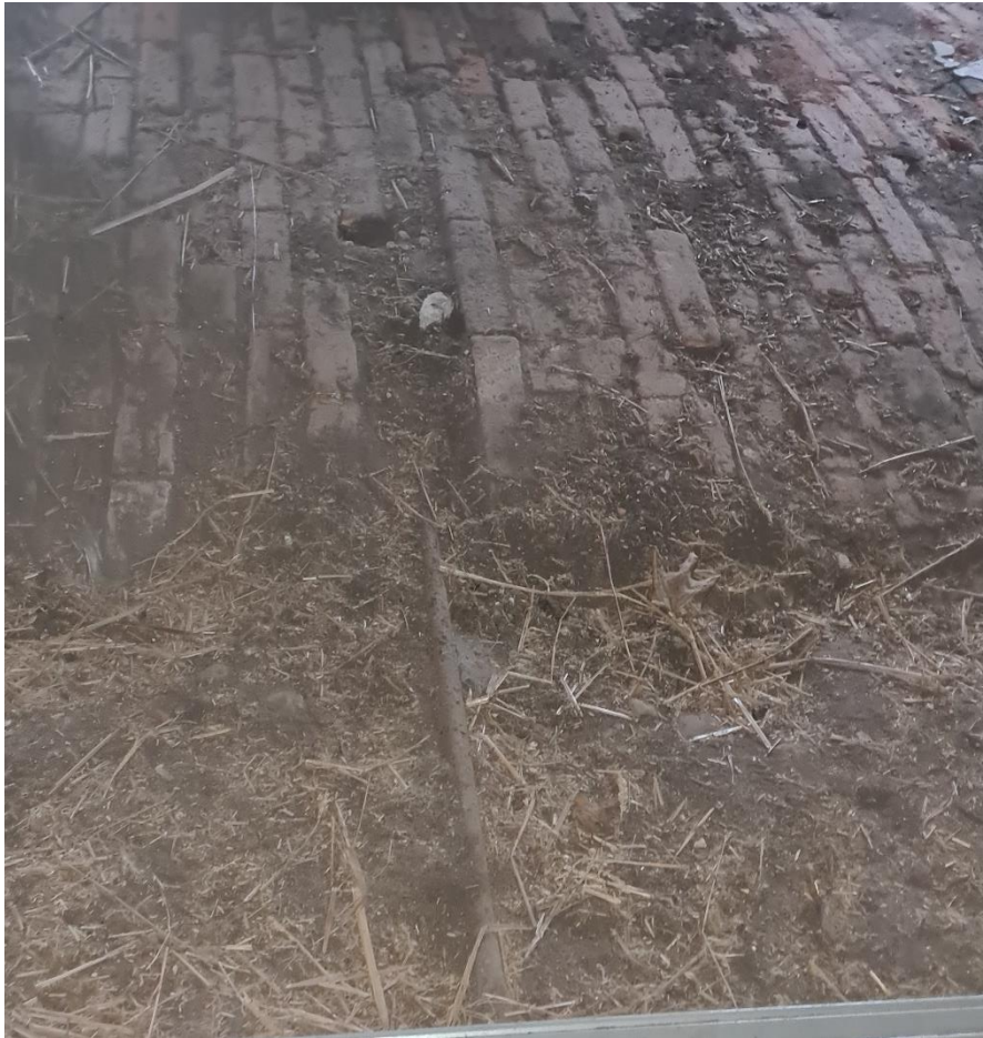
Rys. 30 Ubytki w cegle dziurawce w stropie kolebkowym. Ściąg stalowy.
