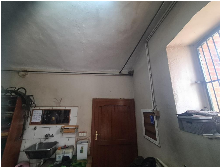
Rys. 61 Ściagi stalowe poniżej stropu kolebkowego zakotwione poprzez zastosowanie iniektów kotwiących pręty, kołki stalowe.
