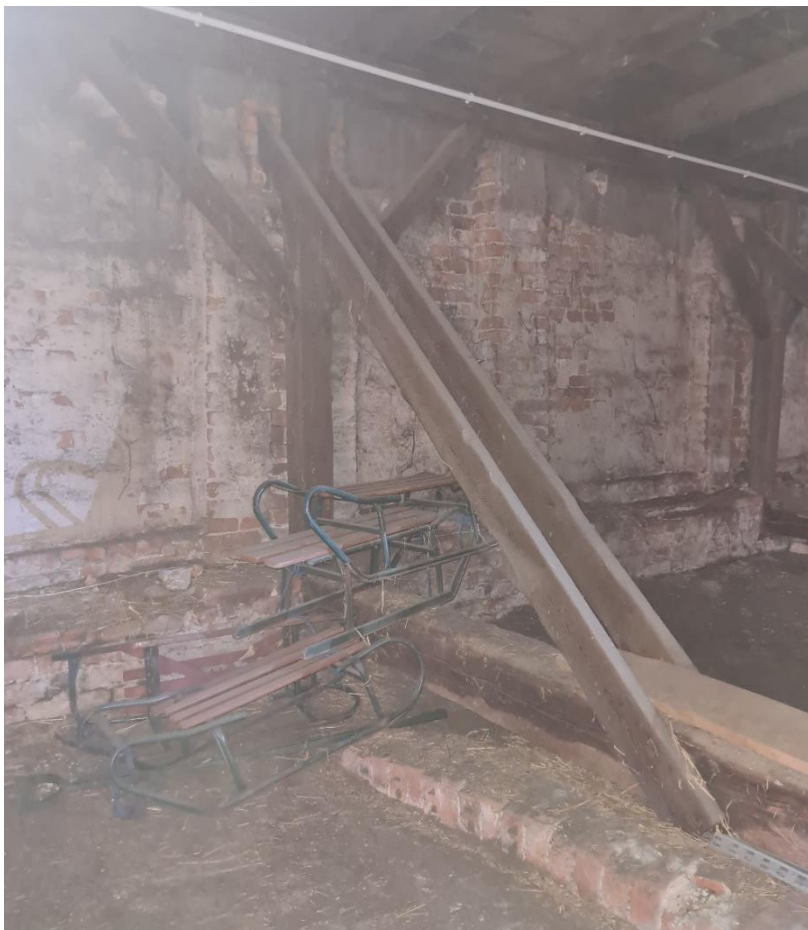
Rys. 52 Wyraźne próby naprawy i wzmocnienia węzła dolnego ramy drewnianej.
