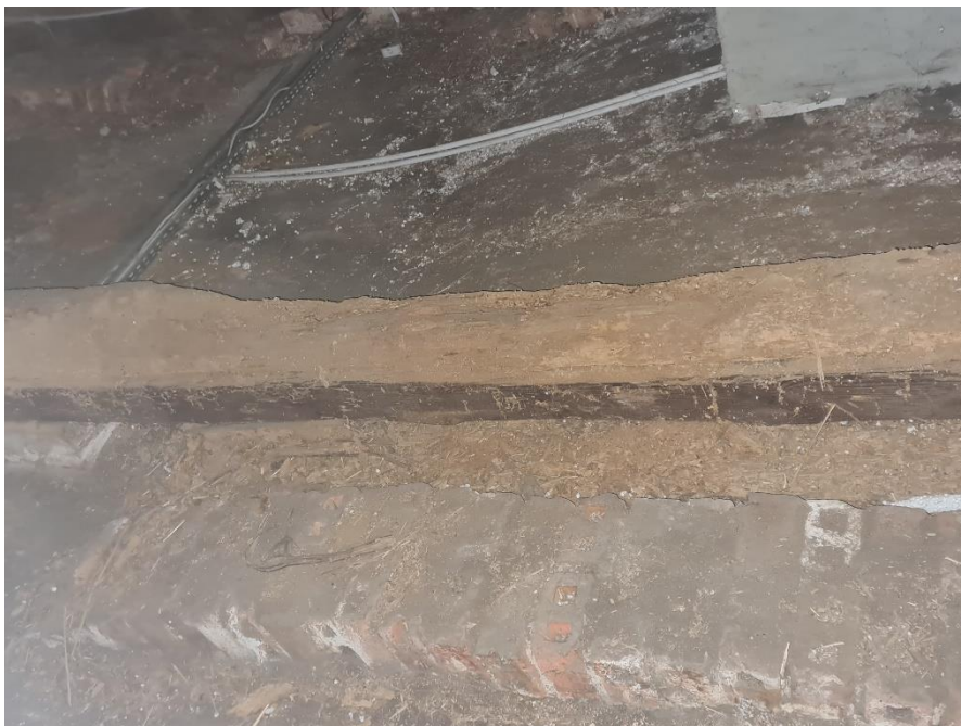
Rys36 .Belka podwalinowa uległa korozji biologicznej.
