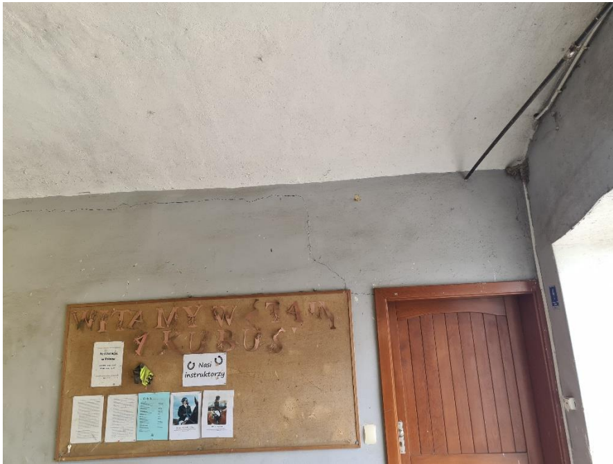
Rys. 60 Pęknięcia poziome ściany pod stropem kolebkowym.
