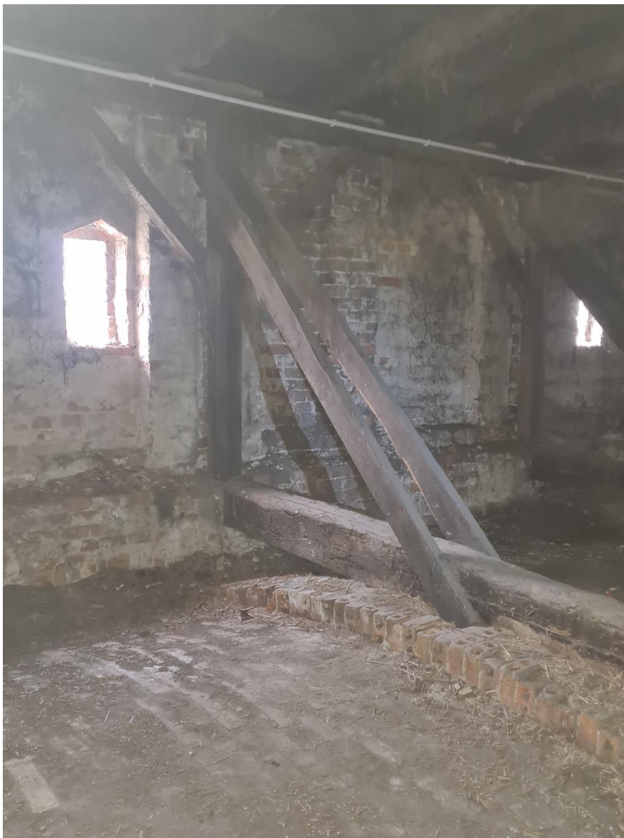
Rys.44 Otwór okienny bez okna oraz węzeł dolny ramy drewnianej wraz z łukiem ceglany i stropem kolebkowym.
