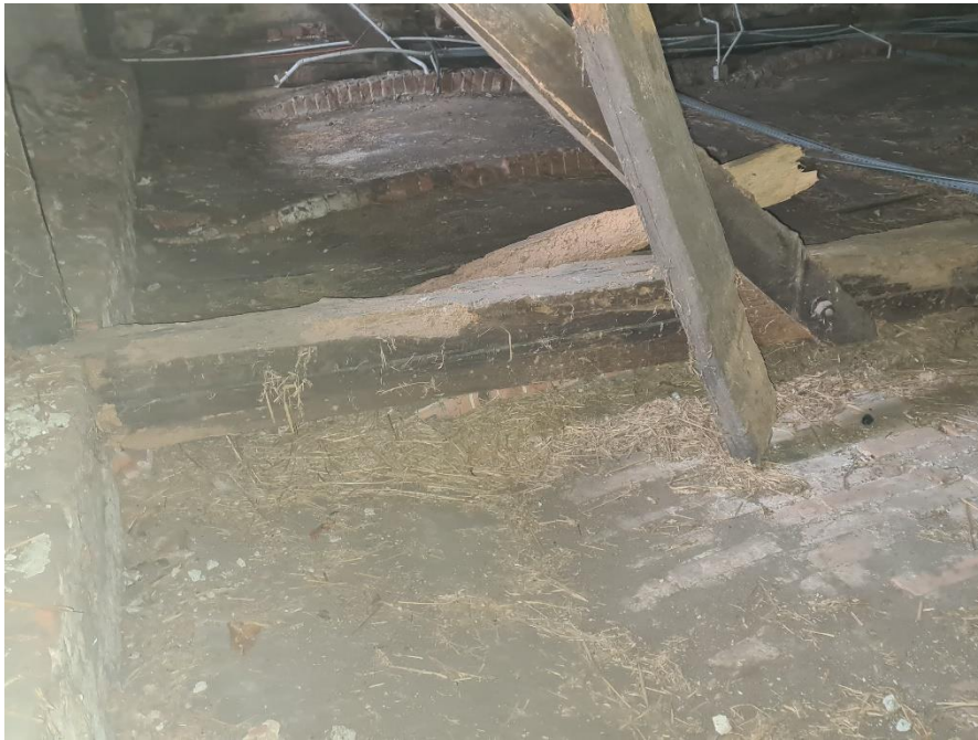
Rys. 25 Uszkodzone zastrzały i uszkodzona belka podwalinowa.
