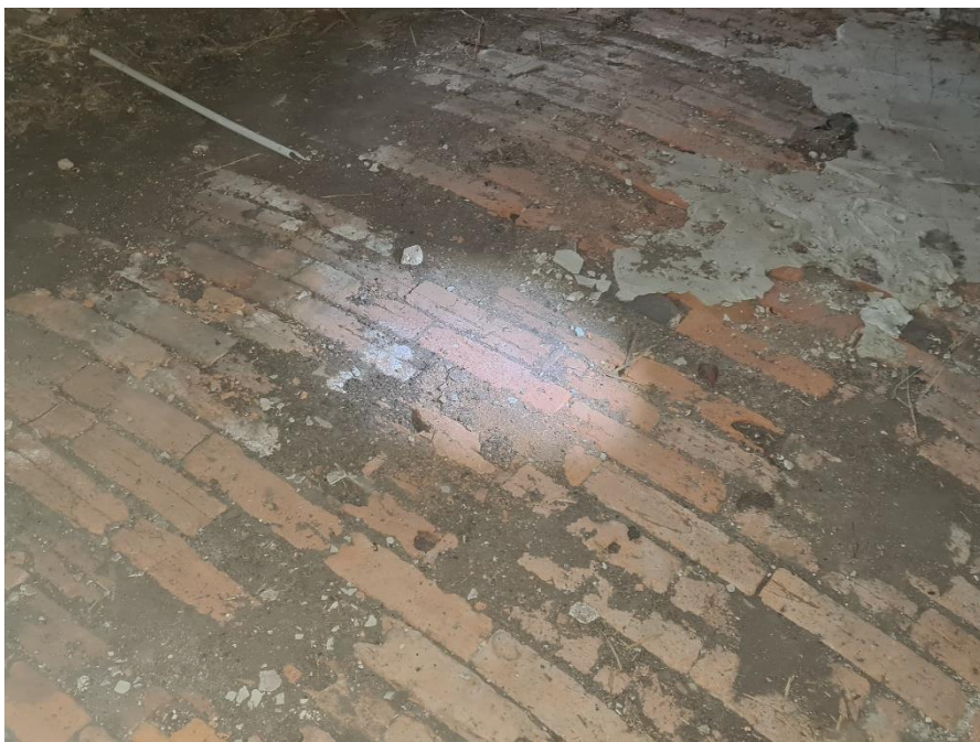
Rys. Ubytki w cegle dziurawce w stropie kolebkowym.
