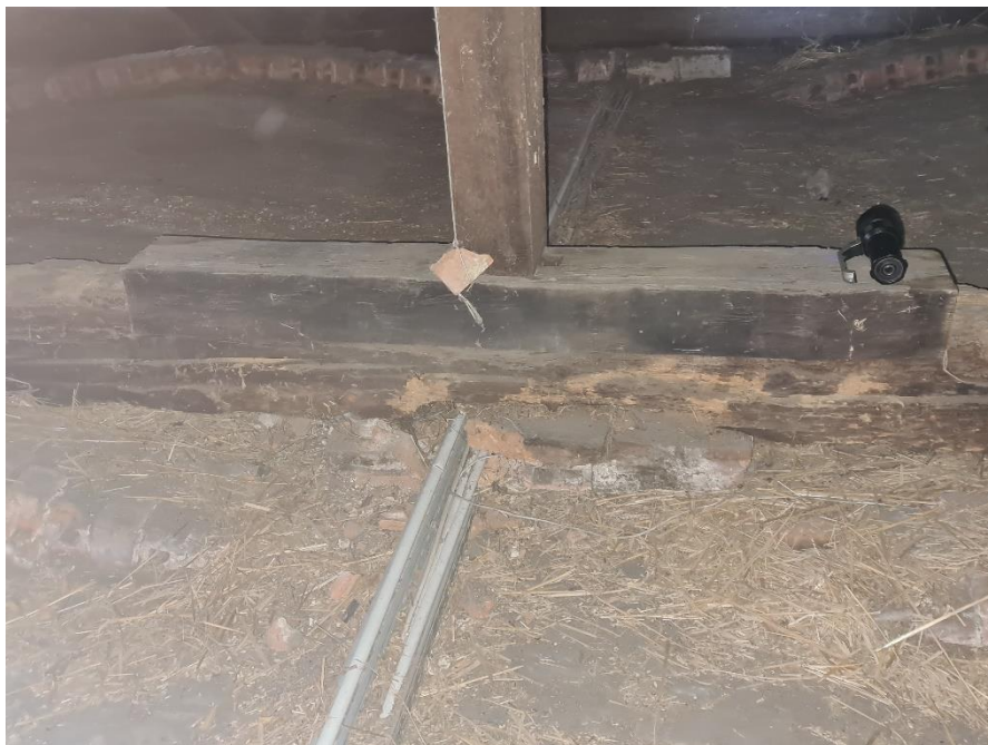
Rys.23 Zestaw podpór pod słupem pośrednim ze śladami postępującej korozji biologicznej.
