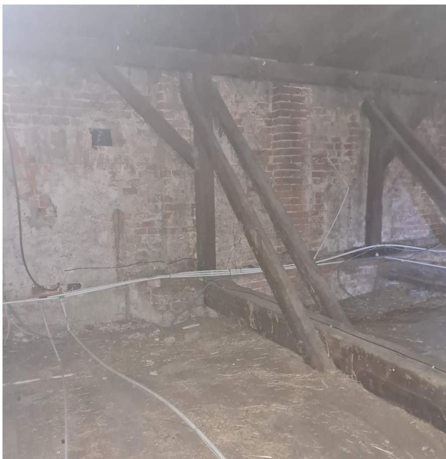
Rys. 46 Typowy wygląd węzeł dolny i górny ramy drewnianej z widocznymi śladami korozji biologicznej.
