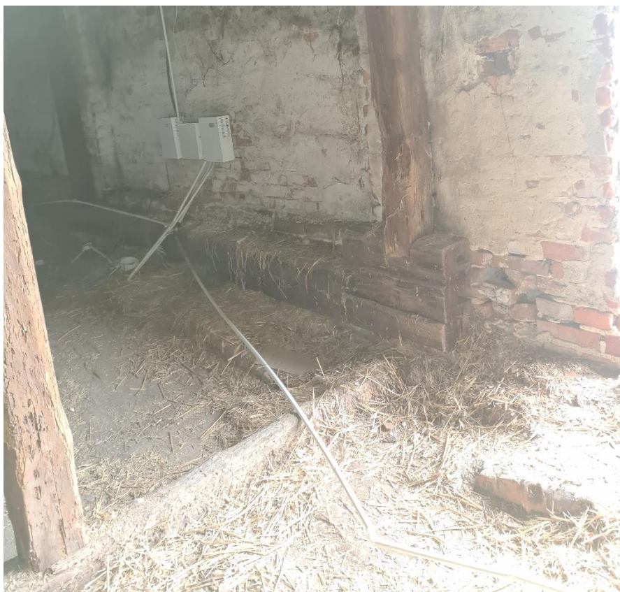
Rys. 56 Przerwana ciągłość podpór – belek podwalinowych w części skrajnej ram drewnianych.
