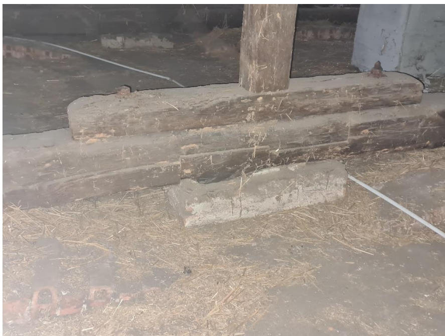
Rys.24 Zestaw podpór pod słupem pośrednim ze śladami postępującej korozji biologicznej.
