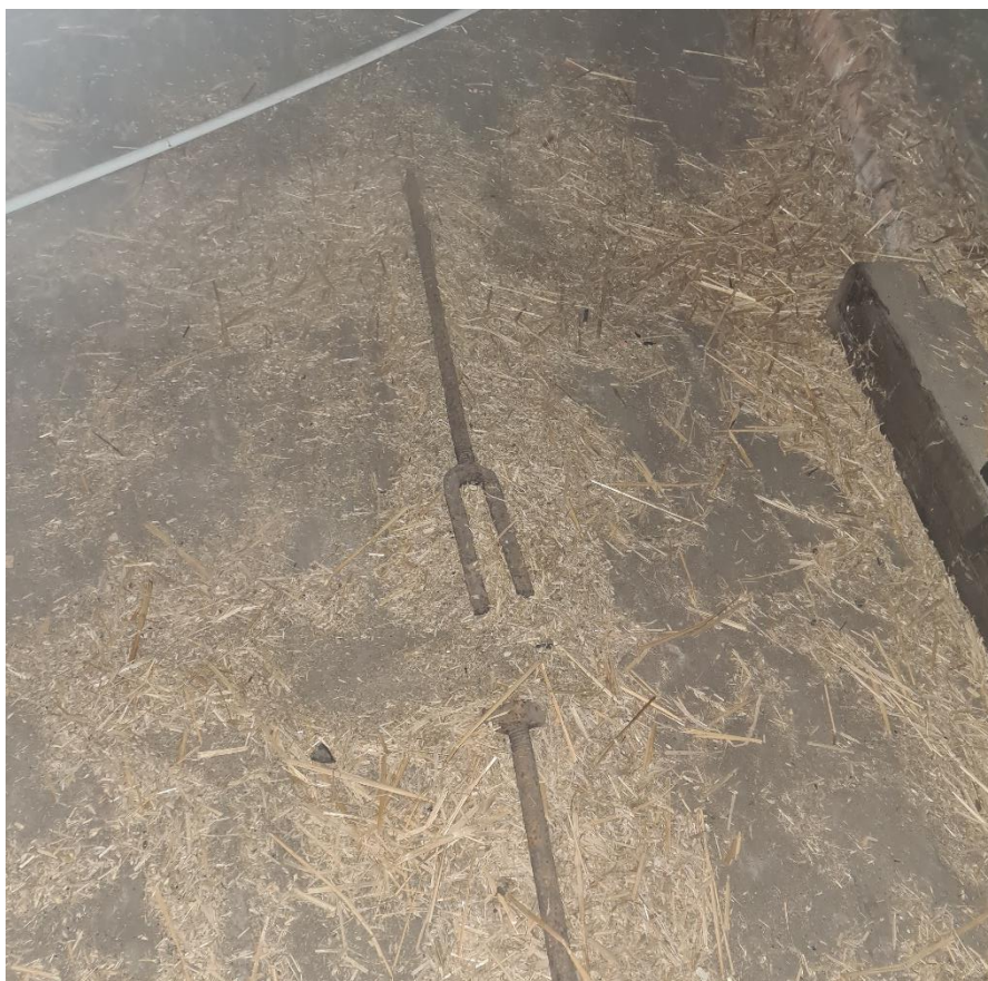
Rys. 16 Przerwany stalowy ścią z uszkodzoną śrubą rzymską. Ściągi zaprojektowane co drugie pole ram drewnianych.
