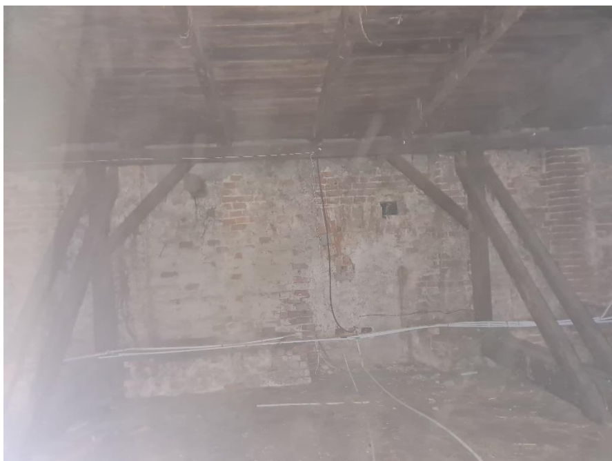
Rys. 47 Typowy wygląd węzła dolnego i górnego ramy drewnianej oraz krokwie i dolna część powierzchni poszycia dachowego z widocznymi śladami korozji biologicznej.
