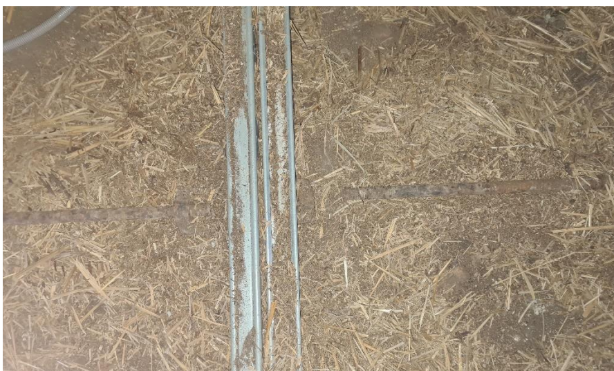
Rys.19. Przerwany stalowy ściąg z uszkodzoną śrubą rzymską. Ściągi zaprojektowane co drugie pole ram drewnianych.
