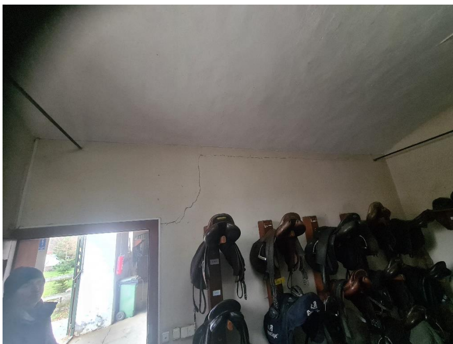
Rys. 63 Pęknięcia ściany w pomieszczeniu siodłowni.
