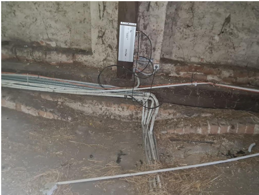
Rys. 13. Kable elektryczne i inne oraz pozostałości po przechowywanym sianie na stropie kolebkowym.
