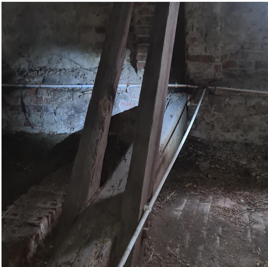
Rys.34 Zastrzały i belka podwalinowa uległy korozji biologicznej.
