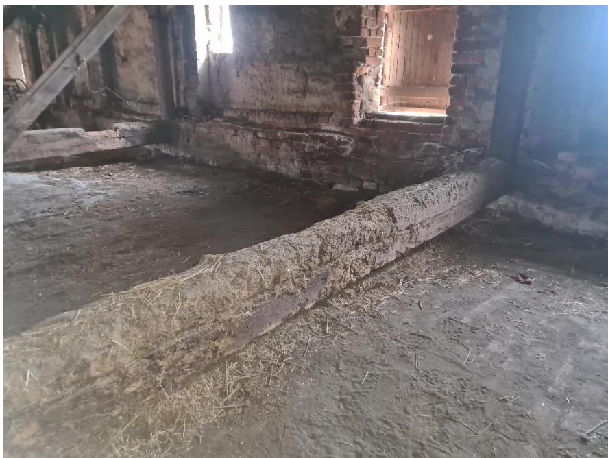
Rys. 49 Zniszczone korozją belki podwalinowe i brak rozpór.
