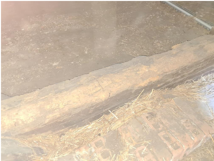
Rys. 22 Wyraźnie postępująca korozja biologiczna belki podwalinowej.
