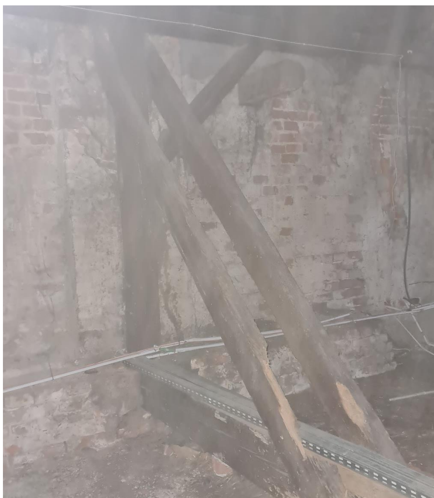
Rys. 42 Zniszczone zastrzały i częściowo belka podwalinowa.
