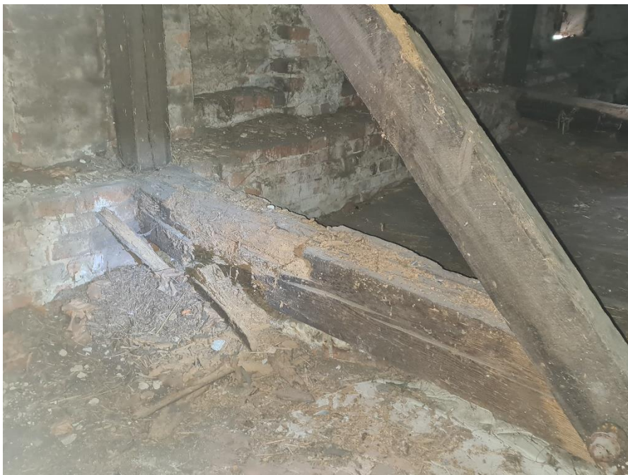
Rys. 28 Degradacja naroża ramy drewnianej poprzez eliminację zastrzałów i belki podwalinowej spowodowana korozją biologiczną
