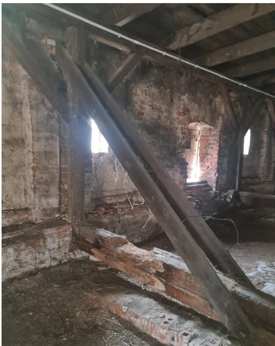
Rys.11 Typowy węzeł dolny ramy drewnianej zaatakowanej korozją biologiczną.
