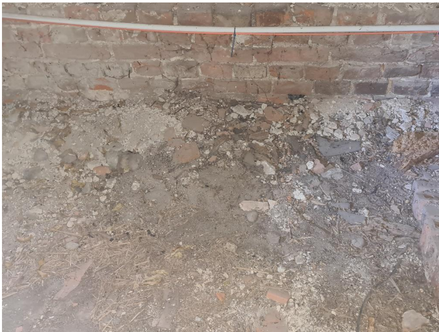
Rys.33 Rumor ceglany w miejscach połączenia muru i stropu.
