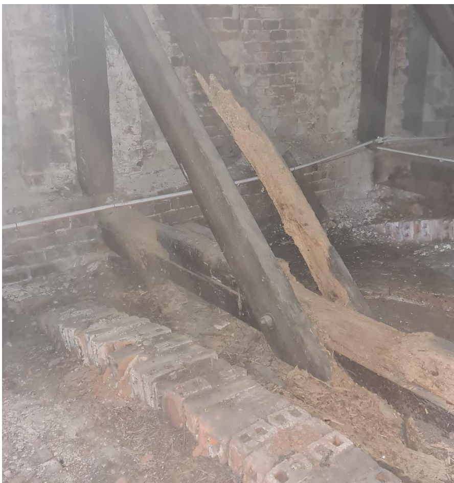
Rys. 35 Zastrzały i belka podwalinowa uległy korozji biologicznej.
