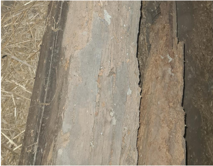
Rys. 27 Wyraźnie zniszczona belka podwalinowa spowodowana korozją biologiczną
