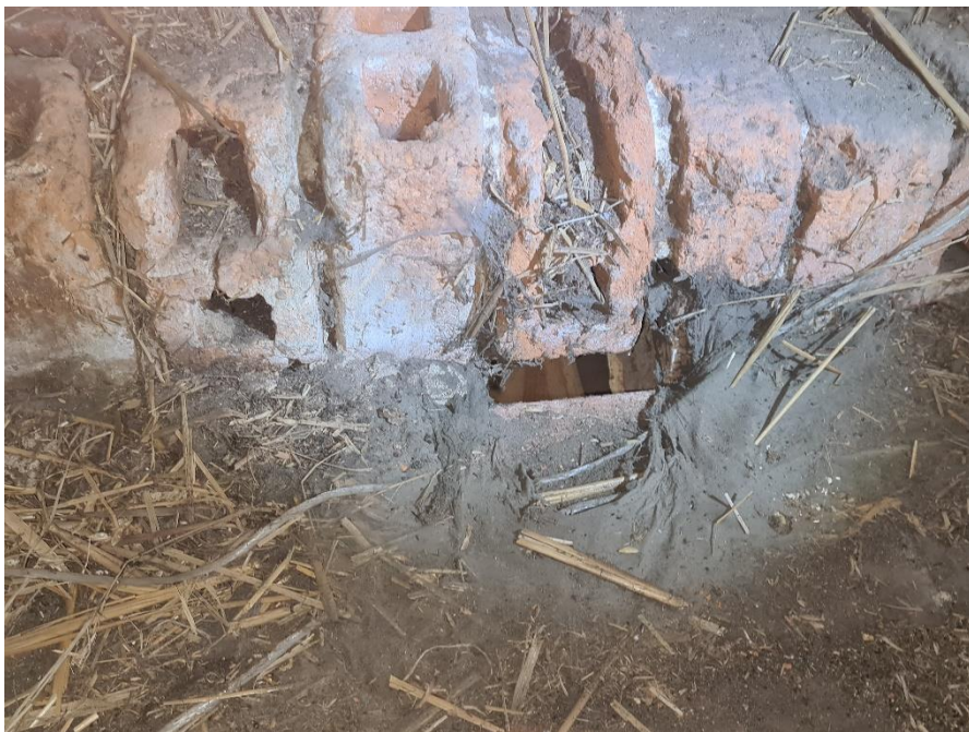
Rys. 38 Uszkodzone miejsca w połączeniu stropu kolebkowego i łuku ceglanego. Z cegły dziurawki.
