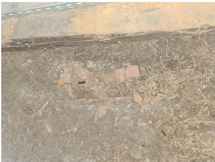
Rys.41 Uszkodzona powierzchnia stropu kolebkowego.
