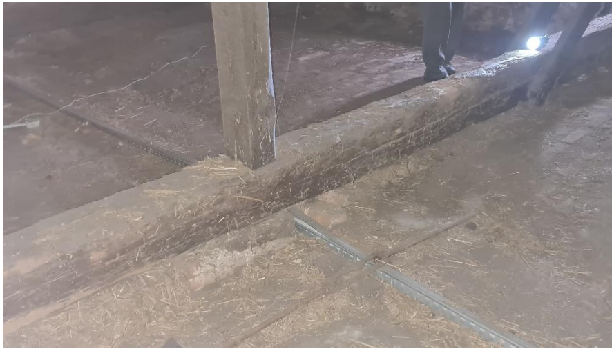
Rys. 43 Belka podwalinowa w środku rozpiętości uległa korozji biologicznej.
