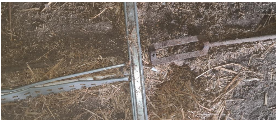
Rys. 18 Przerwany stalowy ściąg z uszkodzoną śrubą rzymską. Ściągi zaprojektowane co drugie pole ram drewnianych.
