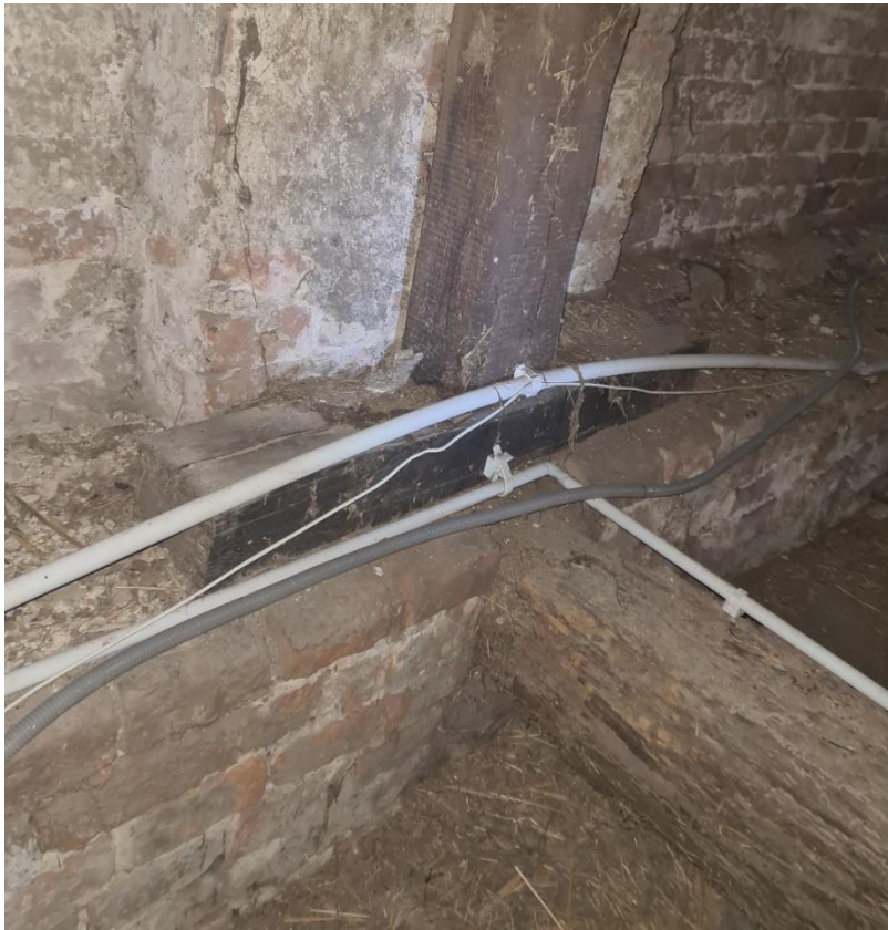
Rys. 51 Węzeł dolny połączenia belki podwalinowej i słupa skrajnego wraz z uszkodzeniami spowodowanymi korozją biologiczną.
