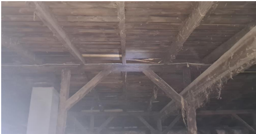
Rys.58 Uszkodzenia w poszyciu dachu nad jętką.
