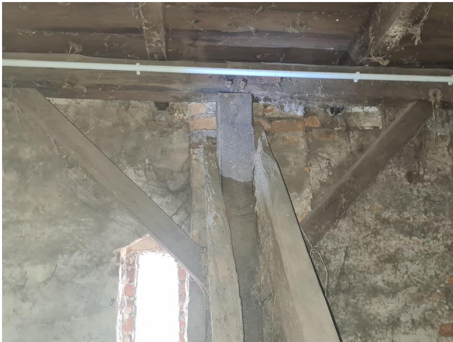
Rys. 26 Zastrzały, miecze uległe destrukcji korozji biologicznej.
