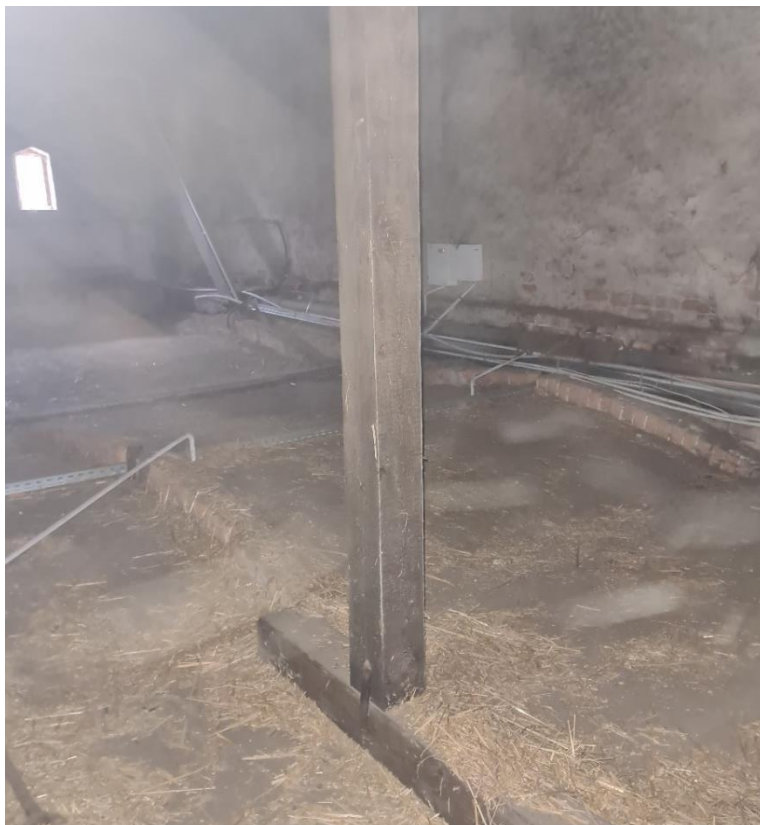
Rys. 15 Słup drewniany oparty odcinkowej belce drewnianej, zarażonej korozją biologiczną.
