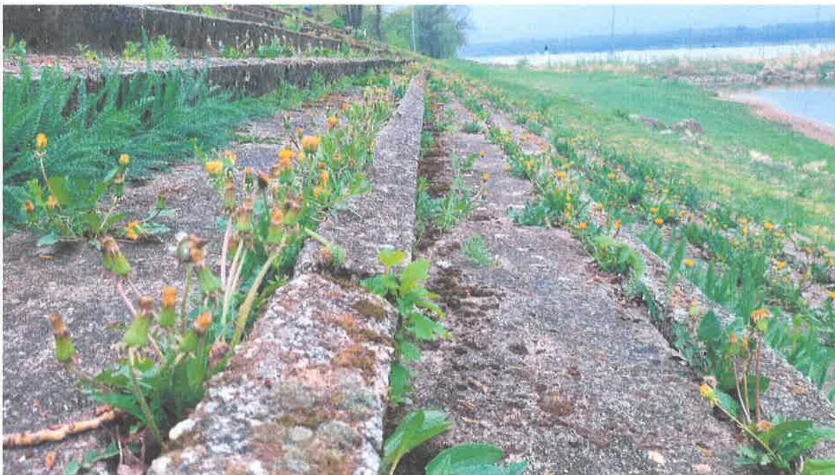
Fot.9 Widoczne wychylenia od pionu płyt schodowych stanowiących podstopnice
