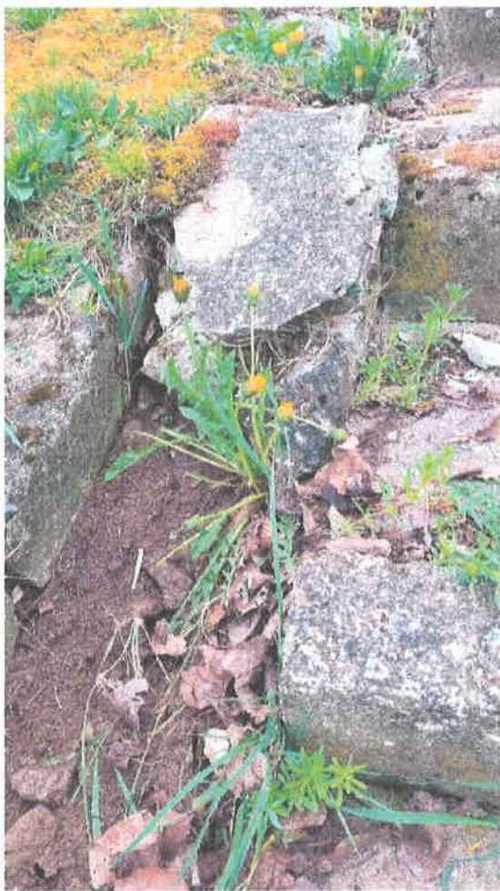
Fot.8 Widoczne uszkodzenia betonowego zamykającego schody od strony wschodniej
