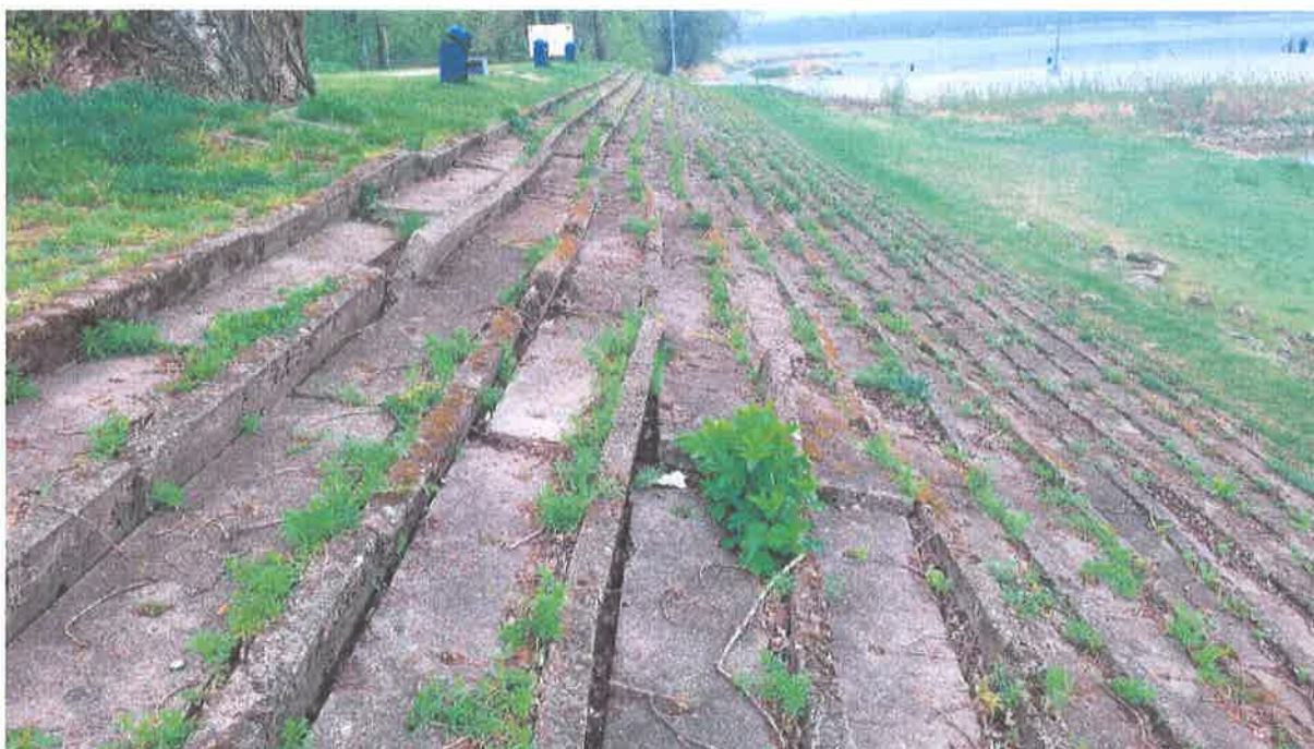
Fot.7 Widoczne uszkodzenia schodów spowodowane rozrostem korzeni pobliskiego drzewa
