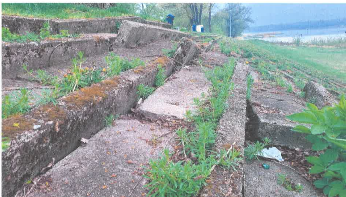
Fot.6 Widoczne uszkodzenia schodów spowodowane rozrostem korzeni pobliskiego drzewa
