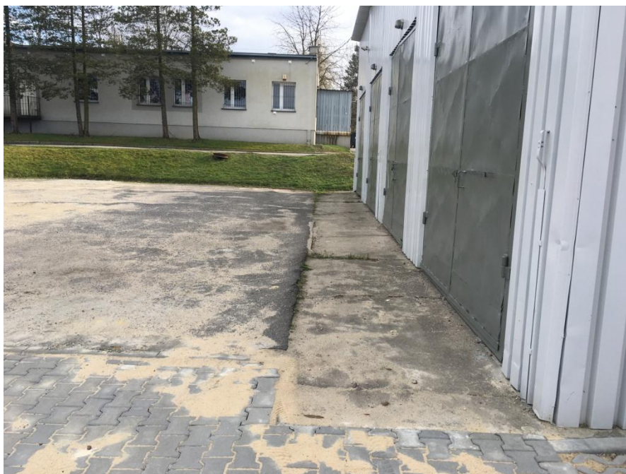
Zdjęcie 1) Uszkodzenia nawierzchni placu przy wiacie postojowo-magazynowej
