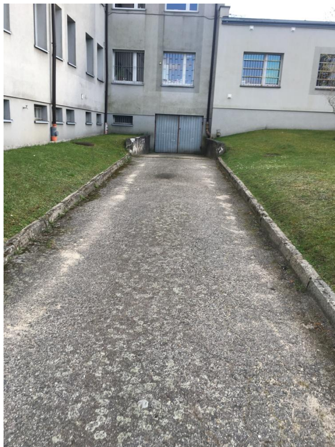
Zdjęcie 4) Zdegradowana nawierzchni ciągu drogowego z licznymi nierównościami w profilu podłużnym i poprzecznym
