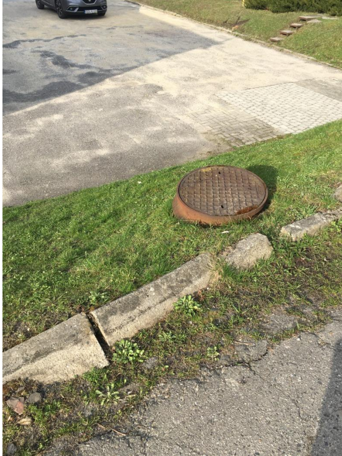
Zdjęcie 3) Uszkodzone elementy krawędziowe nawierzchni
