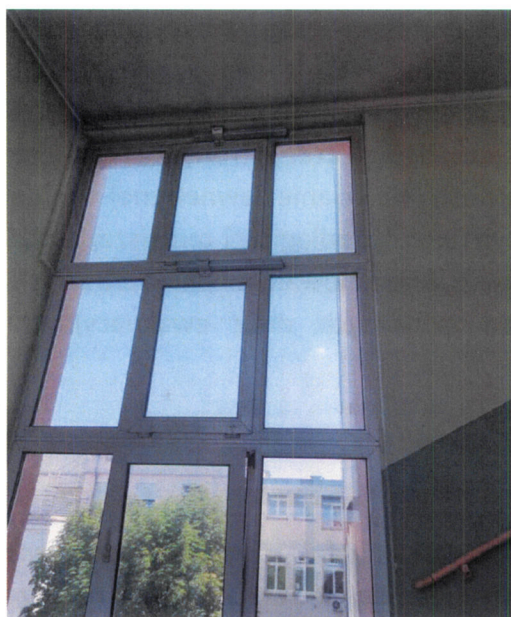
Rys. 10. Widok na okna klatki schodowej AKS1 z siłownikami służącymi napowietrzaniu klatki w sytuacji wystąpienia pożaru
