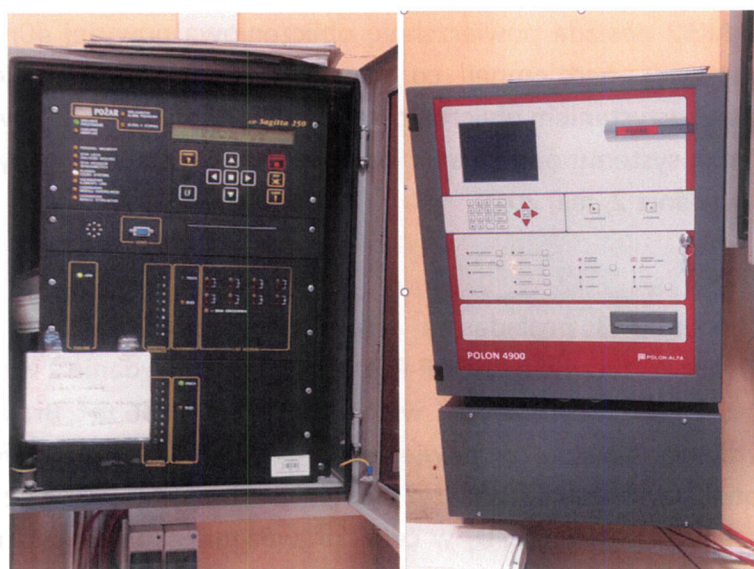
Rys. 3. Centrale SSP znajdujące się na parterze budynku A
