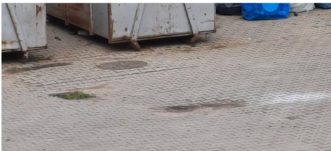
rys. 5. Zagłębienie placu manewrowego, niedrożna studzienka kanalizacji deszczowej.
