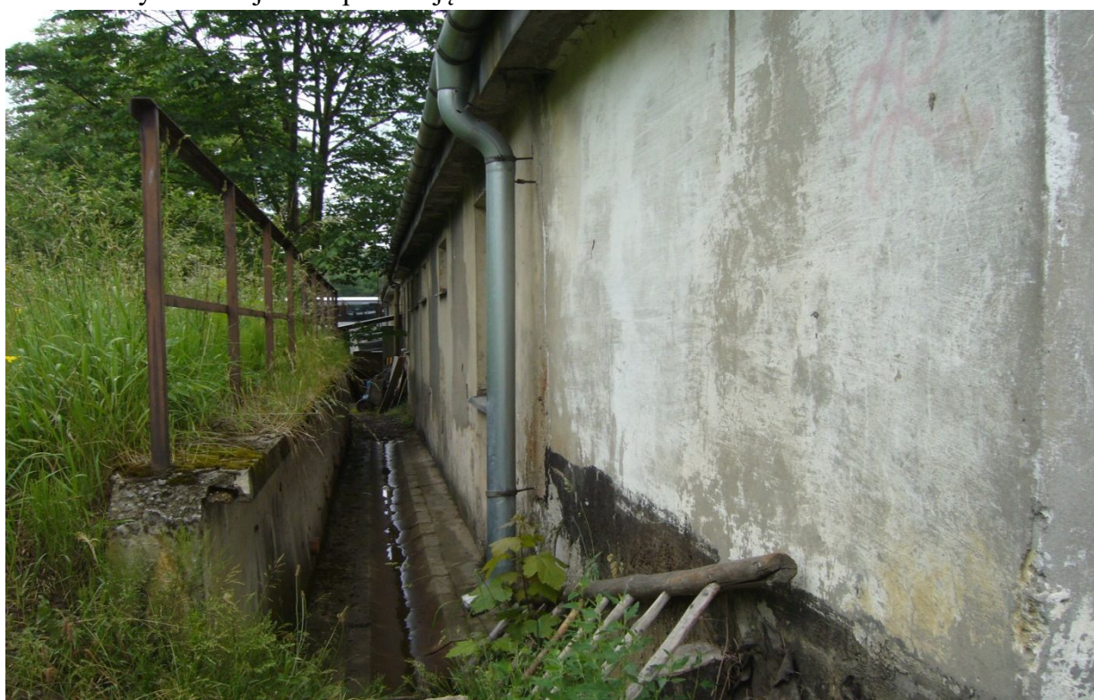
Zdjęcie nr 3: Elewacja południowa Prace do wykonania jak w opisie zdjęcia nr.1
