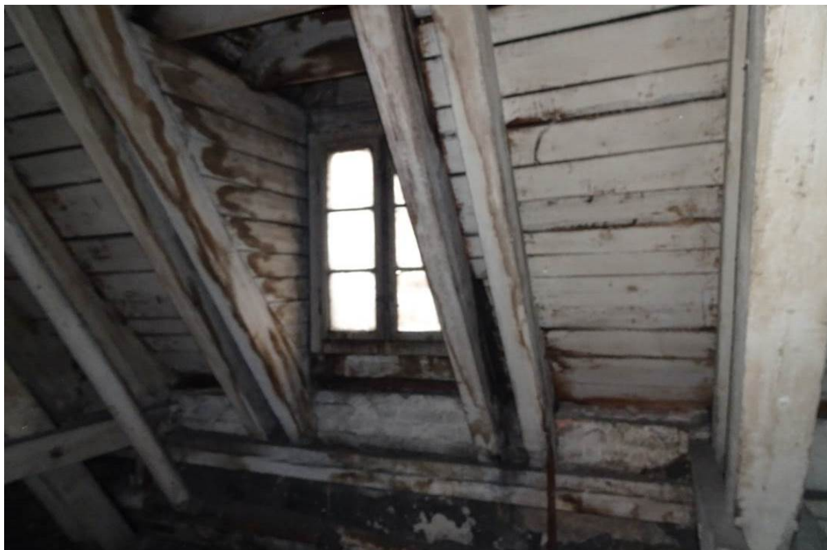
Rys. 28. Ślady zawilgoceń (od ul. Kilińskiego)
