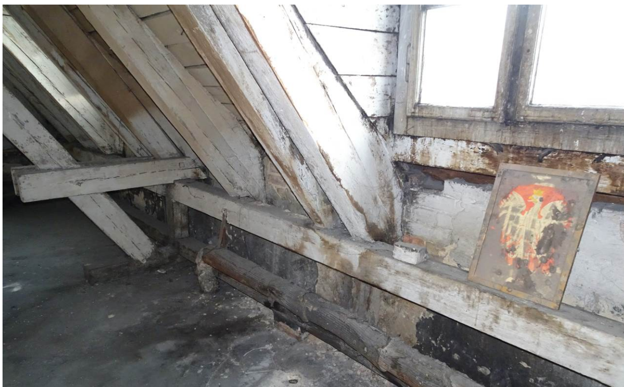
Rys. 29. Ślady zawilgoceń os strony południowo-zachodniej
