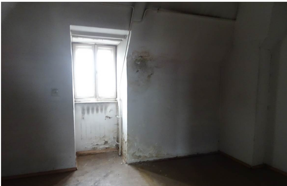
Rys. 15. Zabudowane elementy więźby w części południowo-zachodniej. Widoczne ślady zacieków
