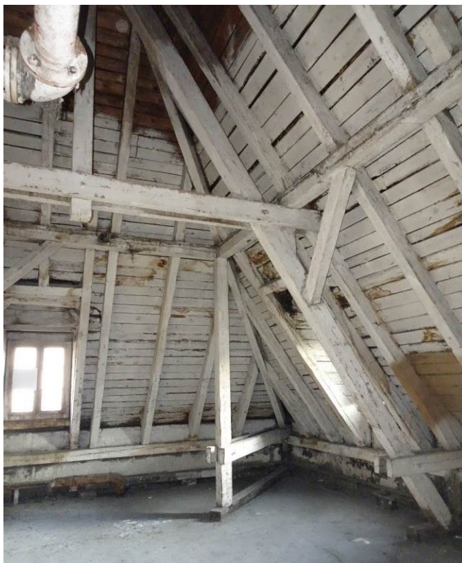
Rys. 26. Ślady zawilgoceń (narożnik ul. Żwirki i Wigury i Kilińskiego)
