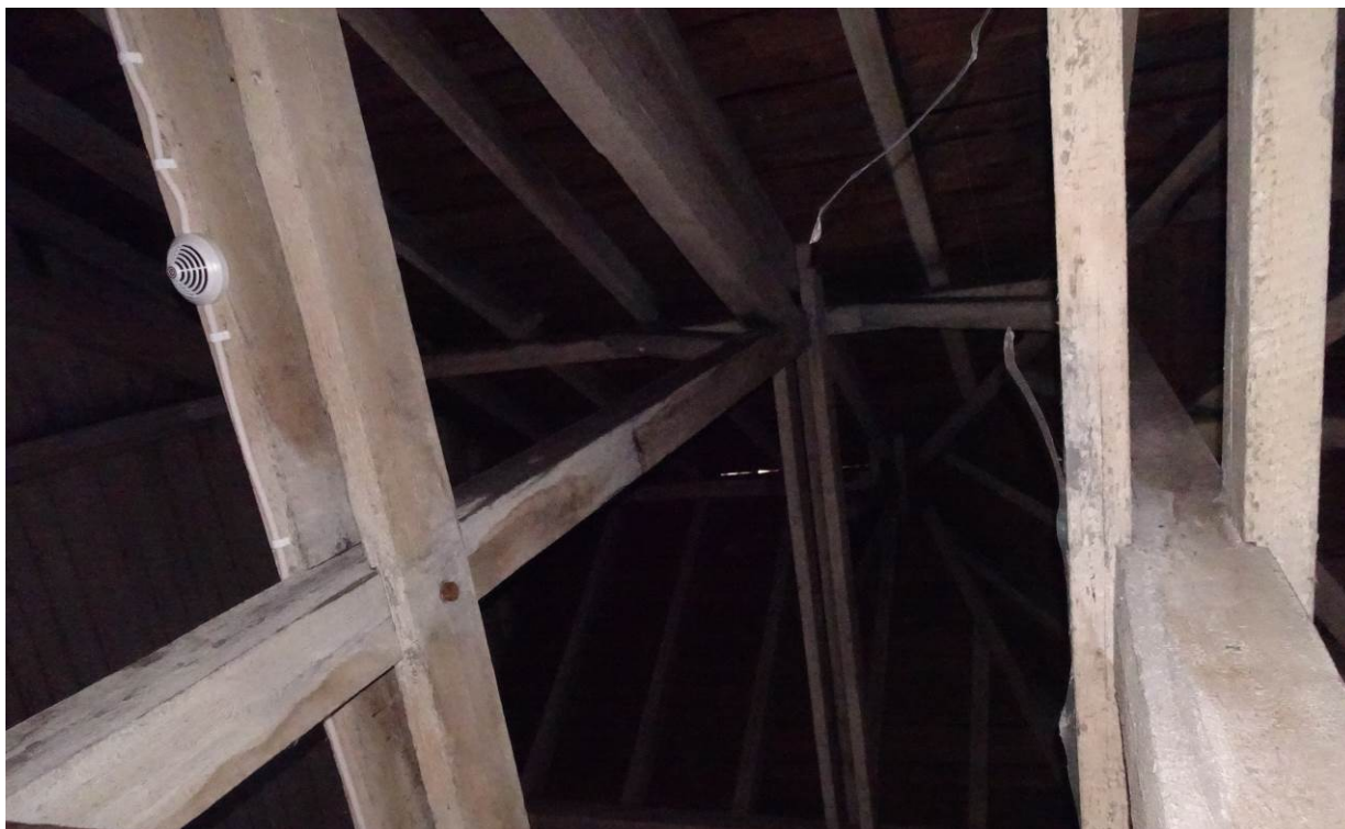
Rys. 21. Nieszczelności pokrycia w kalenicy (od ul. Kilińskiego)
