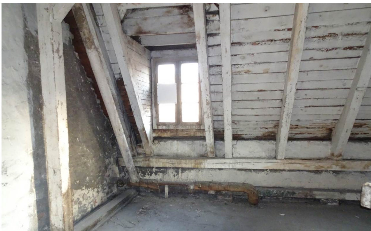
Rys. 27. Ślady zawilgoceń (od ul. Żwirki i Wigury)
