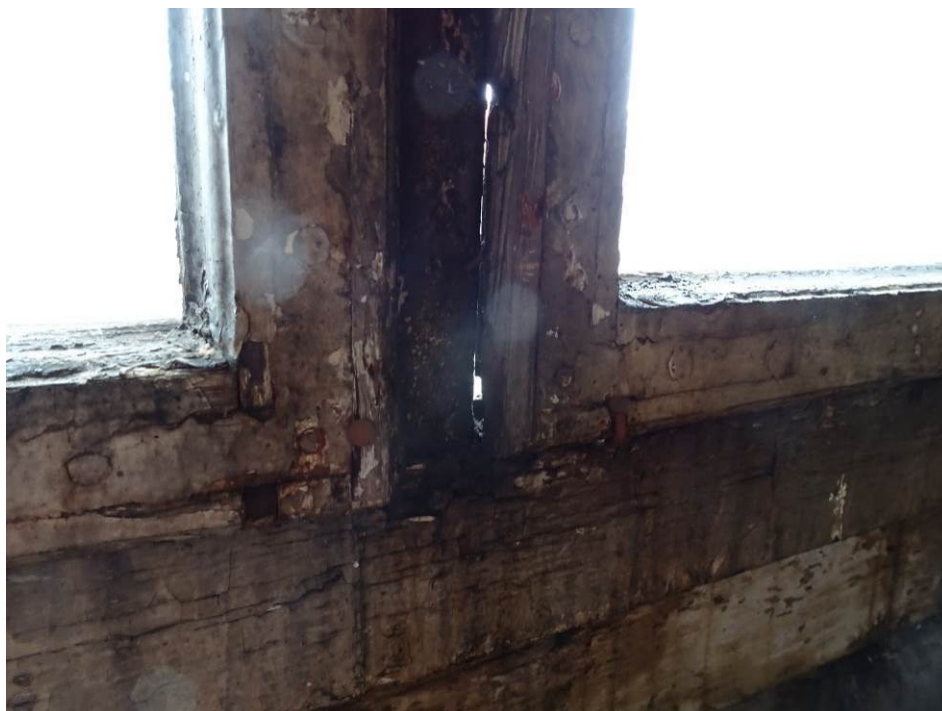
Rys. 23. Ślady po przeciekach, nieszczelność i zły stan stolarki okiennej (od ul. Kilińskiego)
