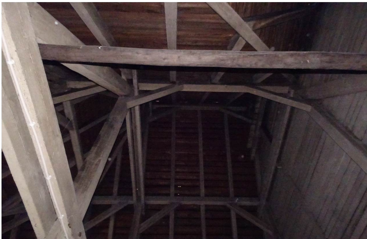
Rys. 20. Nieszczelności pokrycia dachu (od ul. Żwirki i Wigury)
