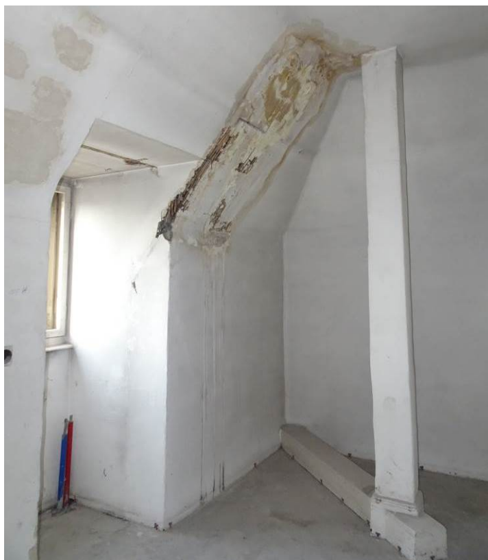
Rys. 31. Ślady zawilgoceń (część południowo-zachodnia)
