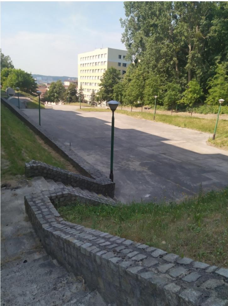
13.Nawierzchnia ist.betonowa parkingu do remontu
