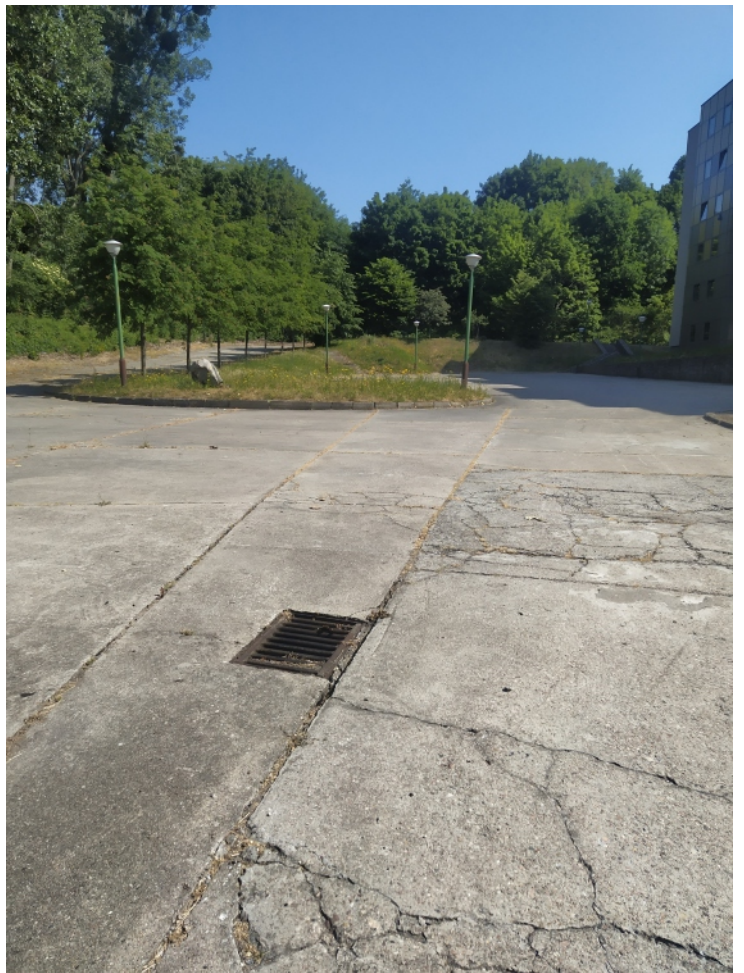
14.Nawierzchnia ist.betonowa parkingu do remontu
