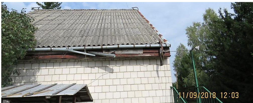
Prowizoryczne „naprawy” rynny dachu. Korozja obróbek blacharskich dachu, korozja rynhaków i rynien.
