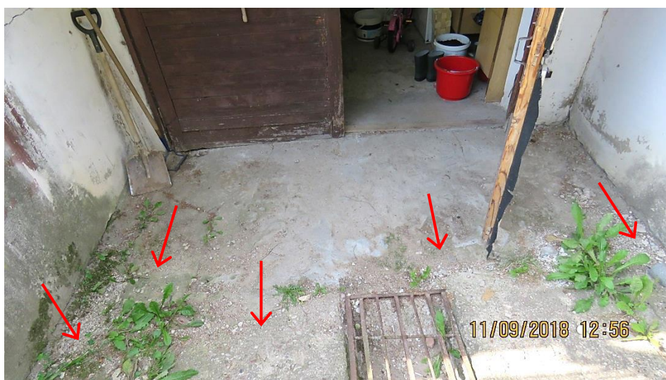
Wykuszony beton posadzki przy wjeździe do piwnicy.
