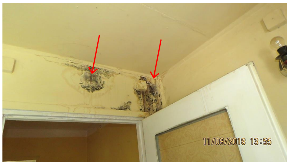
Zagrzybiona ściana parteru. Ślady zacieków.
