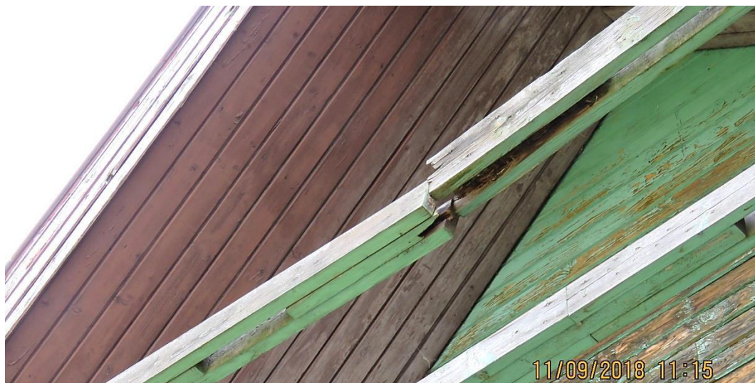
Pęknięte kleszcze więzara dachu.
