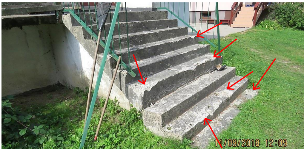
Wykruszenia stopni schodów. Elewacja wschodnia.
