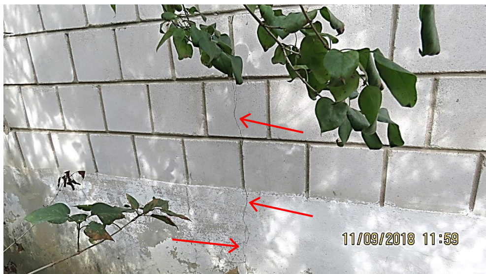
Pionowa rysa ściany piwnicznej i parteru. Elewacja południowa.
