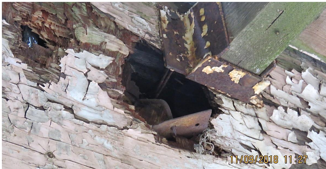
Miejsce „mocowania” drewnianej konstrukcji balkonu poddasza do ściany budynku.
