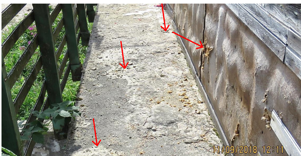
Wykruszenia powierzchni płyty balkonu. „Naprawy” ścian płyta piłśniową miękką. Elewacja wschodnia.
