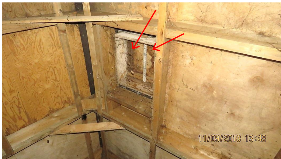
Zacieki wylazu dachowego.
