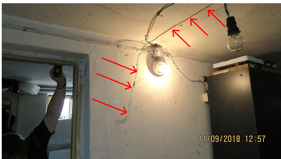
Pęknięcie stropu nad piwnicą przechodzące na ścianę.
