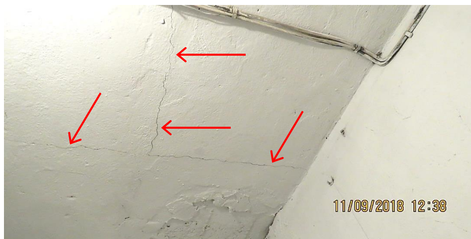
Pęknięcia sufitu kotłowni.
