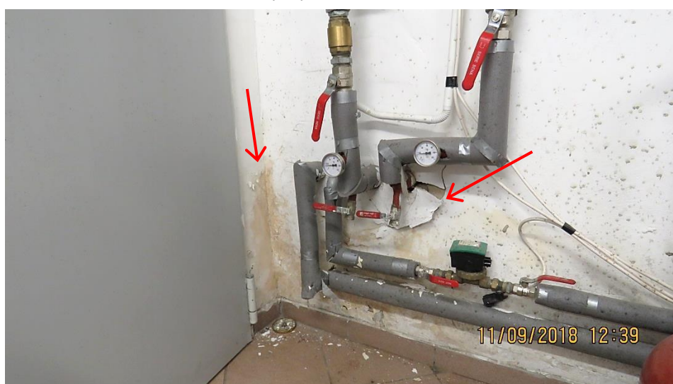
Zacieki ściany piwnicznej w kotłowni w miejscu przejścia rur przez ścianę.
