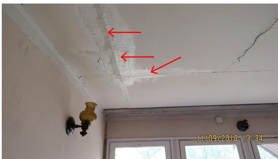
Ślady napraw pęknięcia sufitu nad poddaszem.
