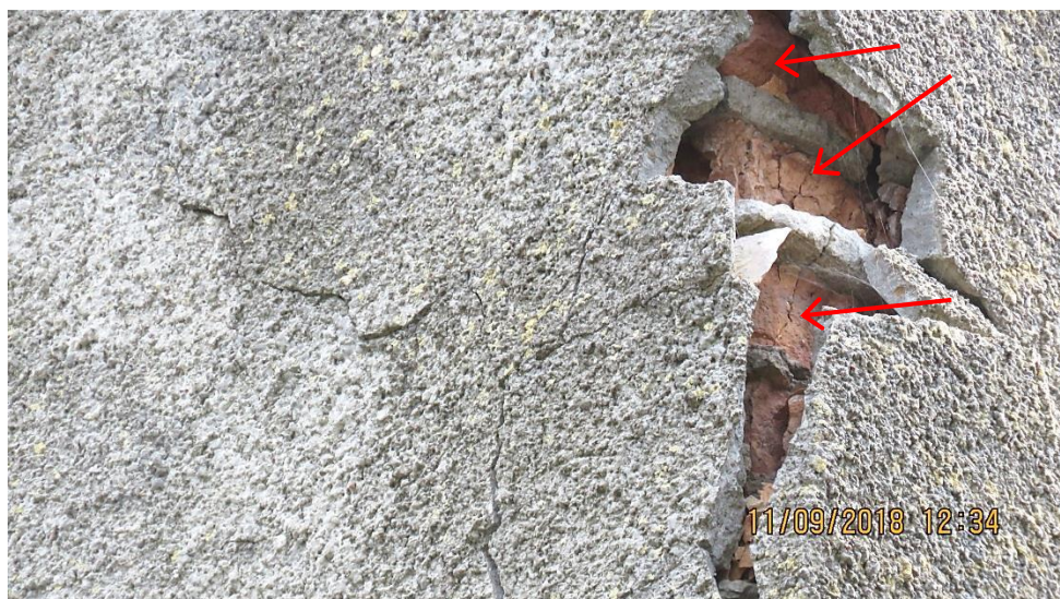
Uszkodzenia komina, pęka tynk, wykruszają się cegły i spoiny. Korozja cegieł.
