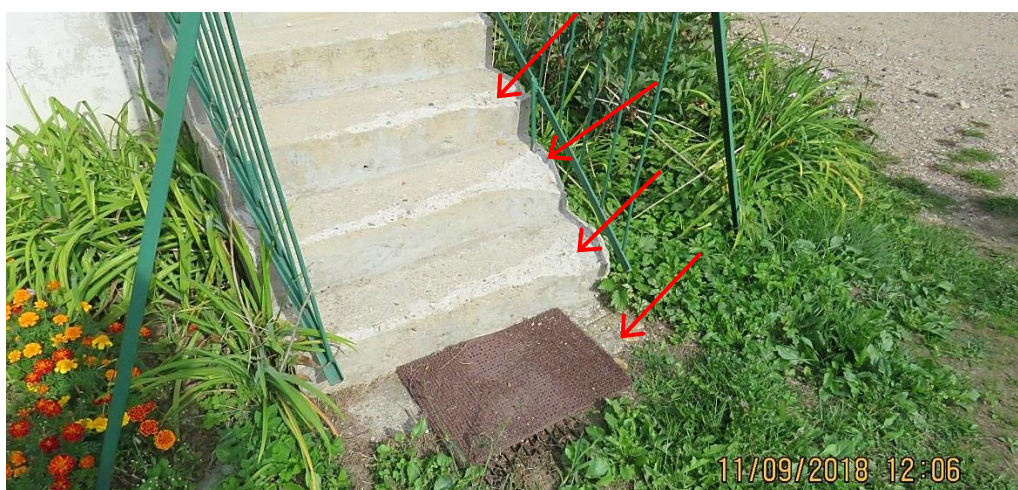
Wykruszenia stopni schodów. Elewacja południowa.
