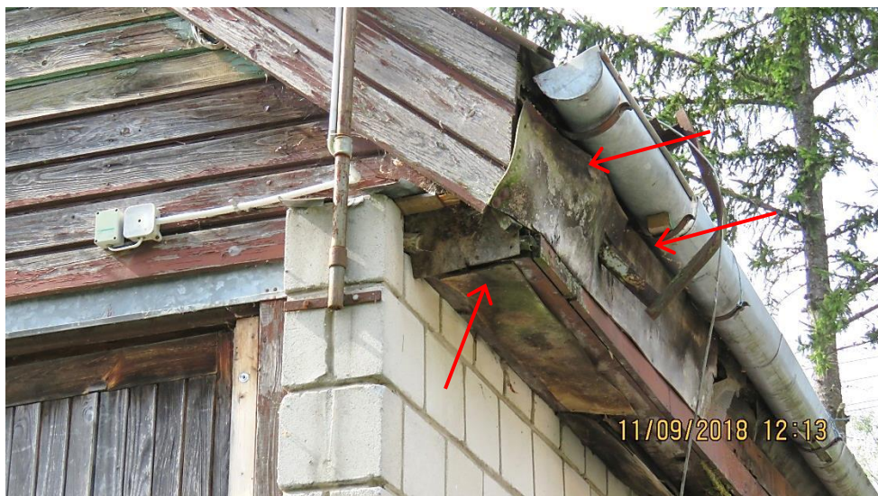
Zacieki okapu dachu pod rynną.
