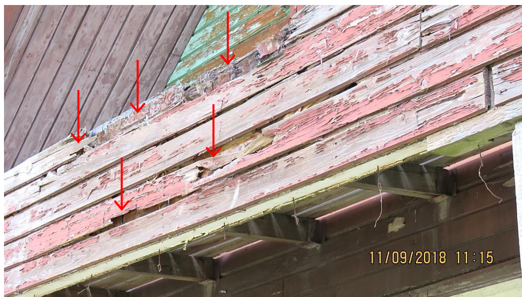
Zniszczona zewnętrzna osłona balkonu poddasza. Silnie ugięta, podparta prowizorycznie deskami.
