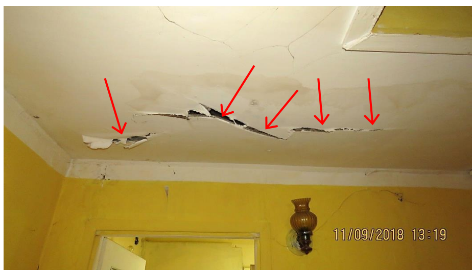
Zacieki stropu nad parterem, pęknięty strop.
