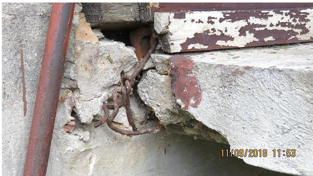
Wykruszenia betonu płyty balkonu. Elewacja zachodnia.
