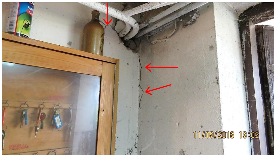
Pęknięcie narożnika ściany piwnicznej.
