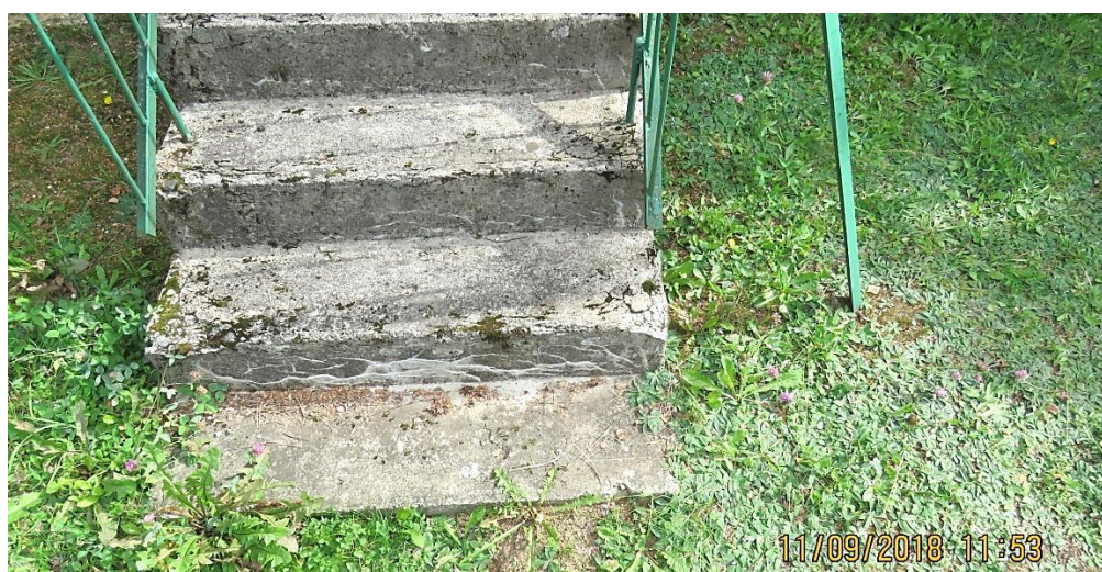
Wykruszenia betonu schodów.
