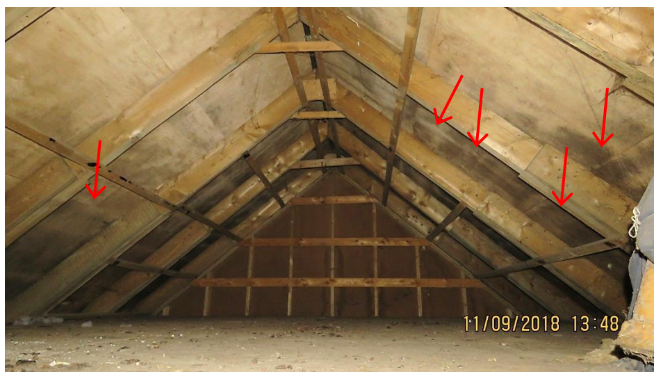
Ślady zacieków dachu.
