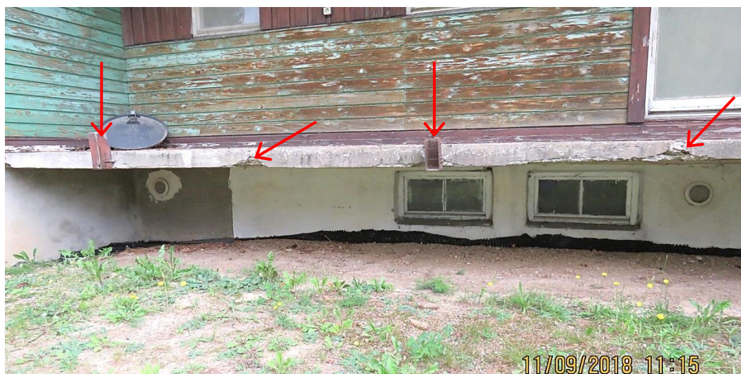
Wykruszenia betonu balkonu parteru. Puste gniazda po drewnianych słupkach podparcia balkonu poddasza.
