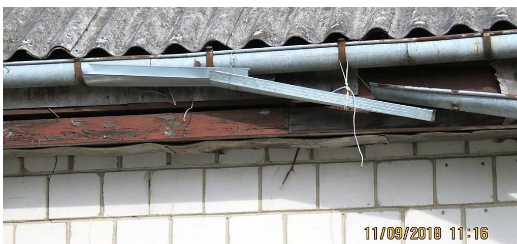
Prowizoryczne „naprawy” rynny dachu. Korozja obróbek blacharskich dachu, korozja rynhaków i rynien.
