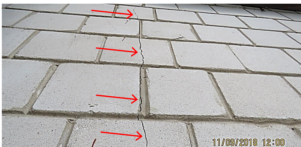
Pęknięcie ściany piwnicznej i parteru. Elewacja południowa.
