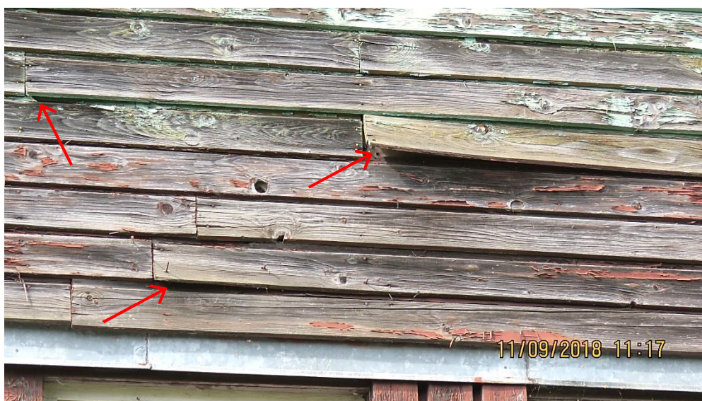
Wypaczenia desek poszycia elewacji wschodniej, złuszczenia resztek farby, korozja gwoździ.
