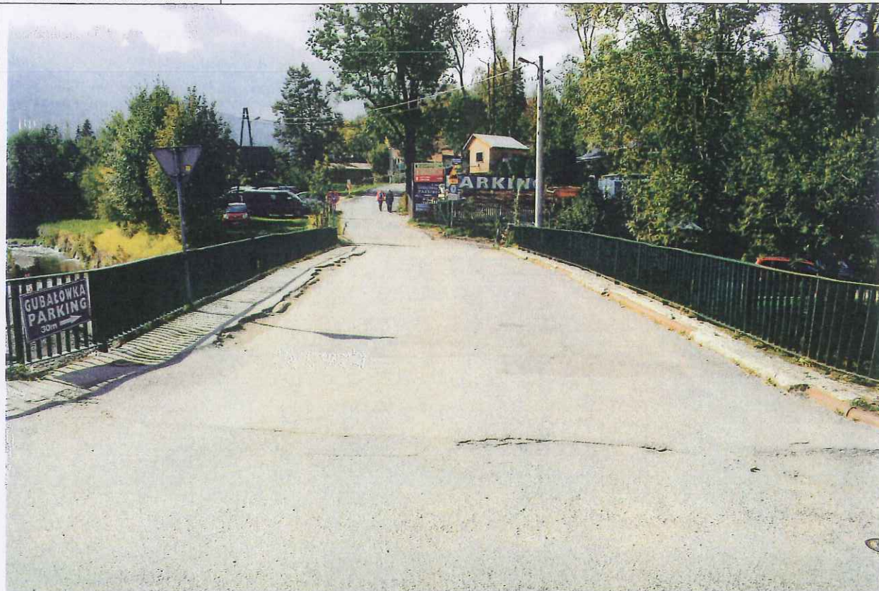
Fot. 3. Widok stanu nawierzchni na obiekcie i na dojazdach, zniszczony krawężnik
