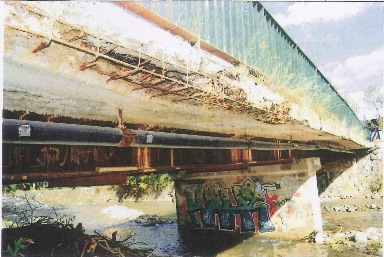
Fot. 13. Widok stanu technicznego gzymsu (korozja betonu i stali) deformacja
