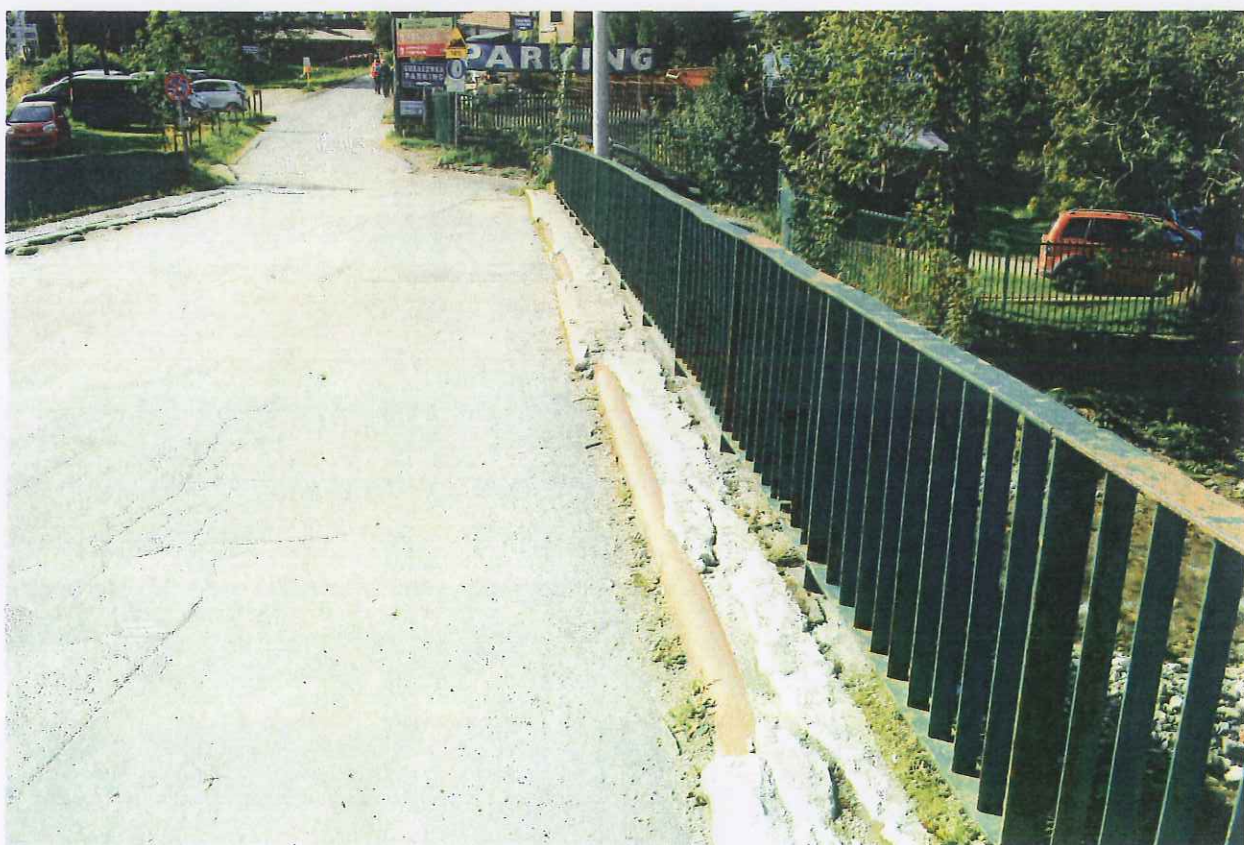
Fot. 4. Widok obiektu od dolnej wody, odsłonięta rura stalowa w bezpieczeńniku
