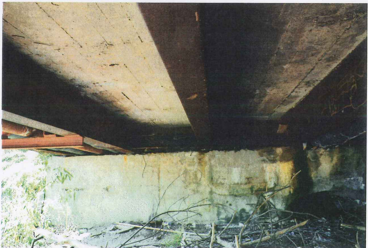
Fot. 14. Widok podpory skrajnej od strony ul. Walowa Góra (korozja betonu, stali)
