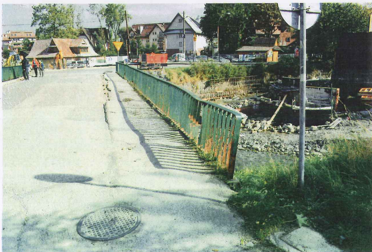
Fot. 2. Widok obiektu od górnej wody, uszkodzona nawierzchnia, deformacja poręczy
