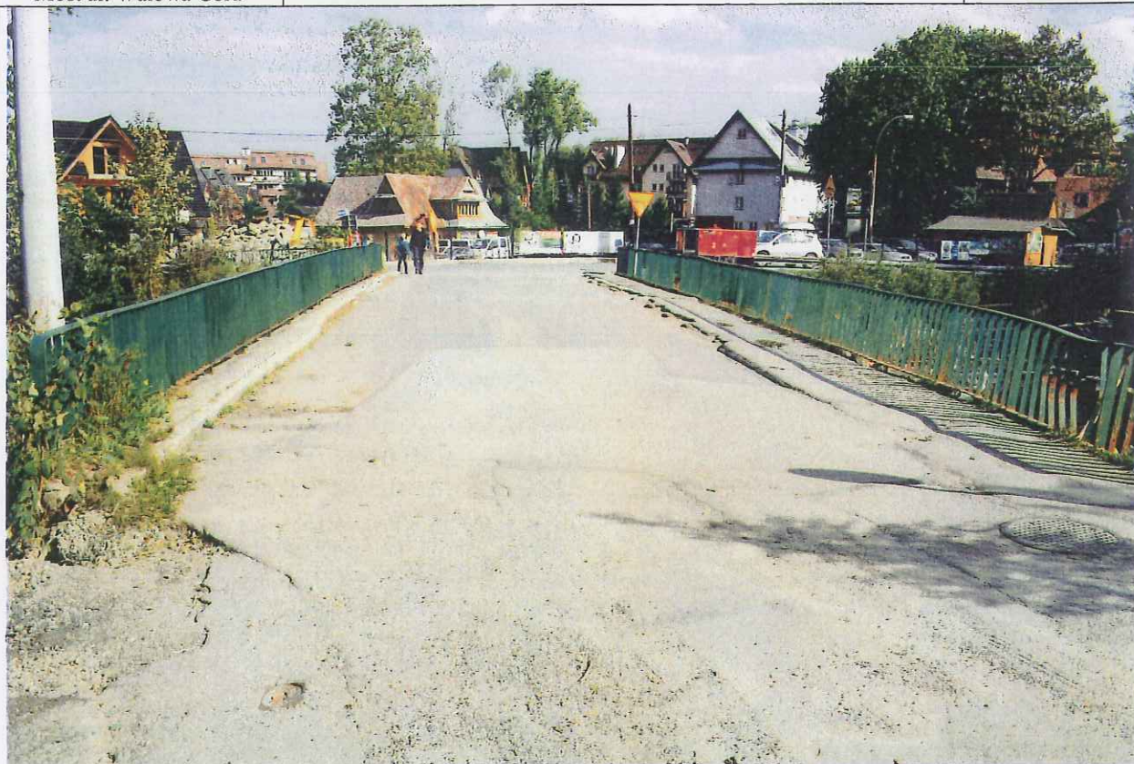
Fot. 1. Widok stanu nawierzchni na obiekcie i na dojazdach, zniszczony krawężnik
