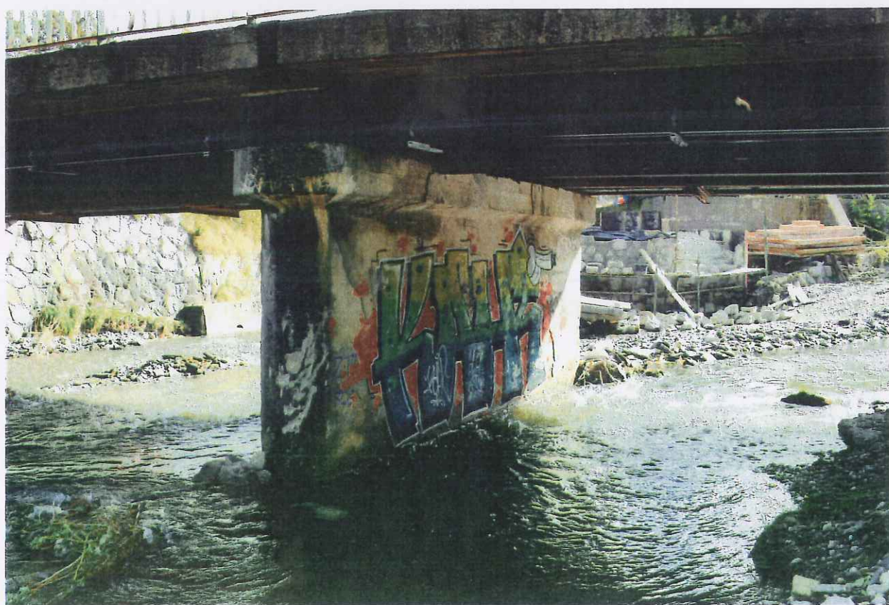
Fot. 6. Widok prac umocnieniowych w korycie od górnej wody, spękania filara
