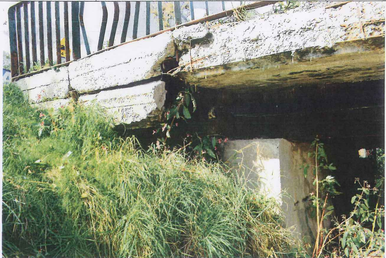
Fot. 11. Widok uszkodzenia (awarii) od górnej wody – złamany wspornik podpory
