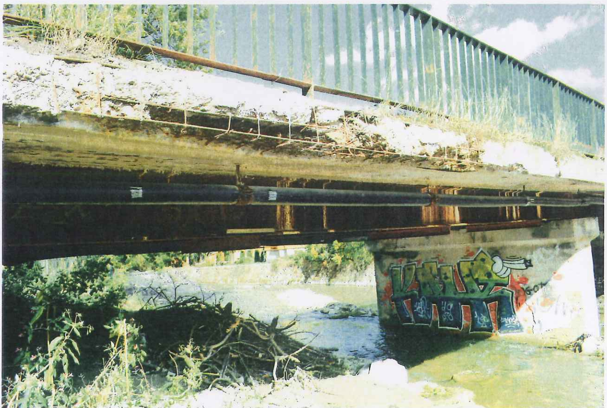
Fot. 12. Widok obiektu od górnej wody, zniszczony gzyms, korozja dźwigara
