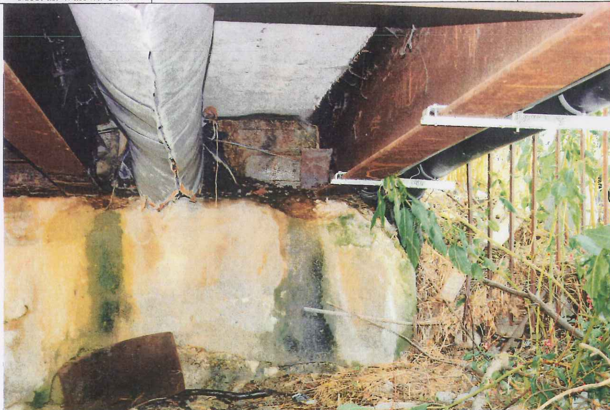
Fot. 7. Widok stanu technicznego obiektu (zniszczona łąwa podłożyskowa, brak podparcia dźwigara głównego) do będącego w złym stanie technicznym obiektu zamontowano nowe kable.
