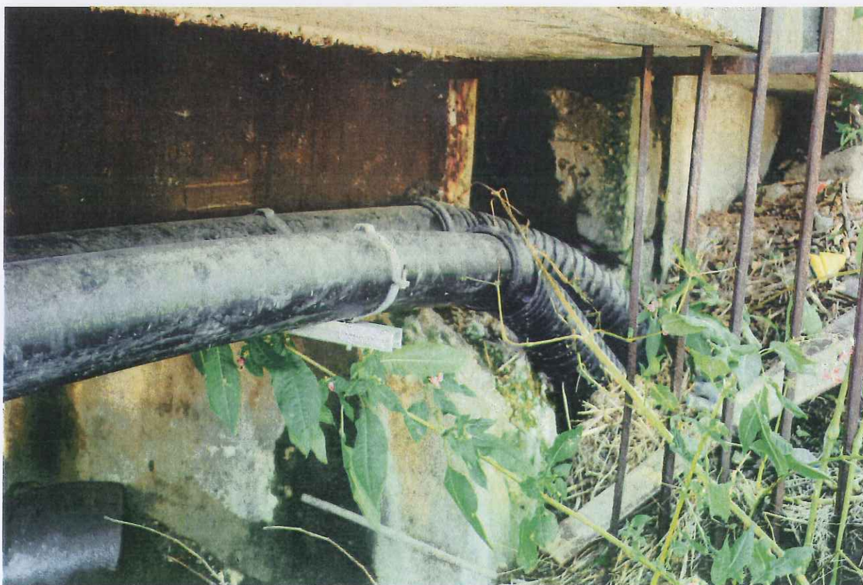
Fot. 10. Widok złamanego skrzydła podpory skrajnej od dolnej wody
