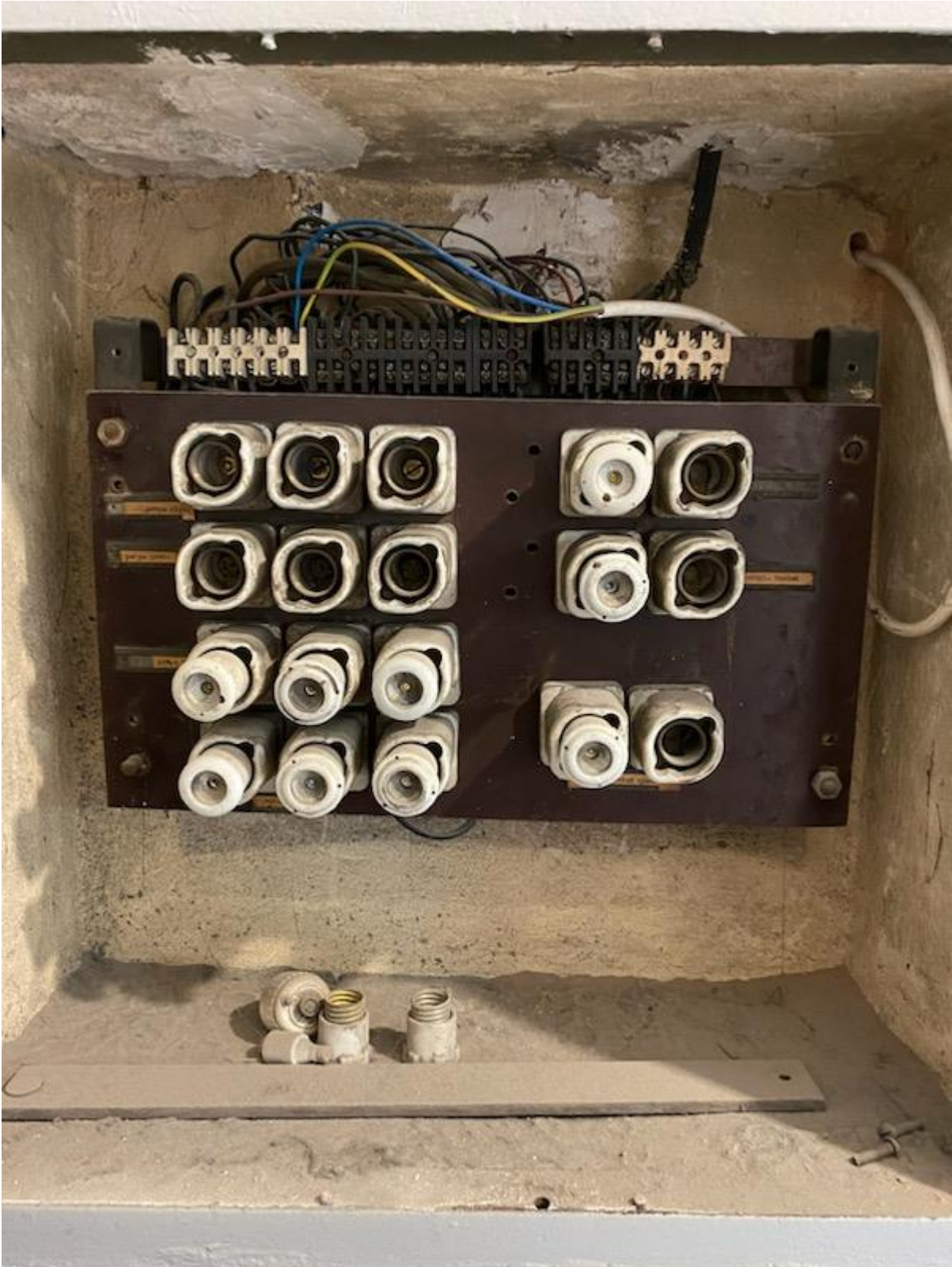
Skrzynka z bezpiecznikami na korytarzu:
