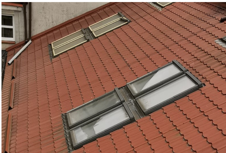
Uszkodzona obróbka okna w górnej części fotografii części oraz wady izolacji w centralnej części okien połaciowych
