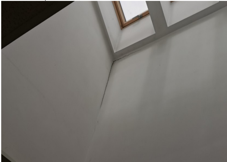
Pęknięcia na styku płyt zabudowy GK
