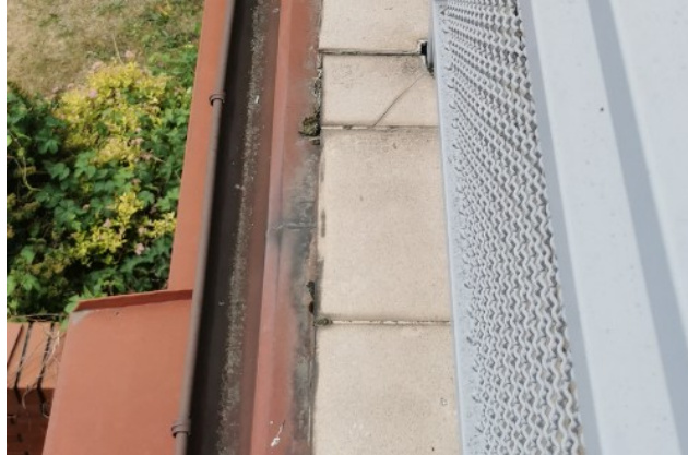
Widoczne zastoiny na obróbkach blacharskich tarasu
