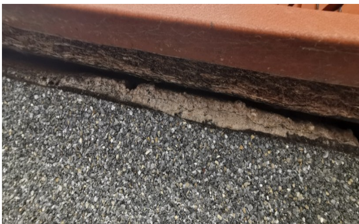
Widoczna płyta OSB z „niedociągniętą” warstwą papy wierzchniego krycia pod obróbkę
