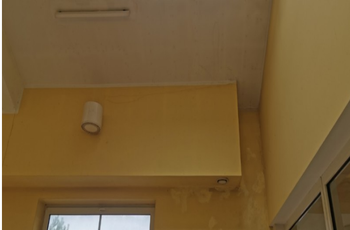
Ślady zawilgoceń występujące w pomieszczeniu jadalni na parterze Źródło: Materiały własne
