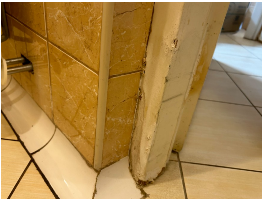
Widoczne uszkodzenia spowodowane wodą – ustawienie futryny na płytce wyklucza oddziaływanie wód gruntowych na ten element Źródło: materiały własne
