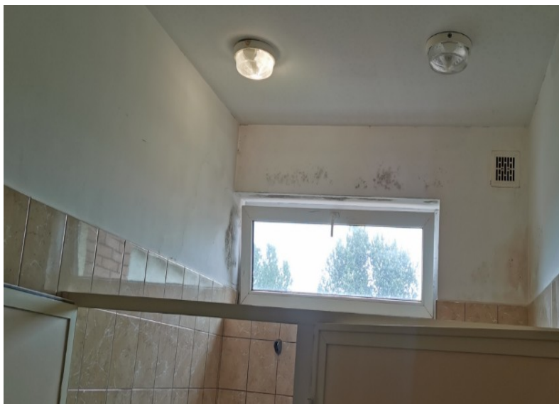
Pokłócie podwyższonej wilgotności w postaci wykwitów mikologicznych w okolicy stolarki
