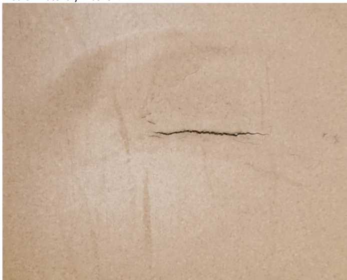
Pęknięcie posadzki z wgłębieniem i przeniesieniem rysy na wykładzinę Źródło: Materiały własne
