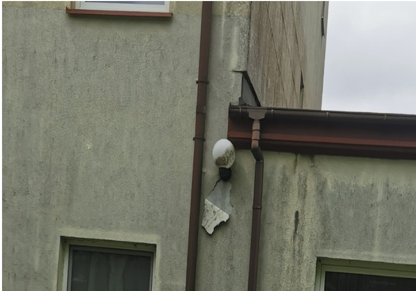
Odwarstwienie wyprawki tynkowej w tym miejscu może być spowodowane skierowaniem wody przez zamontowaną lampę
