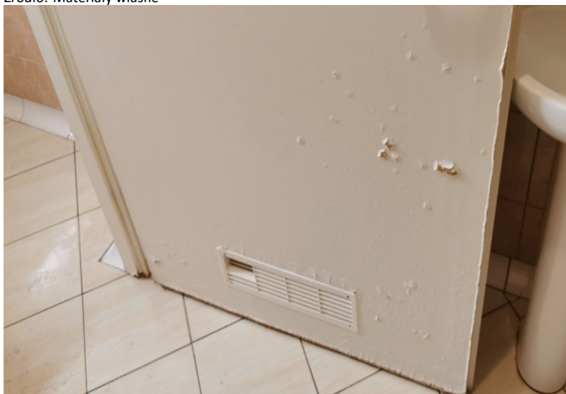
Efekt podwyższonej wilgoci widoczny na drzwiach
