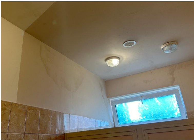
Widoczne zacieki pod sufitem ewidentnie wskazują na źródło zawilgocenia z górnych pomieszczeń Źródło: Materiały własne
