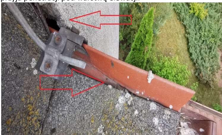
Odspojenie papy na obróbce blacharskiej (dolna strzałka) oraz ścianie atykowej z widoczną szczeliną (górna strzałka) tuż nad zalewanym pomieszczeniem
