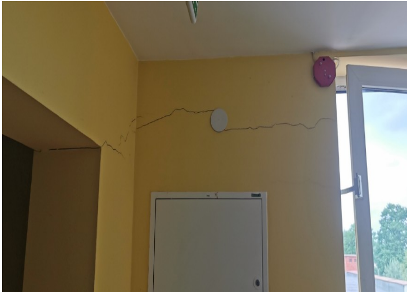
Pęknięcie poziome na najwyższym piętrze budynku
