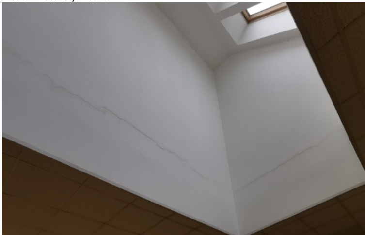
Pęknięcia na płytach zabudowy GK
