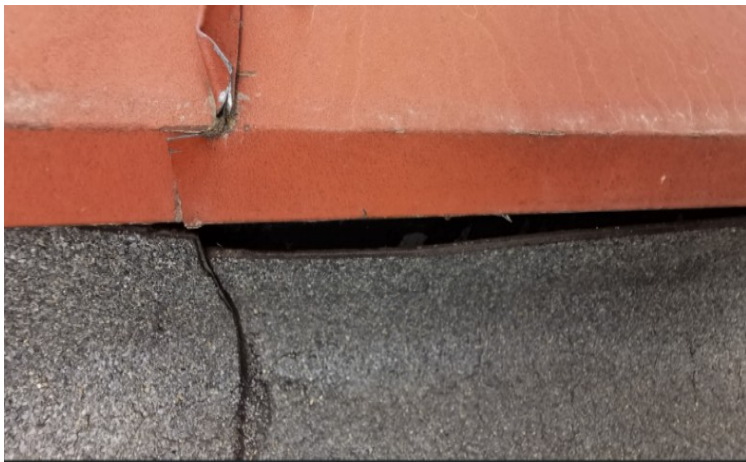
Odspojenie papy na ścianie attykowej
