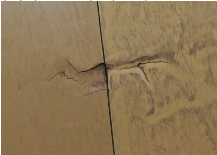
Pęknięcie posadzki z wgłębieniem i przeniesieniem rysy na wykładzinę Źródło: Materiały własne
