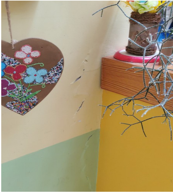
Pęknięcia na styku ścian murowanych
