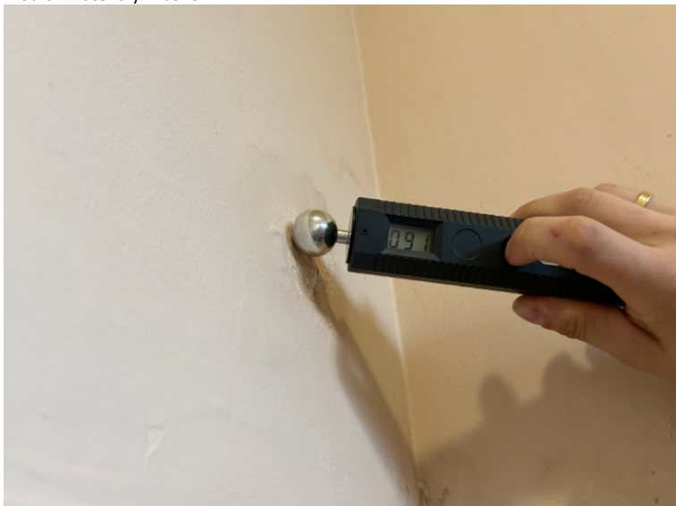
Pomiar wilgotności wskazał obecność ponadnormowej ilości wody w przegrodzie Źródło: Materiały własne
