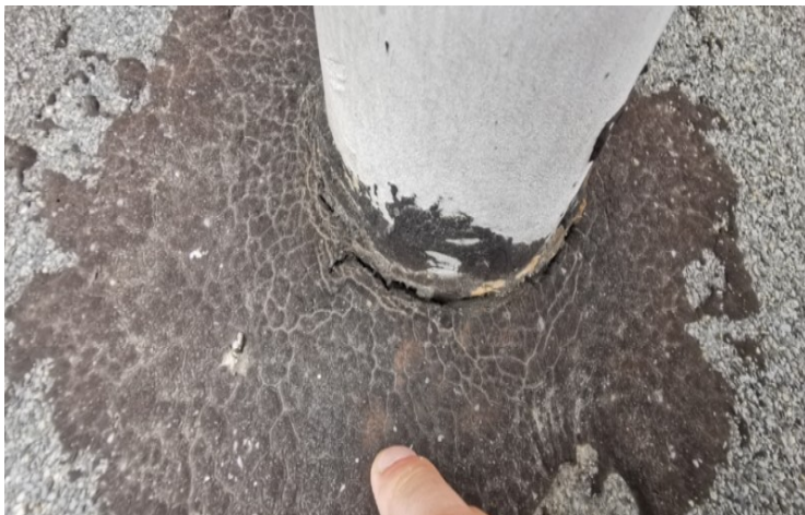
Brak ciągłości izolacji wokół wyprowadzonego kominka – efekt braku wykonanej rozety z papy
