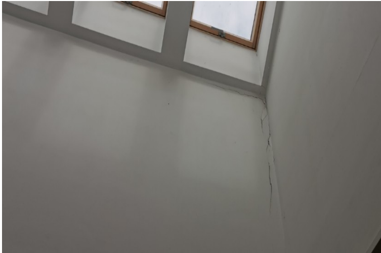
Pęknięcia na płytach zabudowy GK
