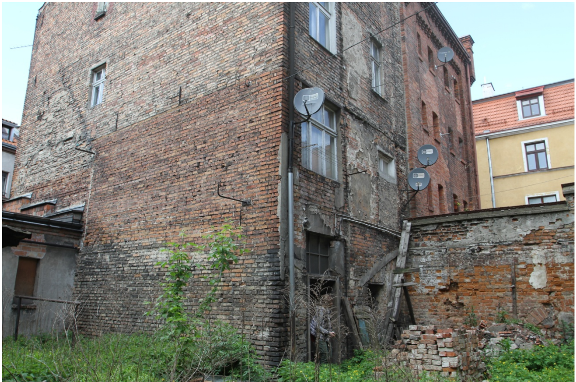
Fot. 12. Elewacja północna i wschodnia, ślady po II kondygnacji i dachu sąsiedniego budynku (fot. Karolina Witkowska).
