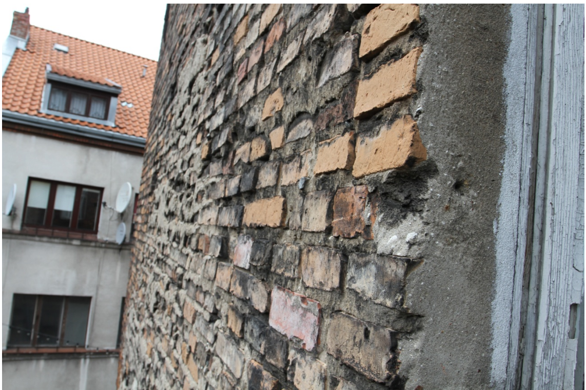
Fot. 13. Elewacja północna ślady po dachu sąsiedniego budynku oraz resztki zapraw mogące wskazywać obecność tynków (fot. Karolina Witkowska).
