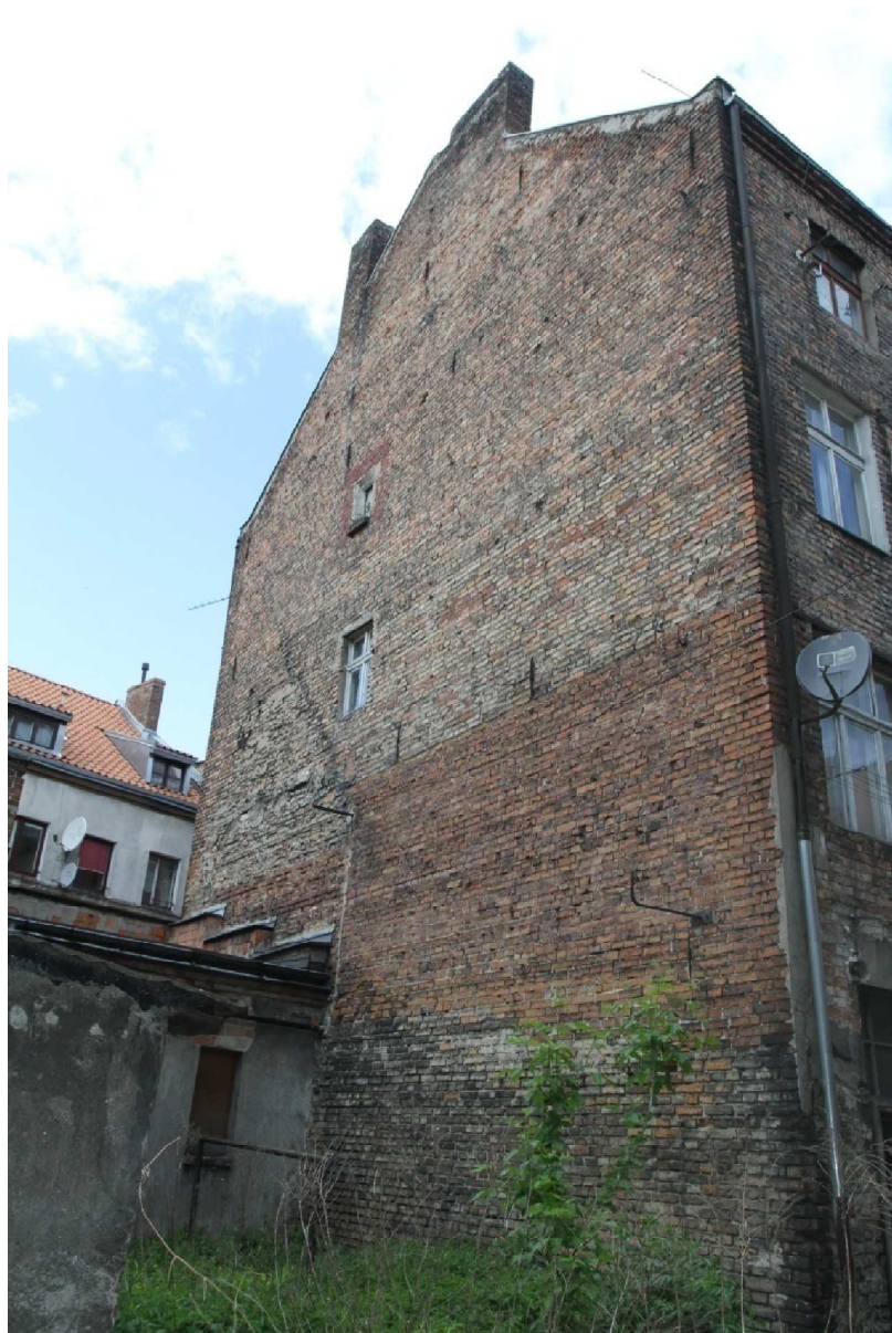
Fot. 8. Elewacja północna budynku przy ul. Spichrzowej 34 w Grudziądzu, widoczna różnica w typie cegieł z pierwszej i drugiej fazy budowy (fot. Karolina Witkowska).
