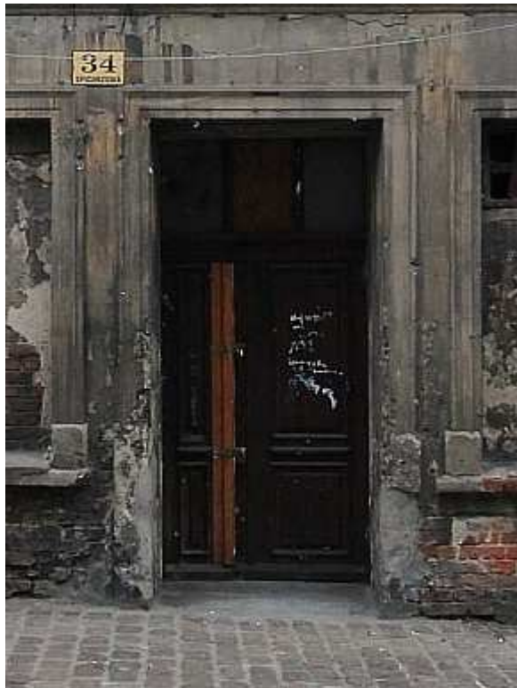
Fot. 2. Drzwi do budynku przy ul. Spichrzowej 34 w Grudziądzu, brak listwy przytykowej i oryginalnych okuć (fot. Karolina Witkowska).
