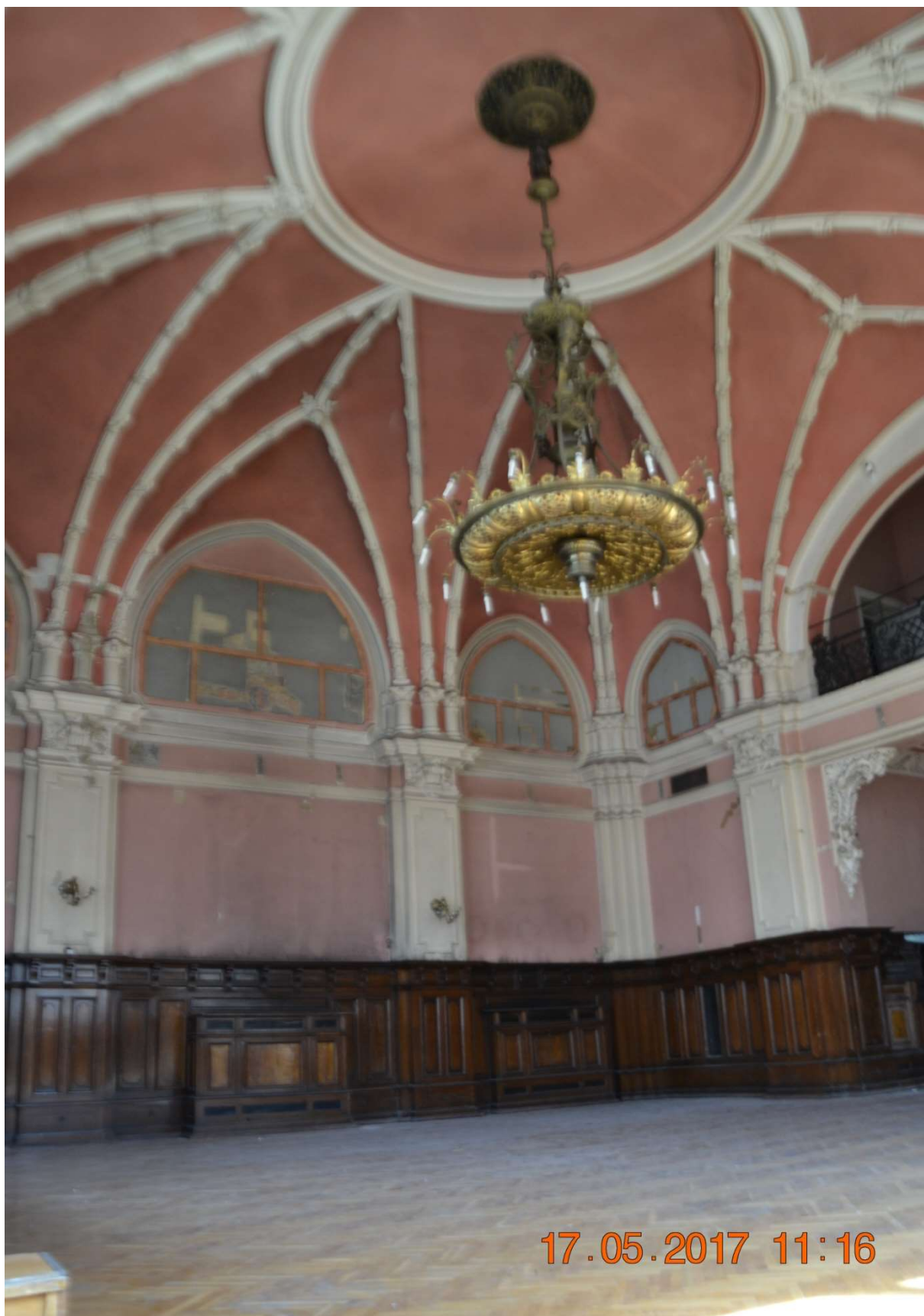
Fot.5 Nad strefą boazerii drewnianej silny pas zabrudzen powierzchniowych spowodowany sezonowym grzaniem. Tynki spękałe drobna siatką w partii sklepienia i ścian.
