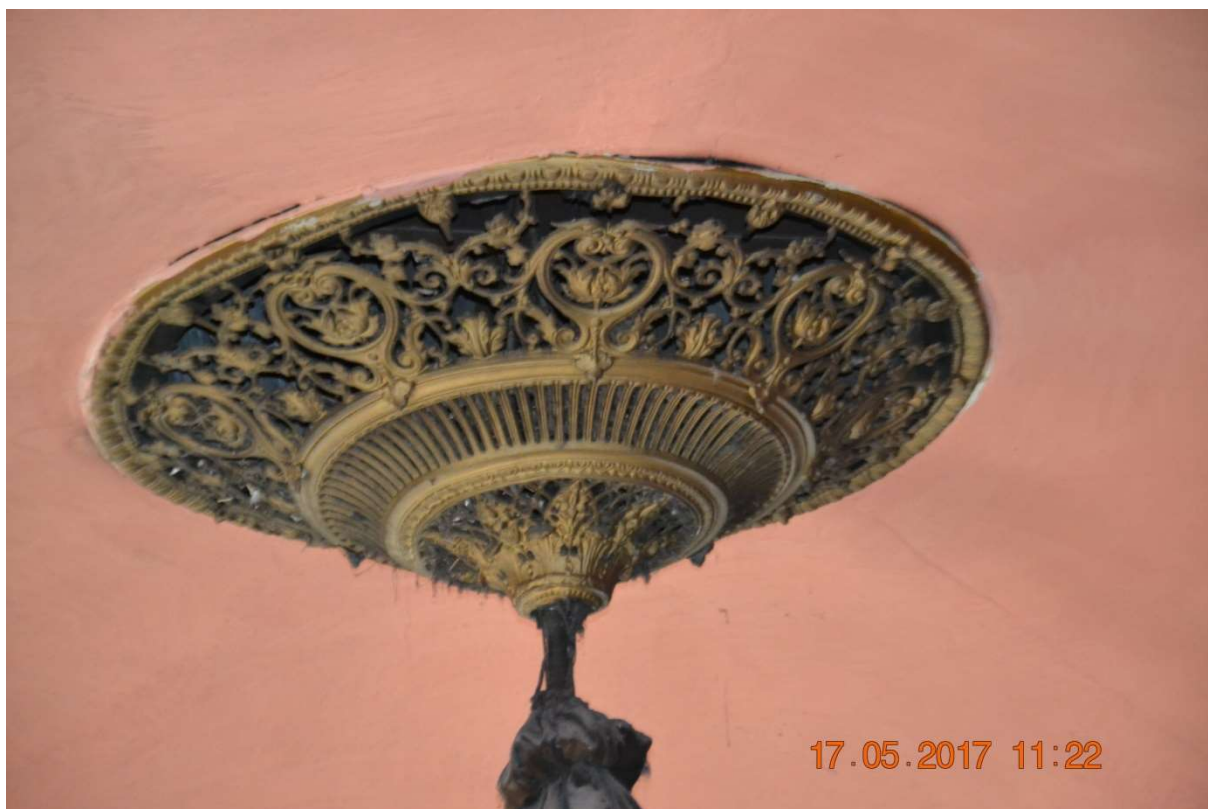
Fot.25 Mosiężny plafon żyrandola, nieestetycznie wykończony. Stan dobry.
