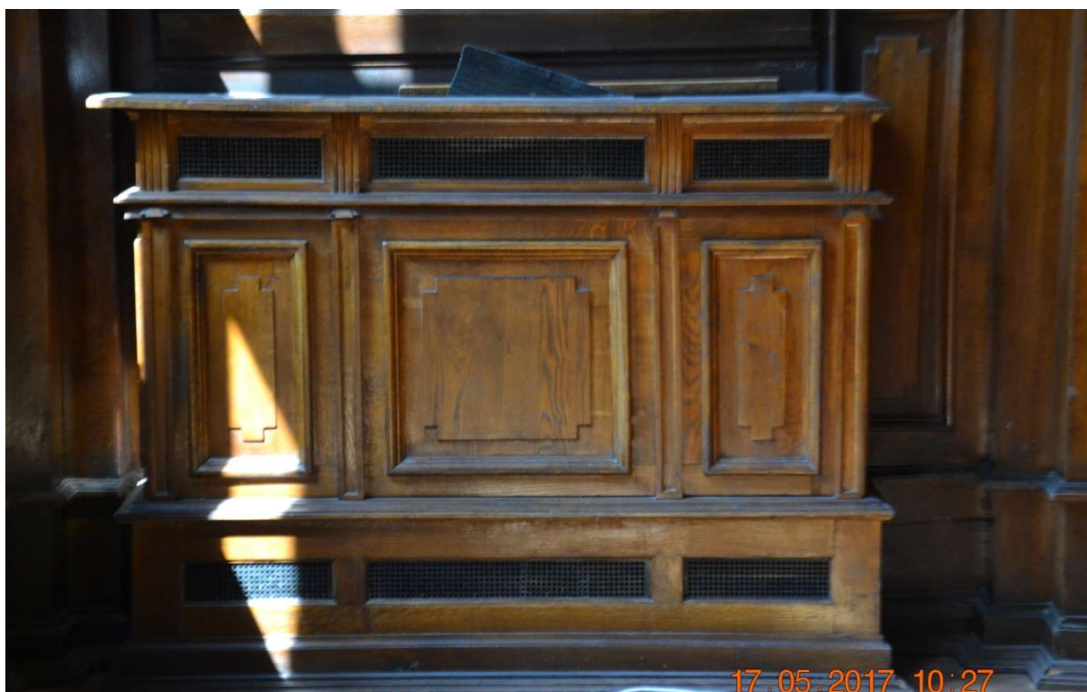
Fot.9 Obudowa kaloryferów, stan lica frontowego, stan dobry, wszystkie łączenia ozdobnych profilowanych listew popękane i porozsychane.
