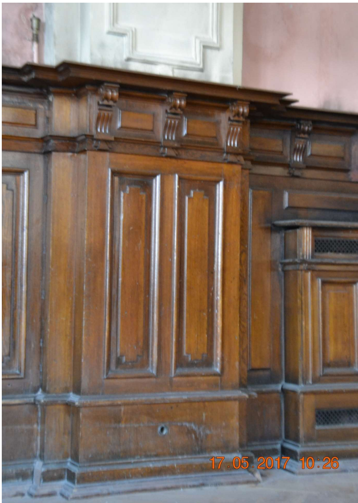
Fot.24 Rozklejenia stolarskie połączeń Litw profilowanych, uszkodzenia mechaniczne, brak politory, rozeschnięcia i spękania drewna.
