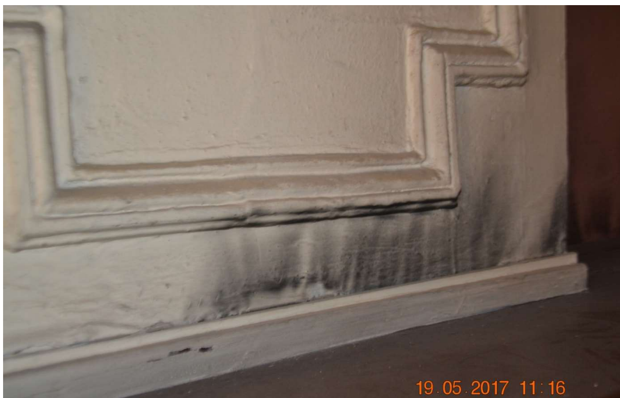
Fot.20 Okopcenia płyciny w strefie nad parapetem gzymsowym boazerii. Profilowane płyciny są zniszczone i zdeformowane.
