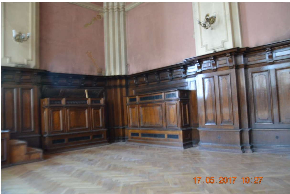
Fot.7 Narożnik północno-wschodni. Tynki odspojone, polichromia spekana i podniesiona daszkowo.
