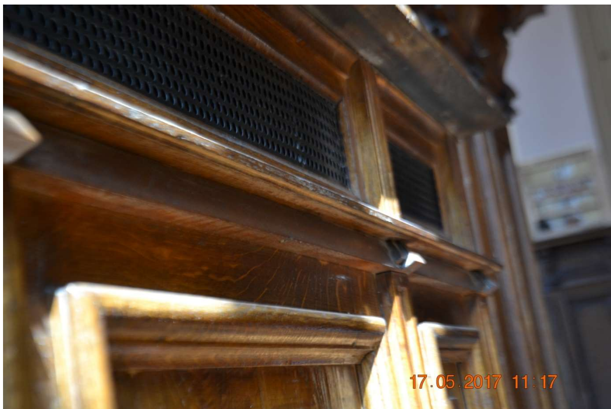
Fot.8 Obudowa grzejników, klapy zamykające od góry grzejnik są bardzo zniszczone, rozeschnięte.
