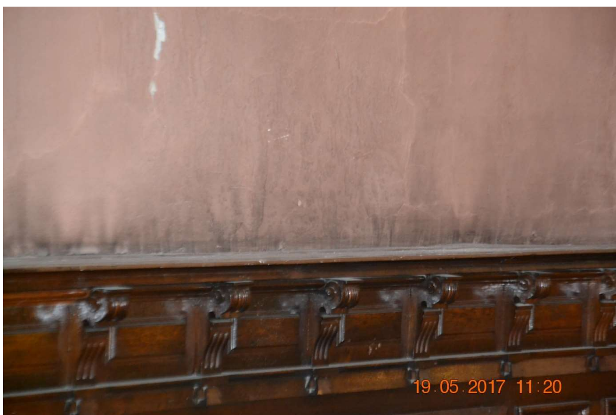
Fot.23 Okopnięcia tynku i spękania tynku przez wszystkie warstwy technologiczne.
