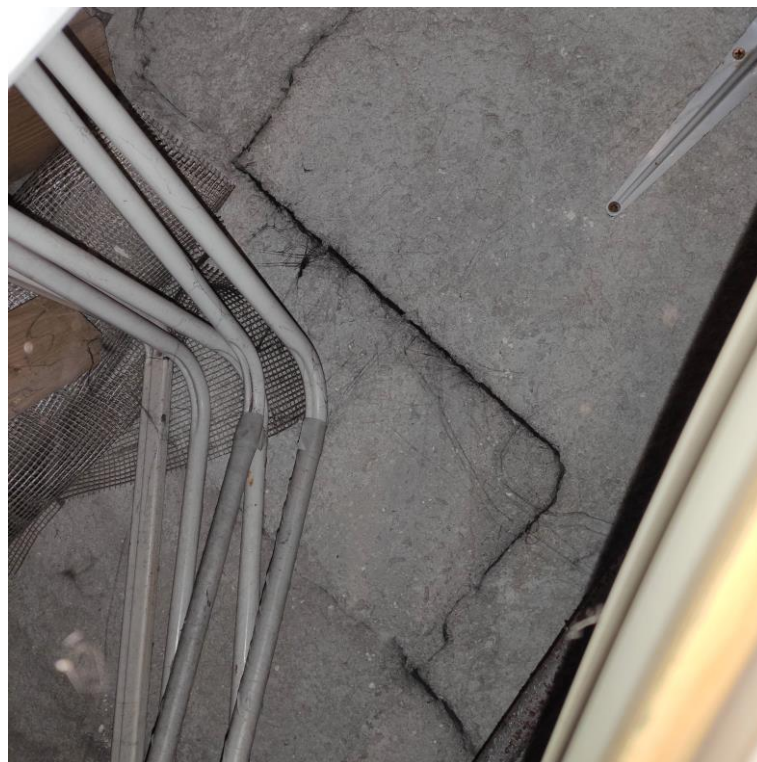
Fot. 4.: Widoczne pęknięcie ściany od strony komórki piwnicznej nr 2.
