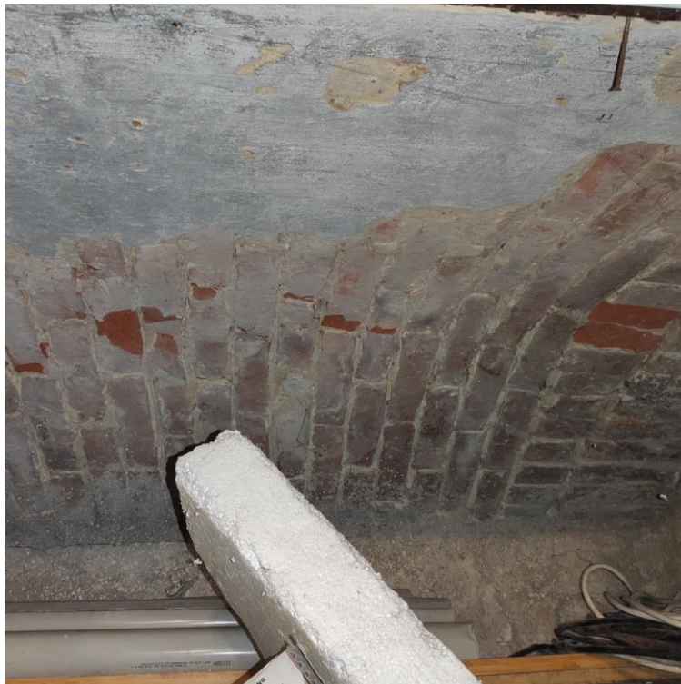
Fot. 3.: Widok na spękanie sklepienie ceglane od strony komórki piwnicznej nr 2. Pęknięcie wzdłuż sklepienia w najwyższym punkcie jego wyniosłości.
