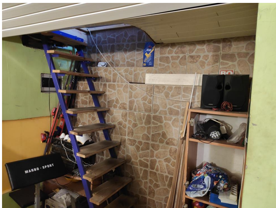
Fot. 5.: Widok na domurowaną ścianę w komórce piwnicznej nr 2. Zejście do komórki poprzez wylaz w stropie z pomieszczenia mieszkalnego (pokój) lokalu mieszkalnego nr 2.
