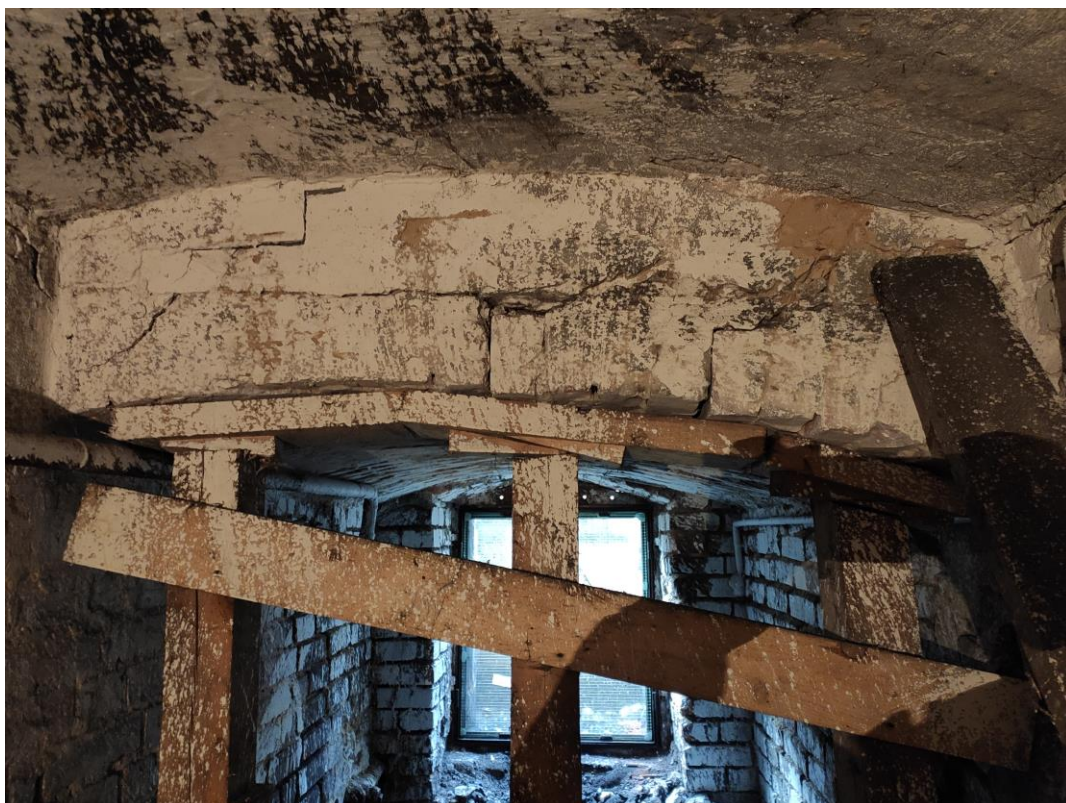
Fot. 1.: Stan sklepienia ceglanoego w komórce piwnicznej przynależnej do lokalu mieszkalnego nr 5. Widoczne wyraźne pęknięcia sklepienia.
