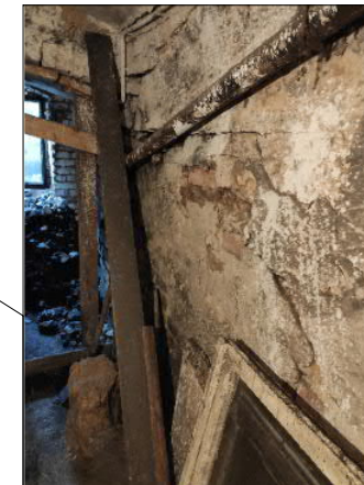
"WYBRZUSZENIE" FRAGMENTU ŚCIANY
