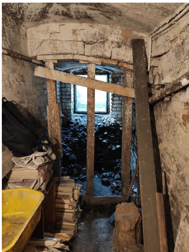
Fot. 3.: Podparcie ceglanego sklepienia. Widoczne osunięcie sklepienia w kierunku „wybrzuszonej” ściany.
