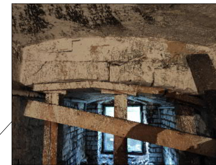
STAN SKLEPIENIA CEGLANEGO Z WIDOCZNYM PODPARCIEM
