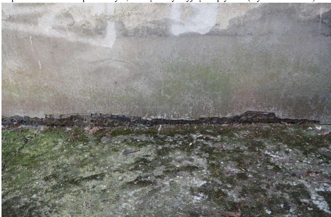
Fot. 19. Gorzów Wlkp. ul. Drzymały 32, elewacja od podwórza, folia kubelkowa wystająca ponad poziom podwórza (wyk. P. Antoniuk).
