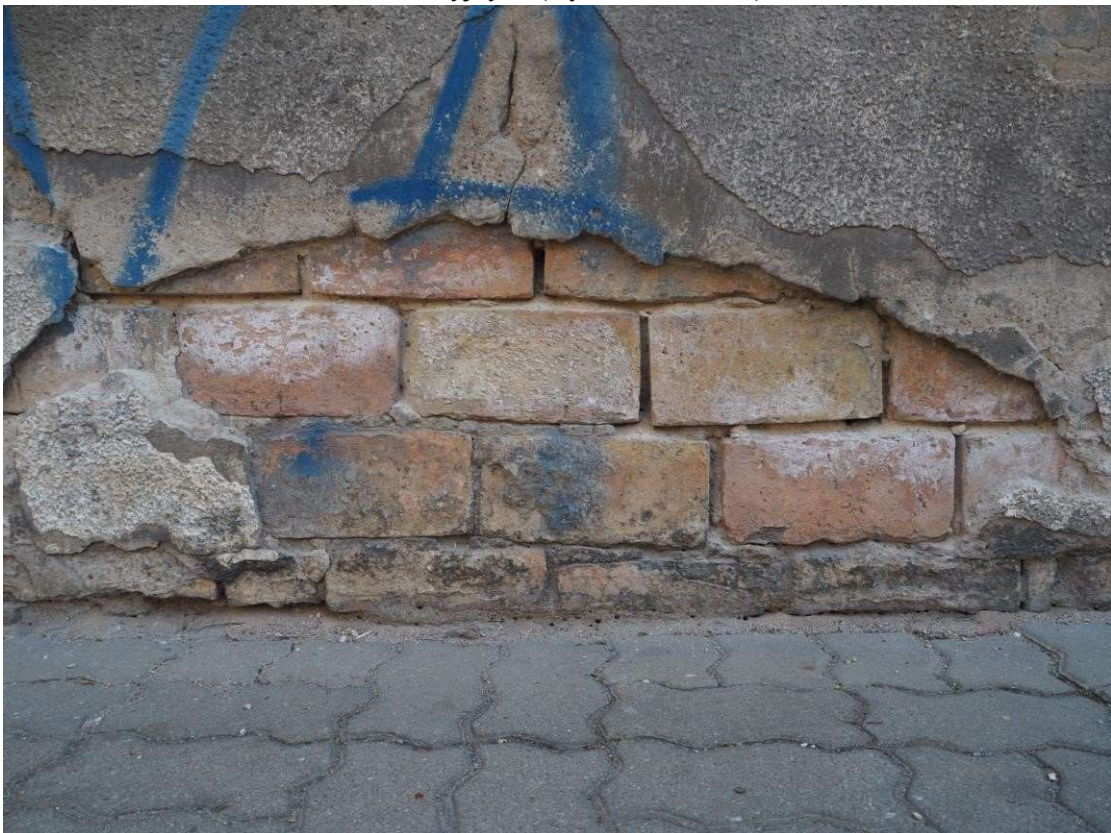
Fot. 9. Gorzów Wlkp. ul. Drzymały 32, fasada, braki tynku, wysolenia na powierzchni cegieł (wyk. P. Antoniuk).
