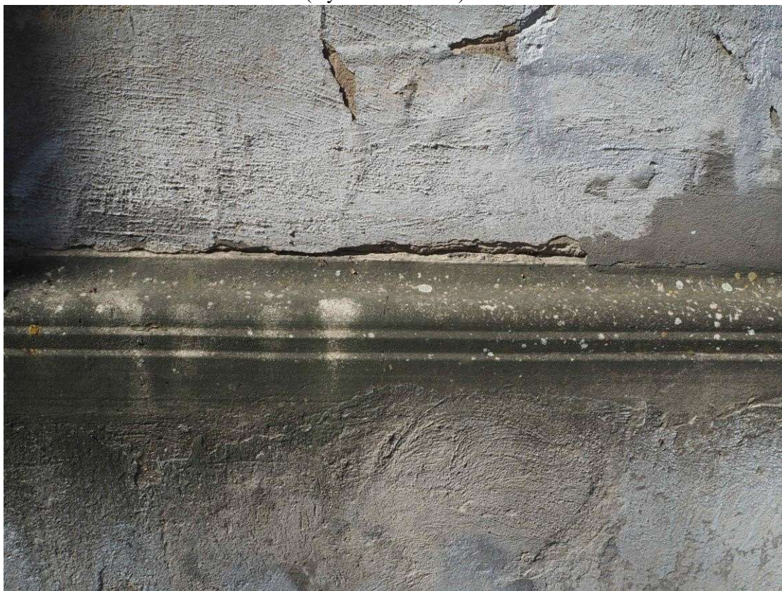
Fot. 17. Gorzów Wlkp. ul. Drzymały 32, elewacja od podwórza, dolny gzyms cokołu (wyk. P. Antoniuk).
