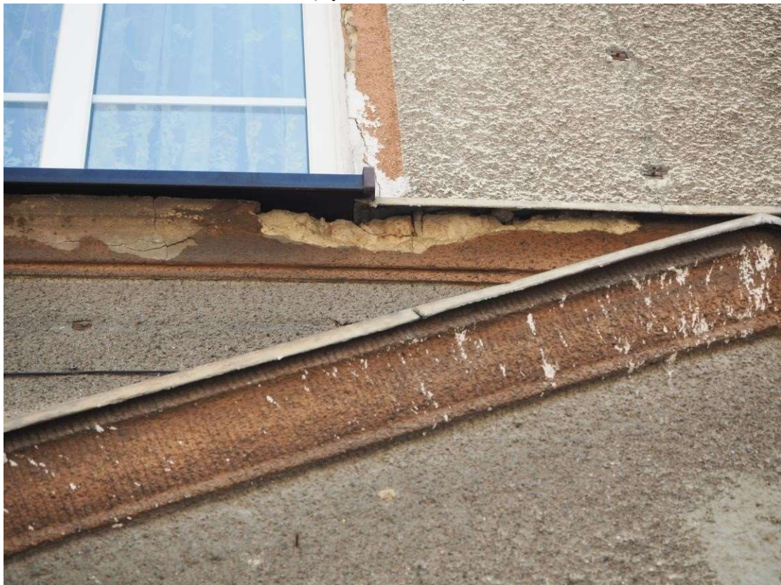
Fot. 7. Gorzów Wlkp. ul. Drzymały 32, fasada, ubytki gzymsu (wyk. P. Antoniuk).
