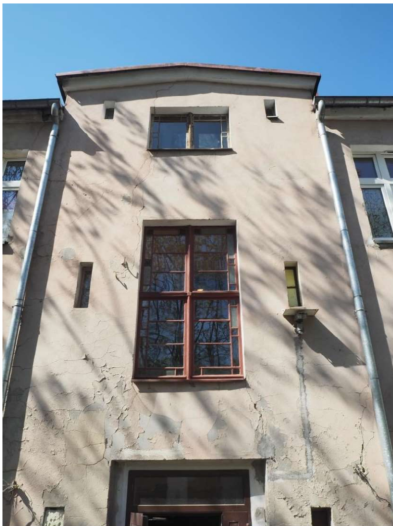
Fot. 14. Gorzów Wlkp. ul. Drzymały 32, elewacja od podwórza, zabytkowa stolarka okienna, pęknięcia konstrukcyjne, łuszczenie farby (wyk. P. Antoniuk).
