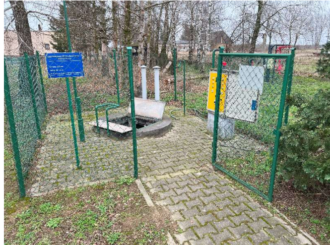
Rys. 14. Przepompownia PS Miniszewo– stan istniejący.
