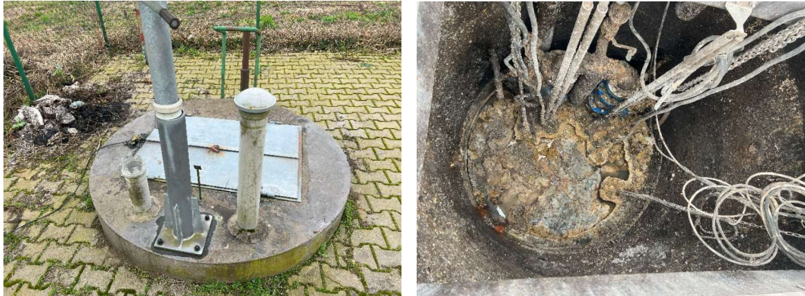
Rys. 12. Przepompownia PS Sarbinowo Drugie– stan istniejący.
