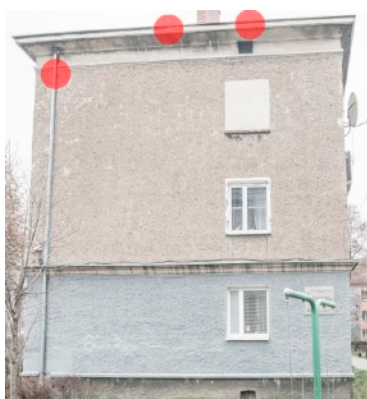
Fot. 4. Budynek ul. Wojska Polskiego 3, 3a w Tarnowskich Górach. Zaznaczono potencjalne siedliska lęgowe jerzyka - czerwone punkty.
