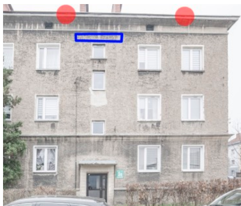
Fot. 3. Budynek ul. Wojska Polskiego 3, 3a w Tarnowskich Górach. Zaznaczono potencjalne siedliska lęgowe jerzyka - czerwone punkty. Propozycja zlokalizowania budek lęgowych dla jerzyka - niebieska ramka.
