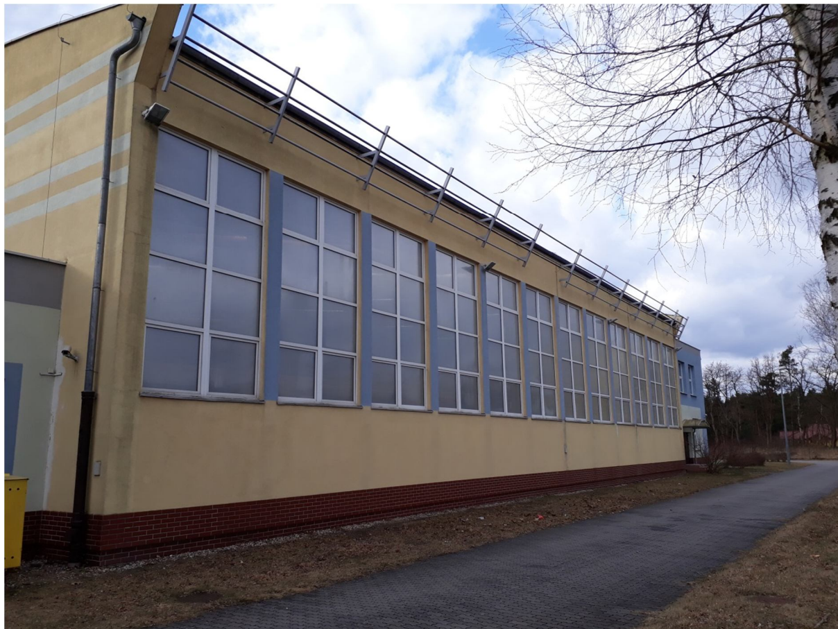
Zdjęcie nr 13 – Widok na elewację wschodnią budynku D. Widoczny brak elementów stalowych przy okapie.
