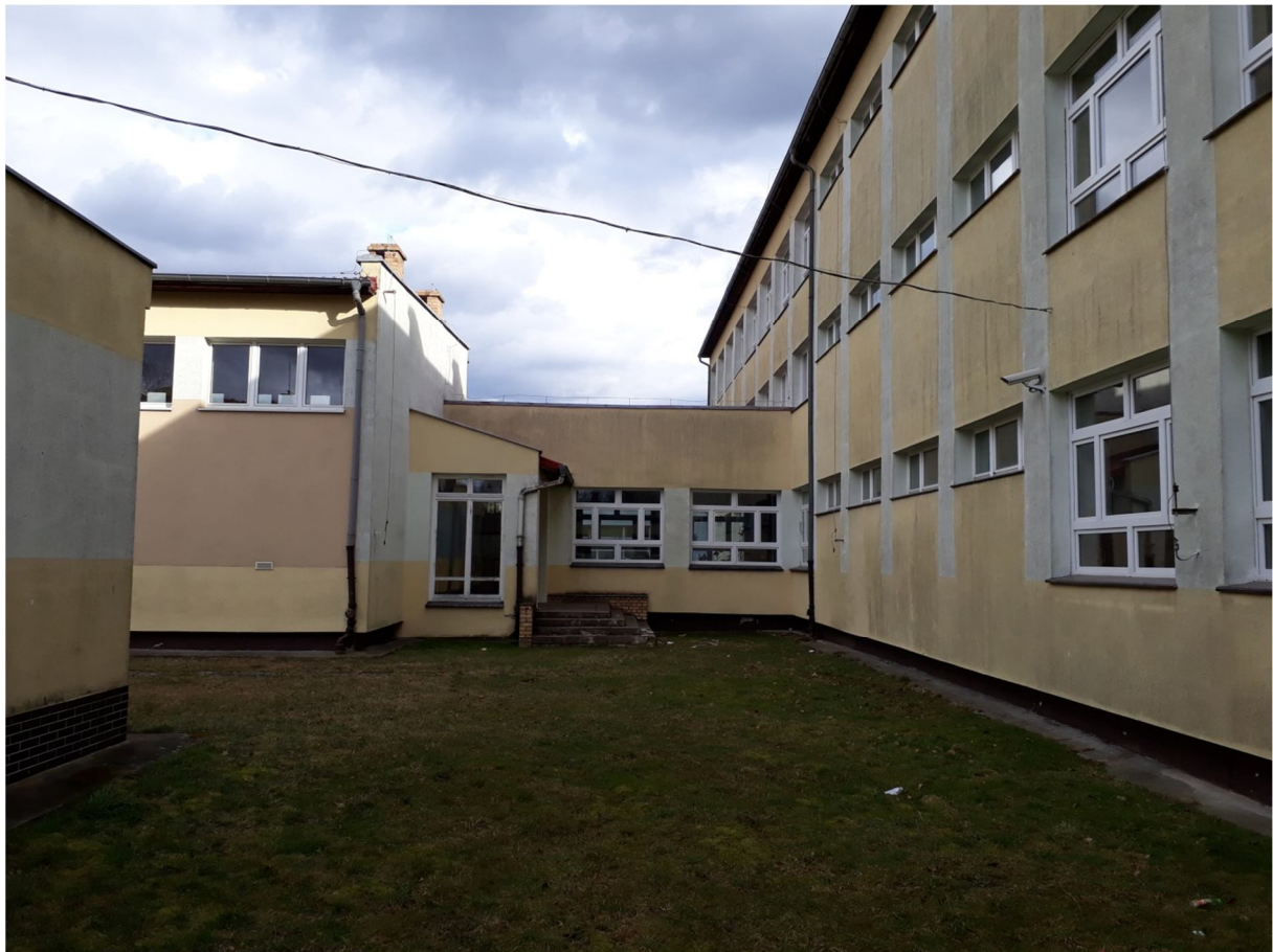
Zdjęcie nr 26 – Widok na łącznik pomiędzy budynkiem A i B. Widoczne schody do budynku B, przewiduje się wykonanie na nich nowej nawierzchni z płytek ceramicznych.
