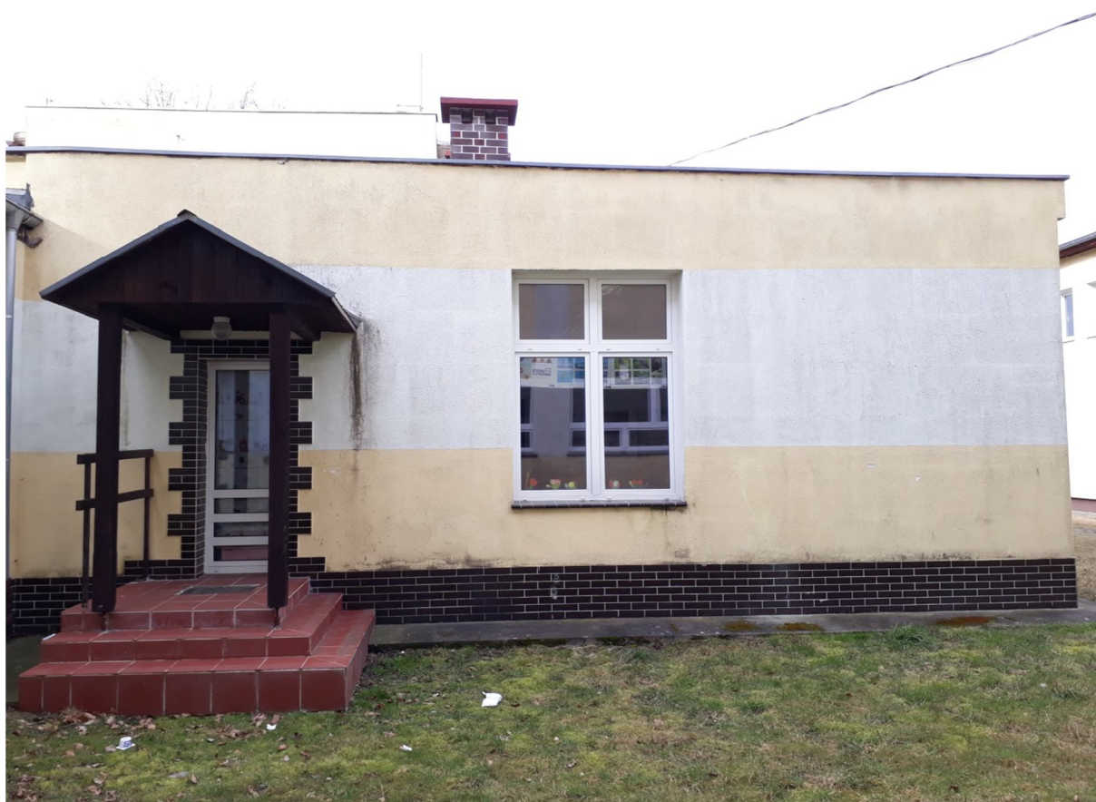
Zdjęcie nr 29 – Widok na elewację południową budynku C. Widoczne zacieki z nieprawidłowej obróbki blacharskiej daszku nad wejściem.
