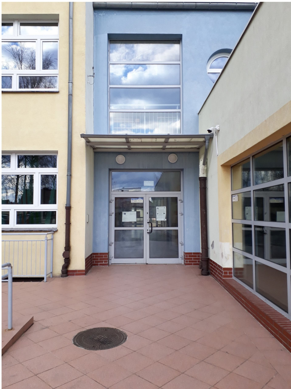
Zdjęcie nr 5 – Widok na strefę wejściową do budynku D. Po prawej przeciekająca rura spustowa do naprawy. Naprawa ma na celu usunięcie powstających zacieków na wyprawie tynkarskiej i płytkach klinkierowych.
