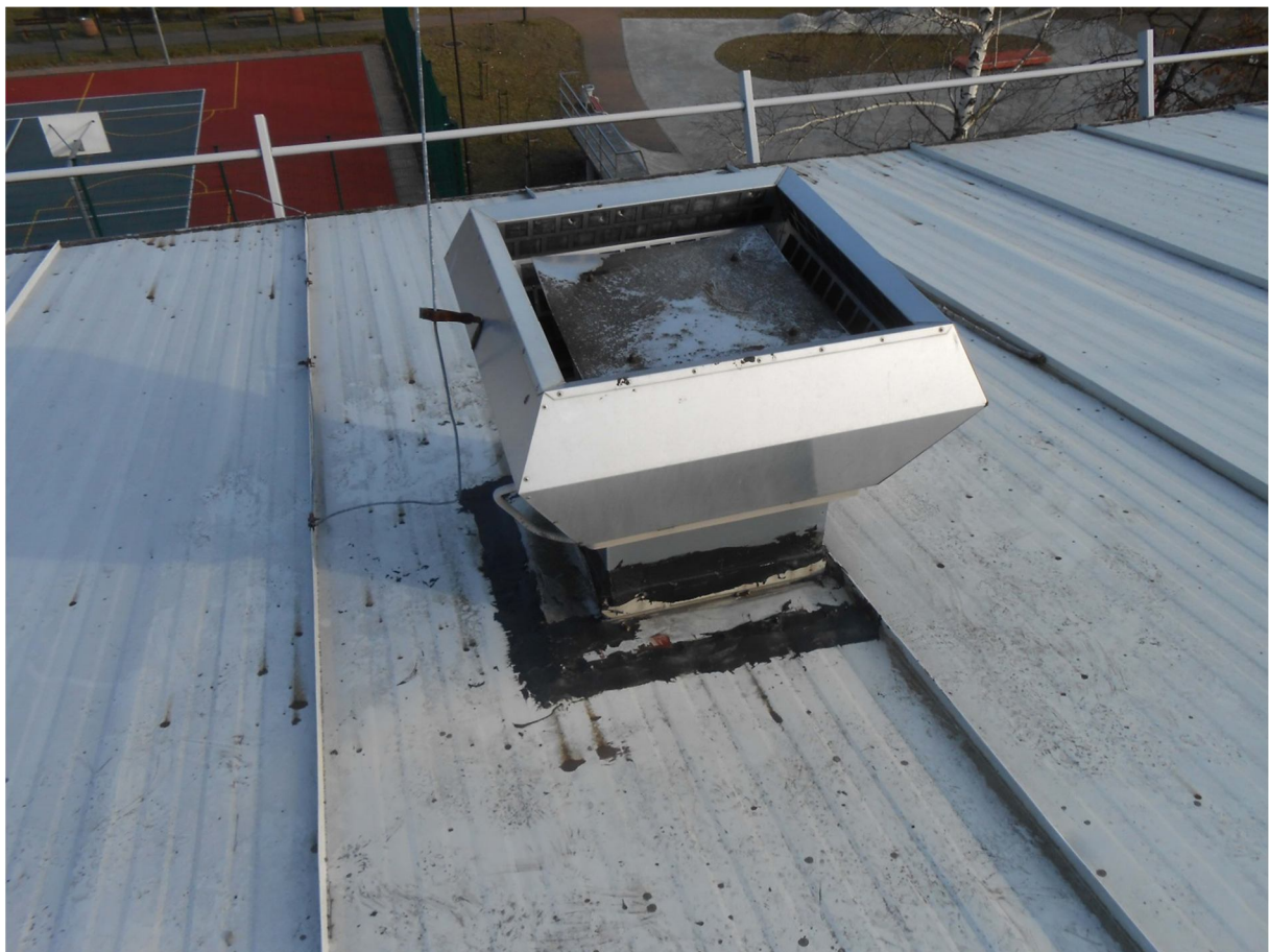
Zdjęcie nr 47 – Widok na uszkodzenia warstwy zewnętrznej pokrycia dachowego sali gimnastycznej budynku D.
