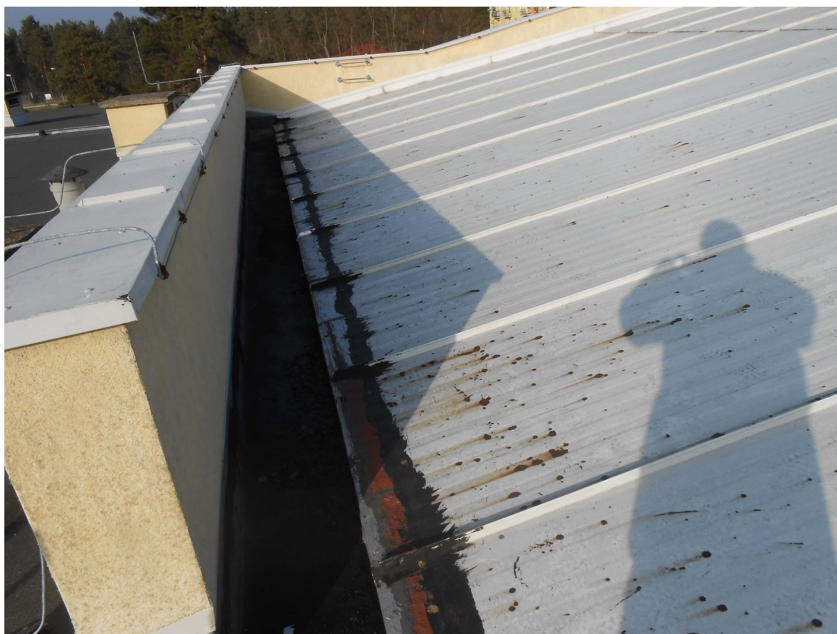
Zdjęcie nr 43 – Widok na uszkodzenia warstwy zewnętrznej pokrycia dachowego sali gimnastycznej budynku D.
