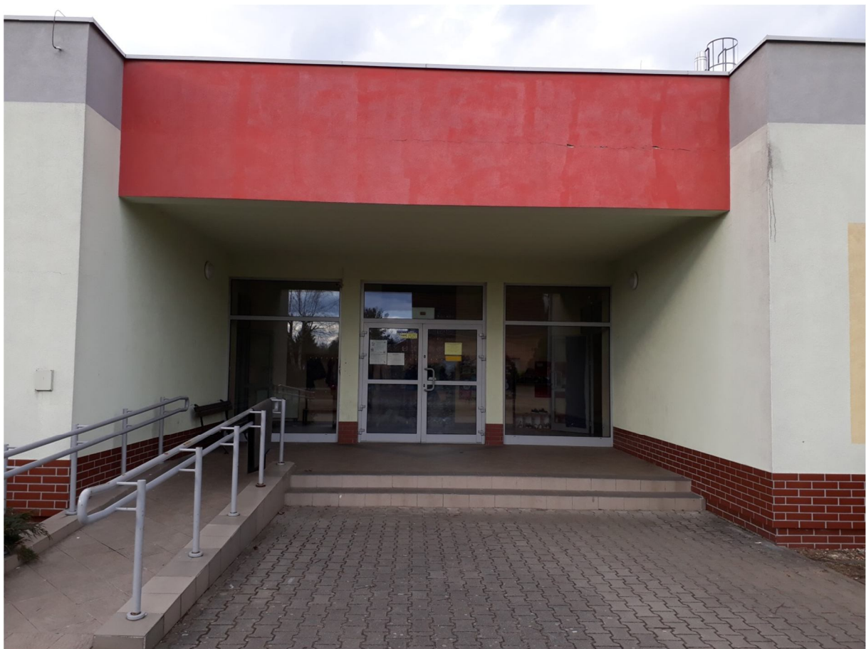
Zdjęcie nr 11 – Widok na frontową strefę wejściową do budynku D. Widoczne spękania muru do naprawy.
