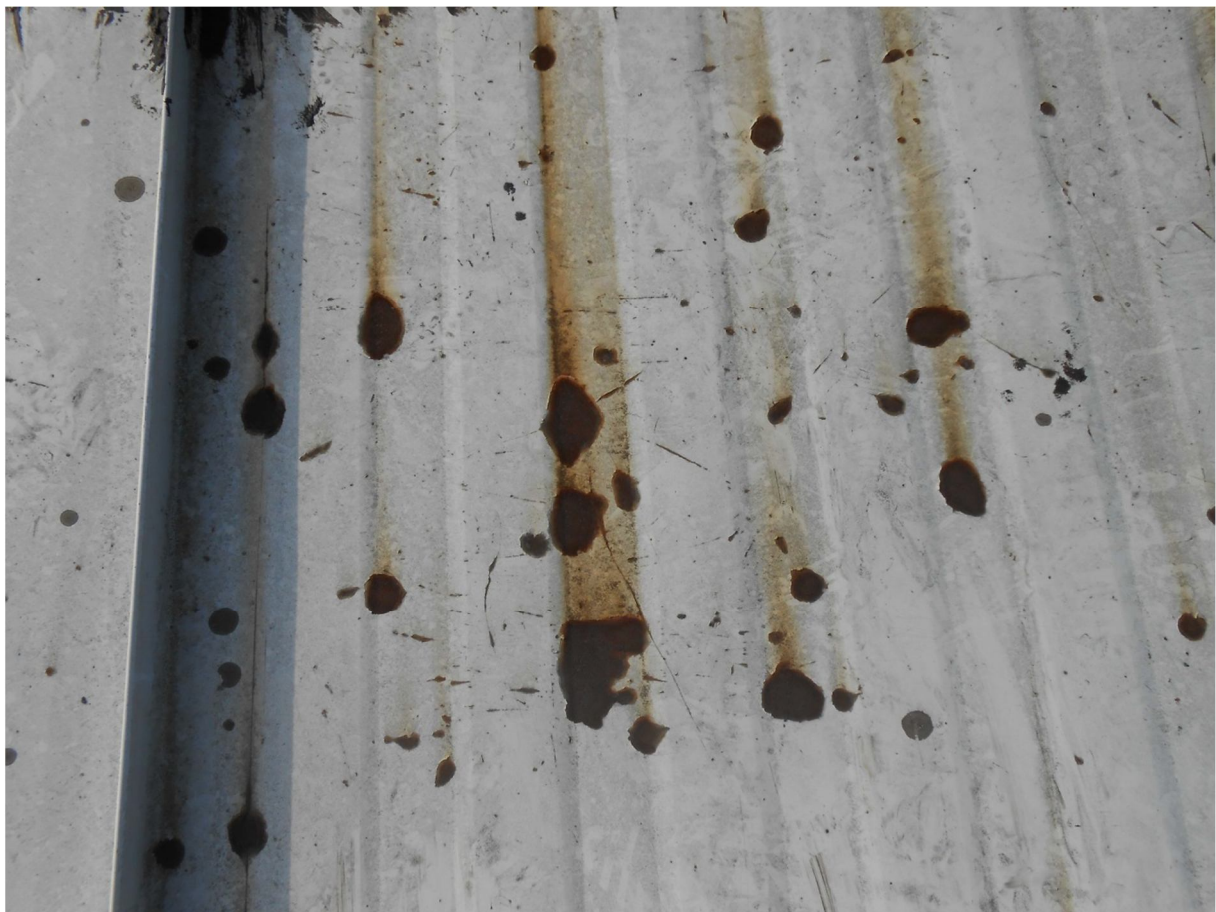
Zdjęcie nr 49 – Widok na uszkodzenia warstwy zewnętrznej pokrycia dachowego sali gimnastycznej budynku D.
