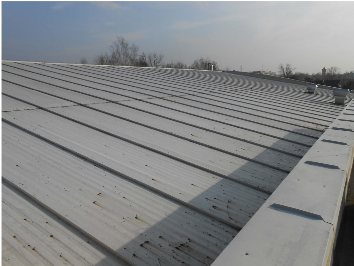
Zdjęcie nr 44 – Widok na uszkodzenia warstwy zewnętrznej pokrycia dachowego sali gimnastycznej budynku D.
