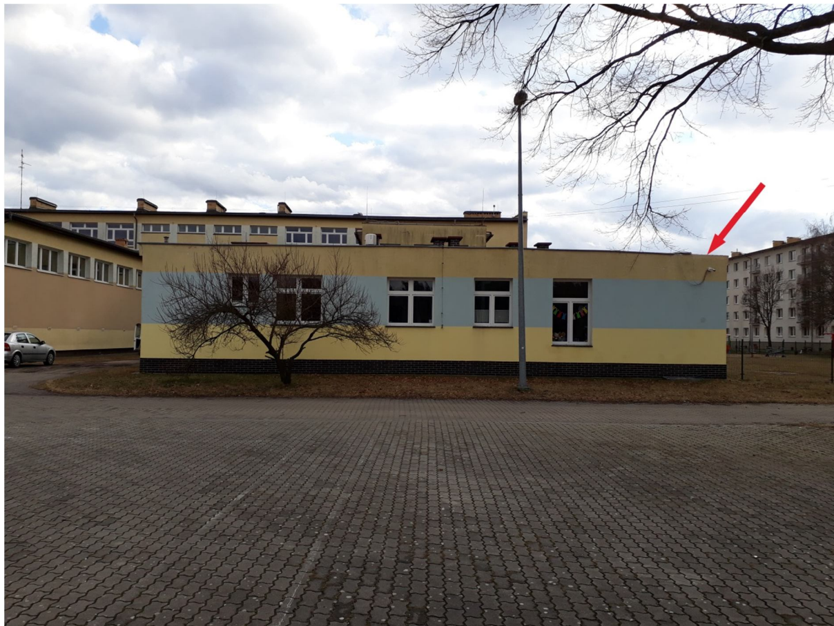
Zdjęcie nr 31 – Widok na elewację północną budynku C. W głębi budynek A i po lewej budynek B. Strzałką wskazano miejsce brakującej obróbki blacharskiej.
