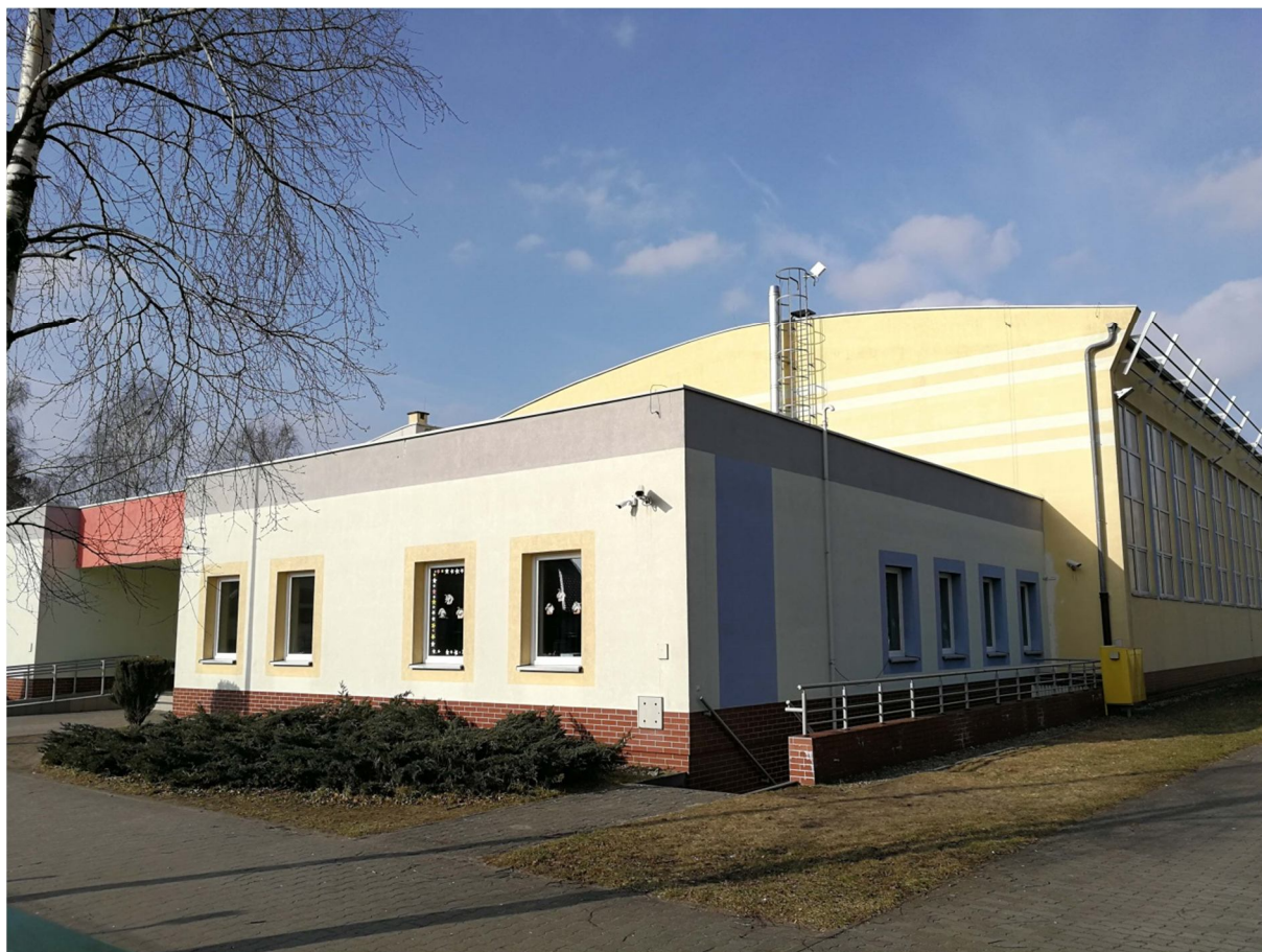
Zdjęcie nr 12 – Widok na narożnik południowo-wschodni budynku D. Widoczne na pierwszym planie wykwyty na płytce klinkierowej murku (przewidziane do usunięcia).
