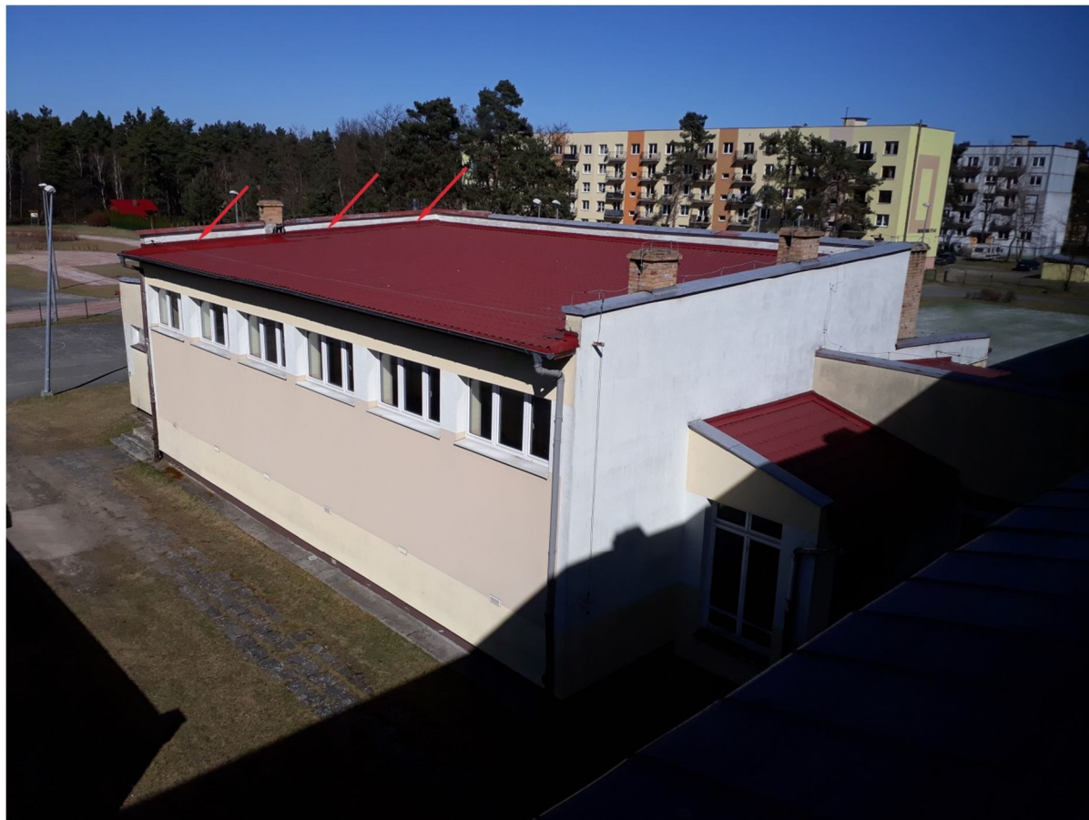
Zdjęcie nr 40 – Widok na przeciekające pokrycie dachowe budynku B. Strzałkami zaznaczono miejsce przecieku, braku obróbki blacharskiej.
