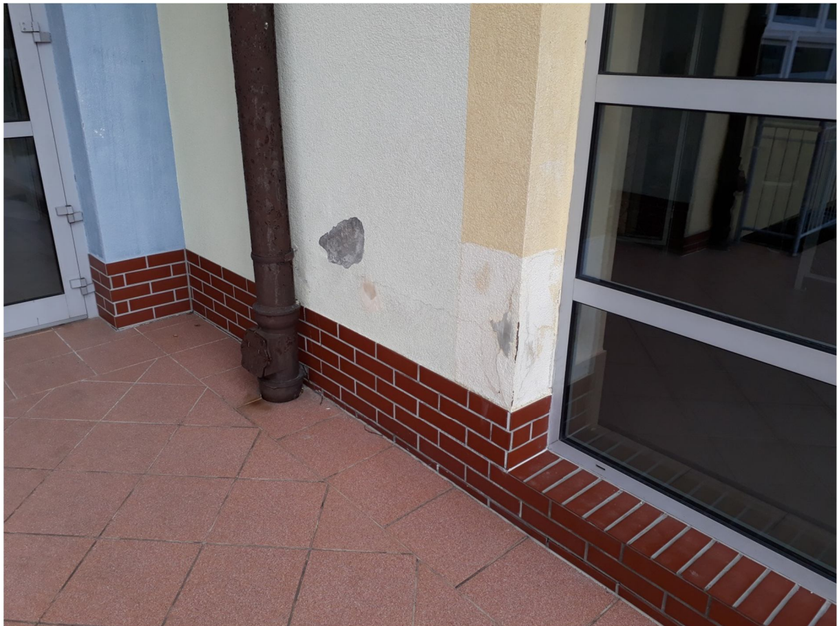
Zdjęcie nr 6 – Widok na ubytki w wyprawie tynkarskiej. Rurę spustową w kolorze brązowym należy oczyścić i pomalować zgodnie z projektem.
