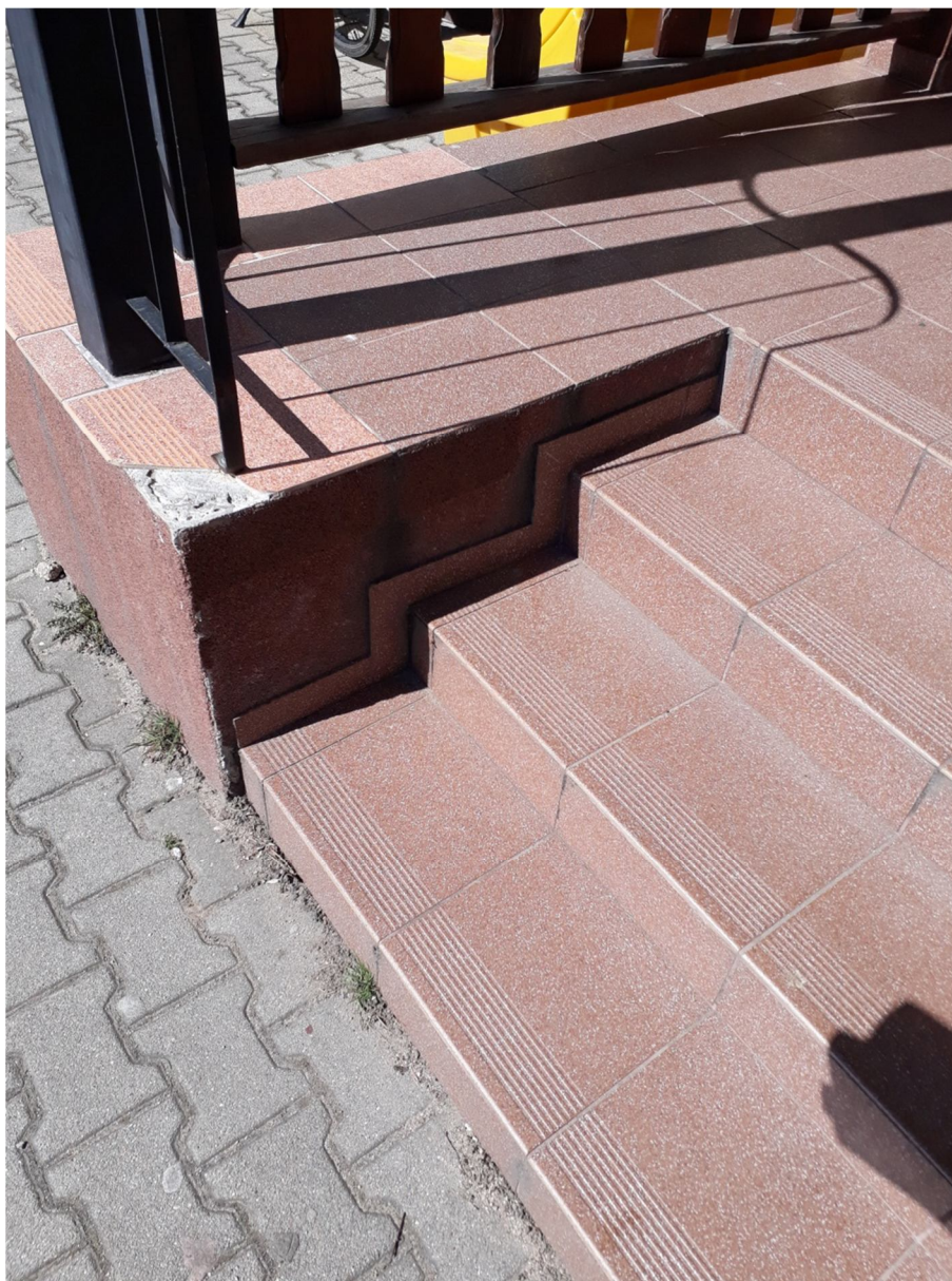
Zdjęcie nr 50 – Widok na podest głównego wejścia do budynku A. Widoczne uszkodzenie płytki ceramicznej oraz odbiegająca od całości kolorystyka kilku płytek.
