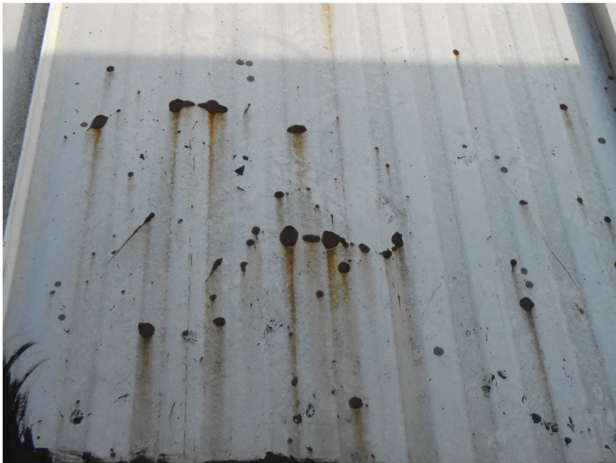
Zdjęcie nr 45 – Widok na uszkodzenia warstwy zewnętrznej pokrycia dachowego sali gimnastycznej budynku D.
