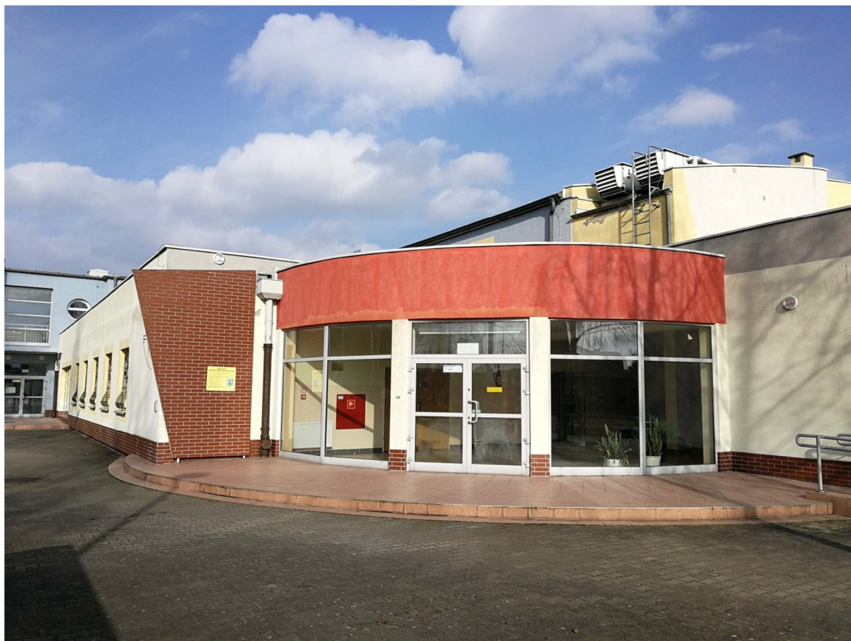
Zdjęcie nr 8 – Widok na półokrągłą strefę wejściową do budynku D. Widoczne ubytki w wyprawie tynkarskiej i powłoce malarskiej m.in. rury spustowej.
