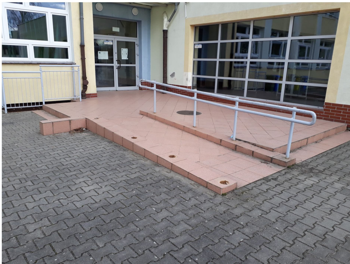
Zdjęcie nr 51 – Widok na wyjęty pochwyt pochylni dla niepełnosprawnych. Należy zmienić sposób mocowania na solidny i powtórzenie osadzić wyjęty element (identyczny jak z drugiej strony pochylni).
