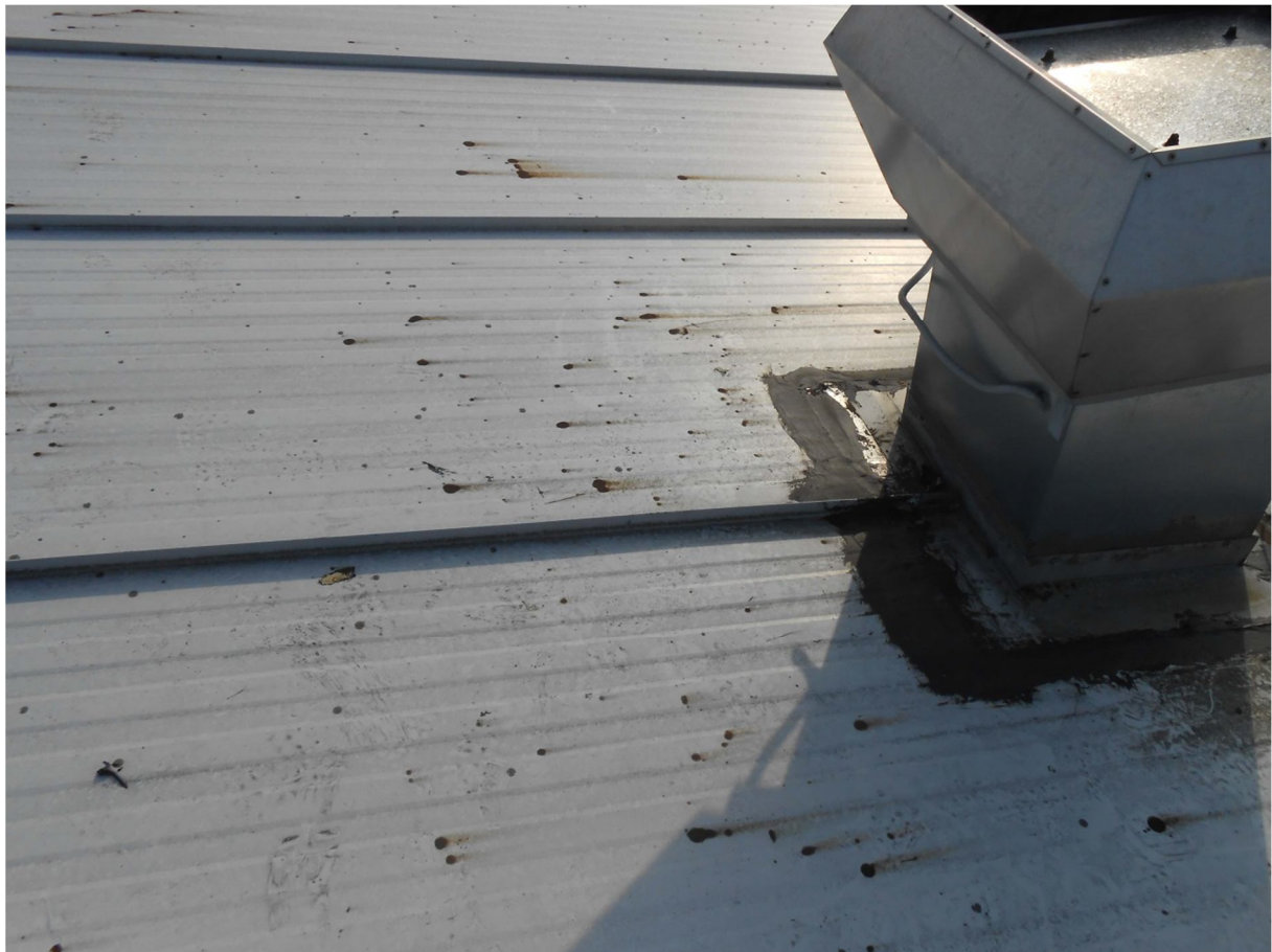
Zdjęcie nr 46 – Widok na uszkodzenia warstwy zewnętrznej pokrycia dachowego sali gimnastycznej budynku D.
