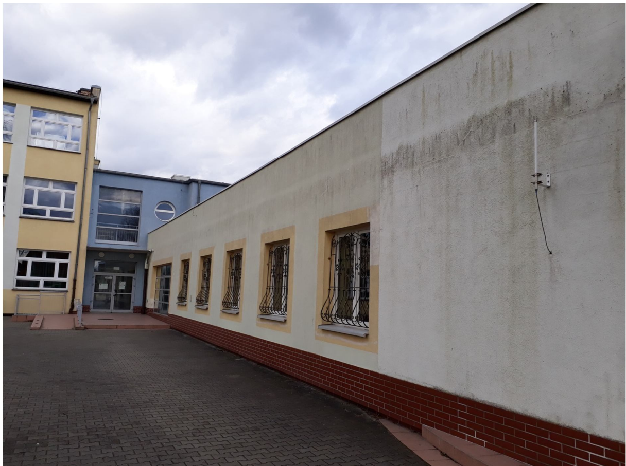
Zdjęcie nr 7 – Widok na elewację zachodnią budynku D. Widoczne ubytki w wyprawie tynkarskiej.
