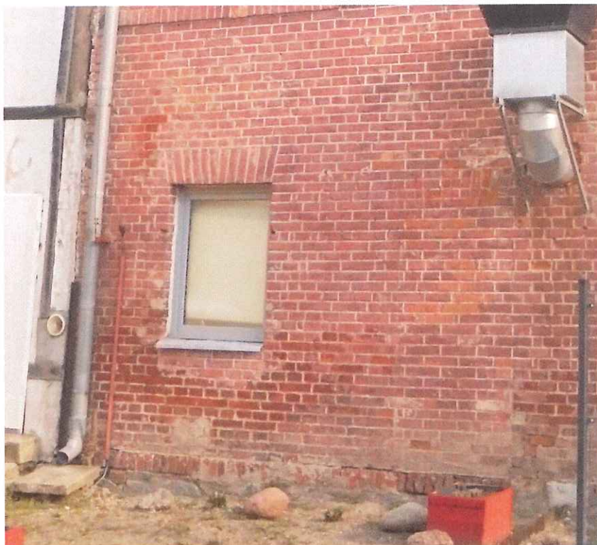
11. Ściana południowa – stan lica ceglanego, ubytki w murze fundamentowym, i zniszczenia elewacji współczesnej dobudówki.
