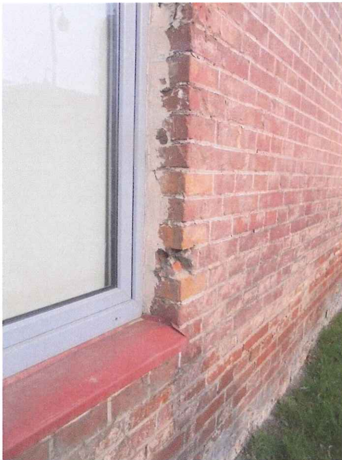
6. Osadzenie współczesnych okien. Cementowe zaprawy, mechaniczne uszkodzenia cegieł, parapety z blachy powlekanej. Brak opaski żwirowej.
