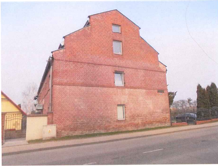
3. Elewacja wschodnia. Widoczne zniszczenia lica ceglanego, przemurowania, obtłuczenia.
