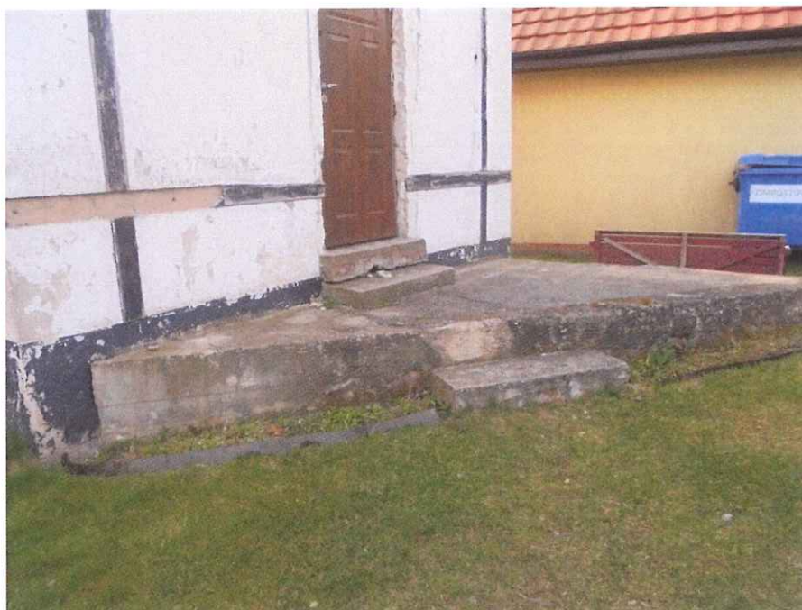
12. Elewacja zachodnia współczesnej dobudówki. Okładzina elewacyjna – płyty cementowe, ubytki drewna – imitacji ryglówki, zniszczenia tynku, współczesna stolarka drzwiowa, betonowe schody wejściowe.
