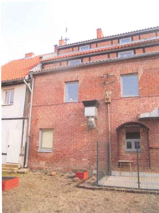
4. Elewacja południowa, narożnik zachodni. Widoczne fragmenty kamiennego cokołu, Zniszczenie lica ceglanego, współczesne instalacje. Współczesna stolarka okienna.
