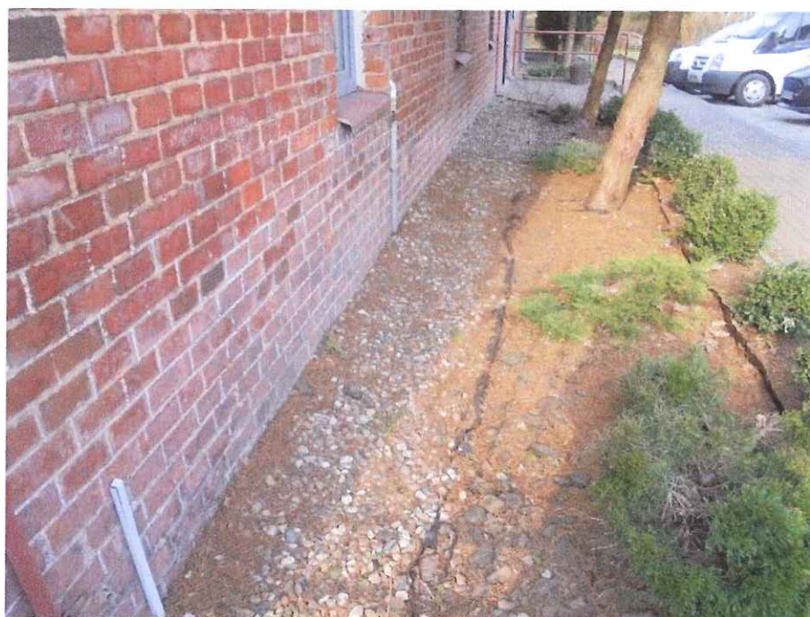
7.8 , Stan muru ceglanego. Znacznie podniesiony poziom gruntu w stosunku do poziomu pierwotnego. Opaska żwirowa przerośnięta roślinnością i pokryta humusem.
