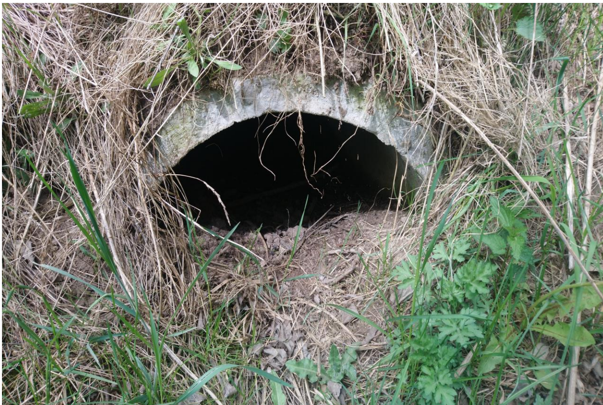
Foto nr 6 Odcinek DG 103610B – wlot przepustu Ø60 o L=7,0m z kręgów żelbetowych w km 1+550.
