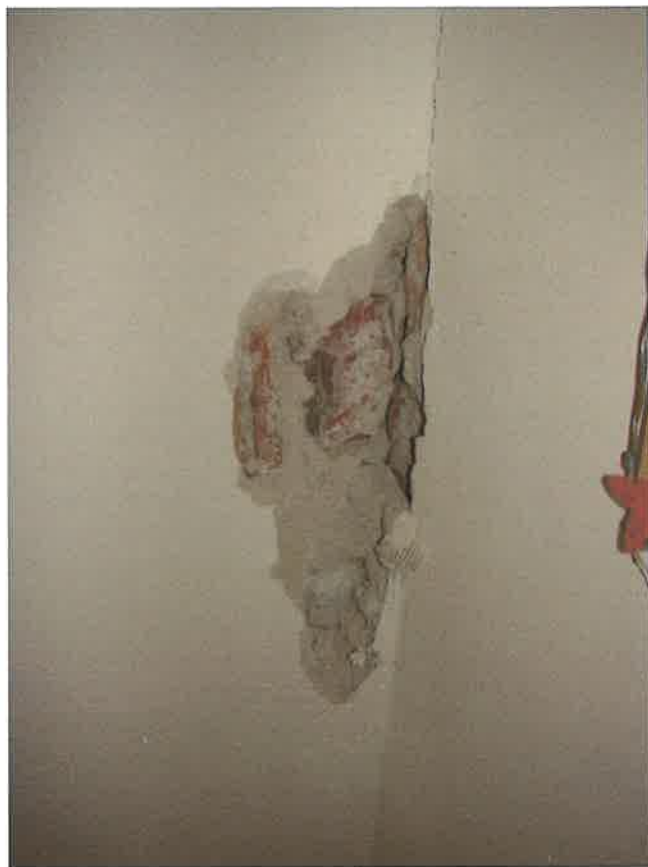
Rysa pionowa w narozu [rys.1] przed rozkuciem.
