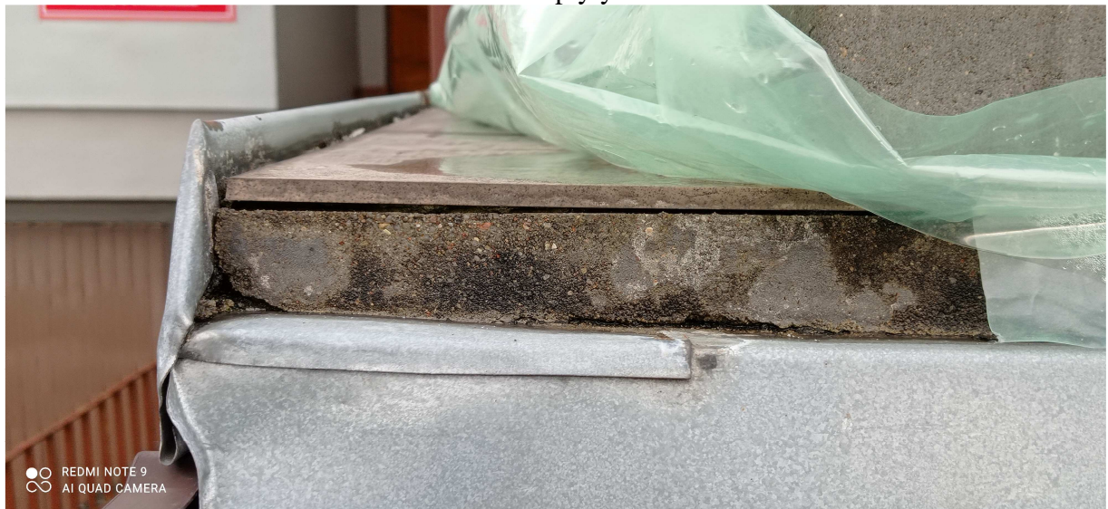
Fot.6. Woda penetruje pod posadzkę oraz wylewkę tarasu.
