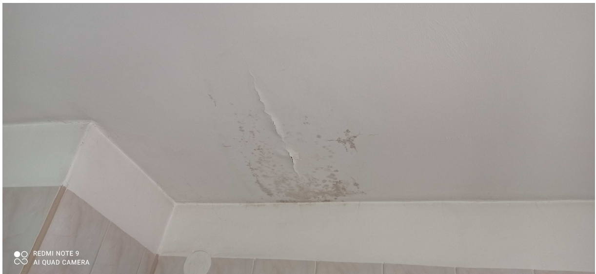
Fot.3. Nieszczelności na połączeniu ściany zewnętrznej i tarasu.
