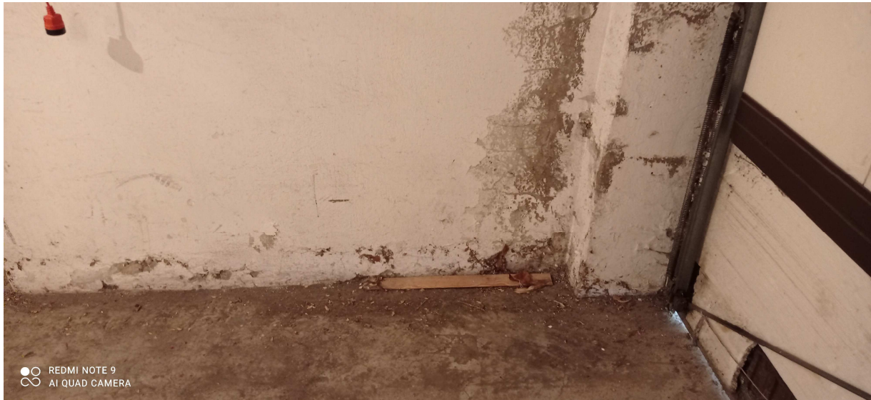
Fot.11. Podsiąkanie kapilarne pod ścianą wewnętrzną w garażu.
