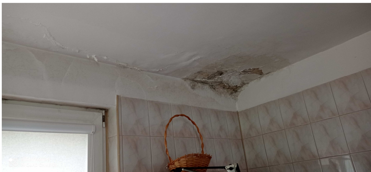
Fot.1. Przeciek w narożniku i wzdłuż całej krawędzi tarasu.
