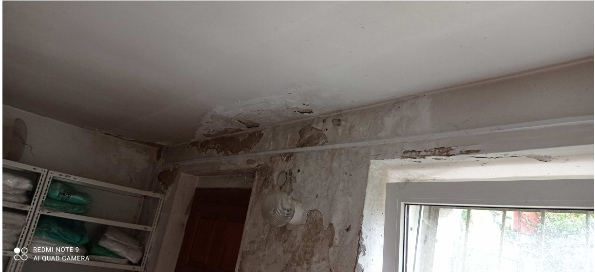
Fot.5. Przecieki wzdłuż obrzeża płyty tarasu.
