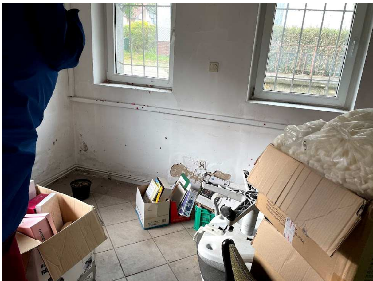
Fot.8. Widoczne podsiąkanie kapilarne wilgoci z gruntu.
