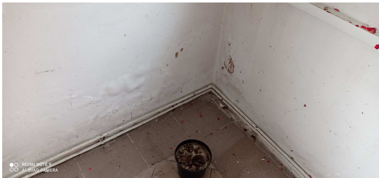
Fot.7. Wilgoć w ścianach wynikająca z braku izolacji lub jej szczątkowej formy.
