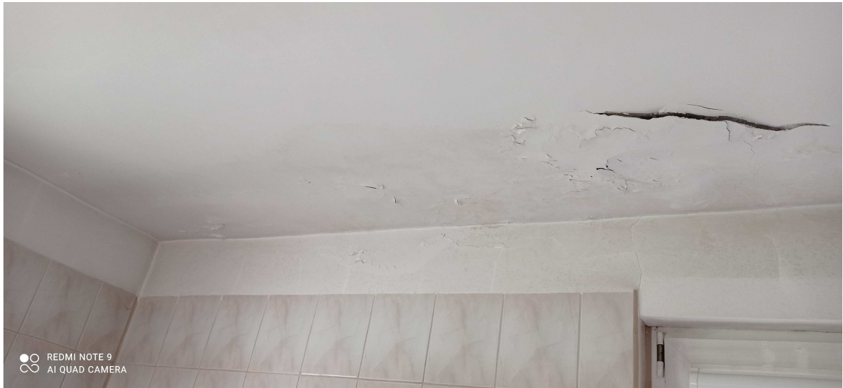
Fot.2. Nieszczelności wzdłuż ściany zewnętrznej laboratorium przy okapie tarasu.
