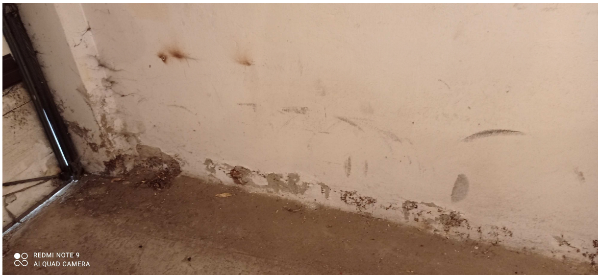
Fot.12. Podsiąkanie kapilarne pod ścianą oraz brak izolacji pionowej.
