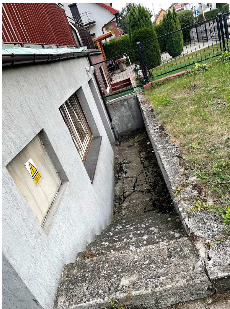
Fot.10. Niedrożność kratki przy dużych opadach deszczu powoduje zalewanie piwnicy.
