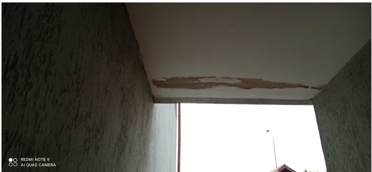
Fot.4. Przecieki na styku ścianki attykowej tarasu i płyty stropu tarasu.
