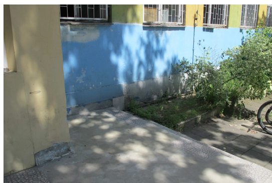
Zniszczone tynki zewnętrzne
