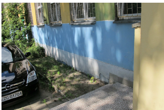
Zniszczone tynki zewnętrzne
