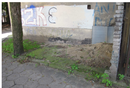
Zniszczone tynki zewnętrzne
