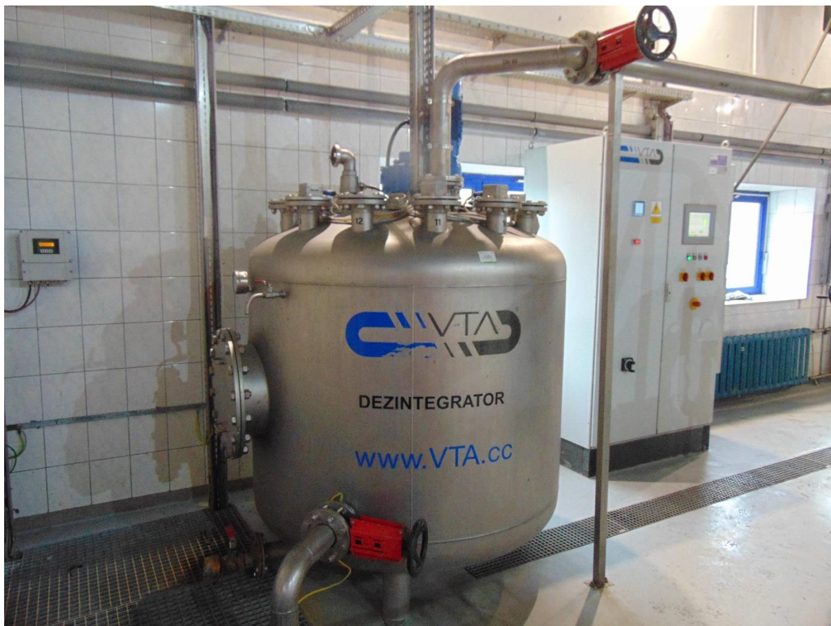
Instalacja dezintegracji Zamawiającego
