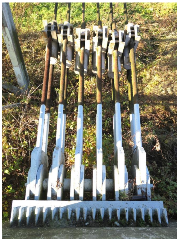
Fot. 4. Widok z góry na zakotwienie lin w bloku kotwiącym
