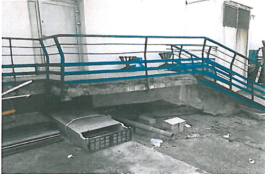
Zdj. nr 6. Ubytki w konstrukcji rampy rozładunkowej.
