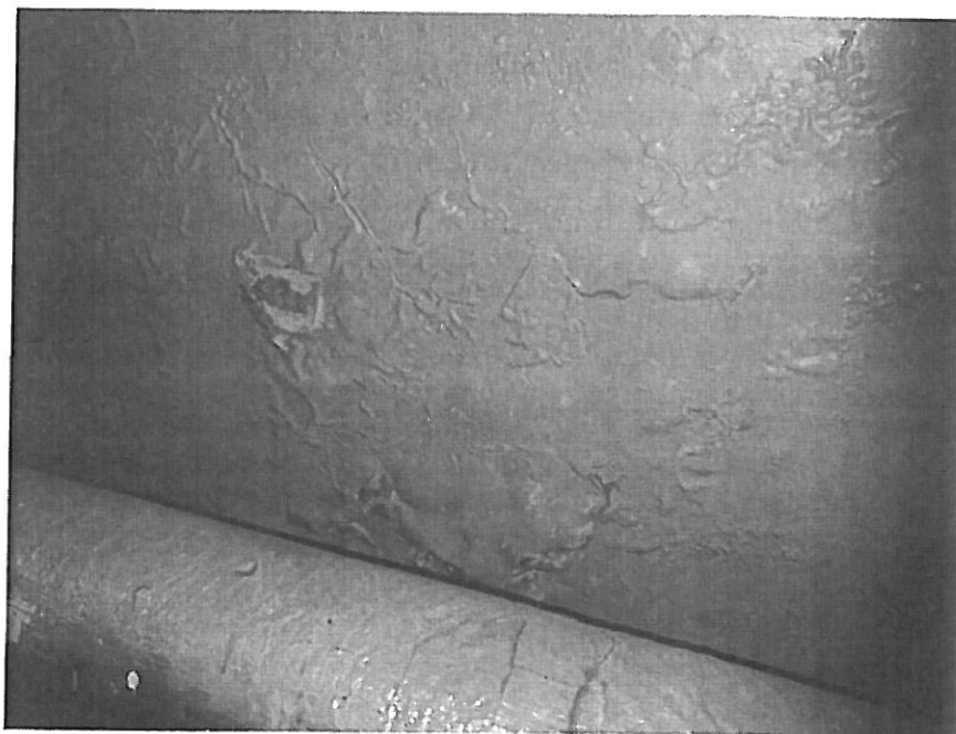
Zdj. nr 3. Zawilgocenia ściany.
