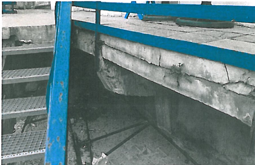
Zdj. nr 7. Ubytki w konstrukcji rampy rozładunkowej.
