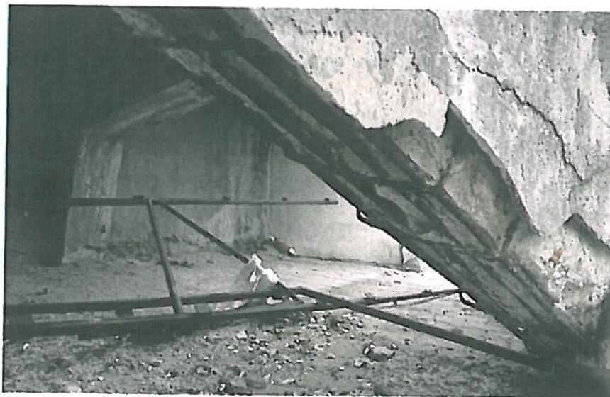
Zdj. nr 8. Ubytki w konstrukcji rampy rozładunkowej.
