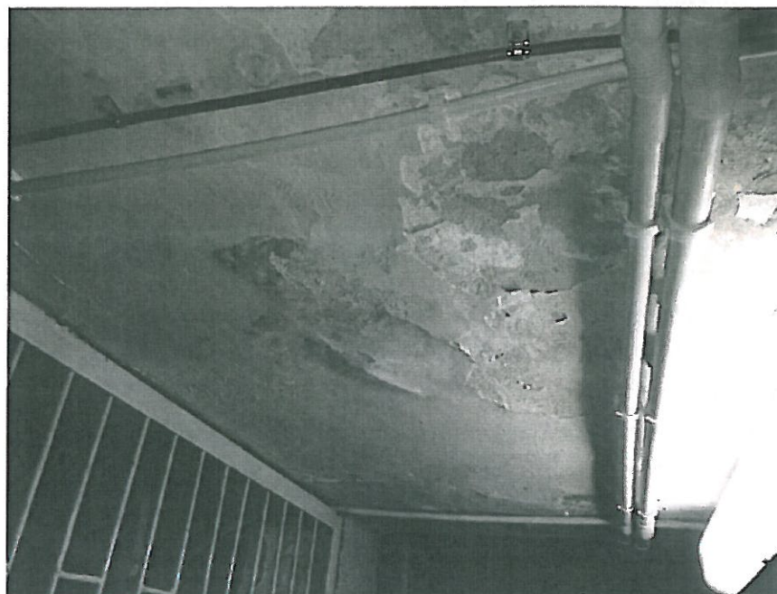
Zdj. nr 2. Zawilgocenia stropu.
