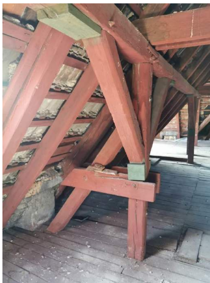
Fot.8. Widok na część ściany stolcowej z zastrzałem – widoczne pęknięcie podłużne słupa powodujące spadek właściwości mechanicznych elementu. Widoczne łączniki stalowe łączące płatwę na podpierającym słupie.
