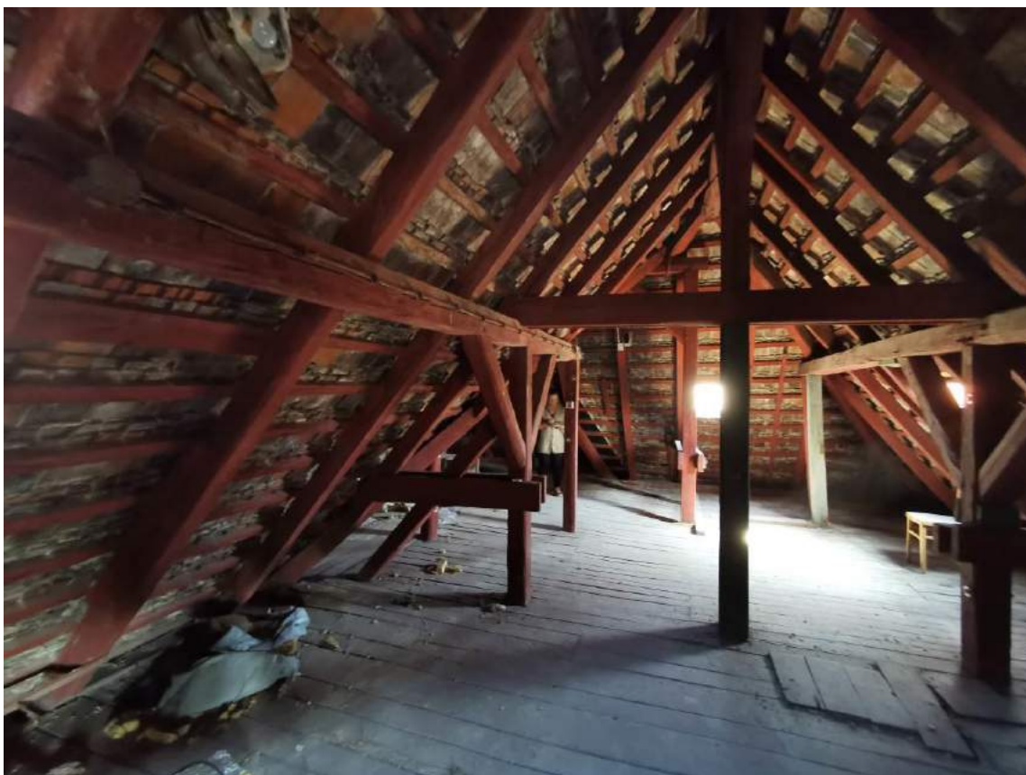
Fot.19. Widok na część ściany stolcowej - widoczne pęknięcia podłużne powodujące spadek właściwości mechanicznych elementu.
