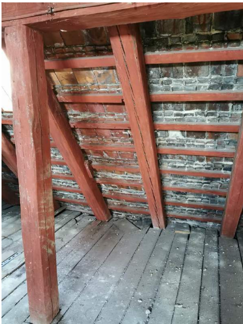
Fot.33. Widok na słup oraz krokwie - widoczne pęknięcia podłużne powodujące spadek właściwości mechanicznych elementu. Wskazane jest dokonanie wzmocnienia elementów splekanych poprzez nakładki drewniane lub stalowe.
