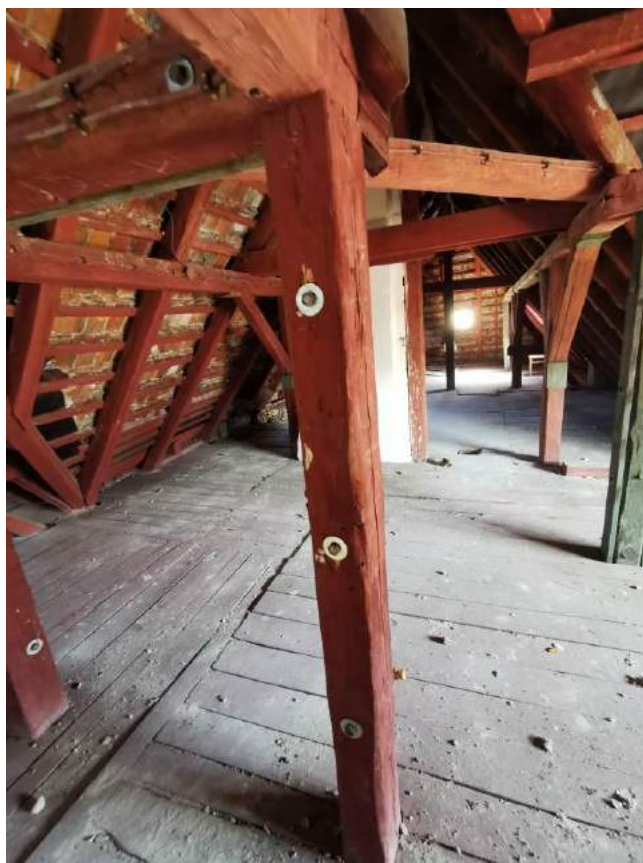
Fot.23. Widok na słup konstrukcyjny - widoczne pęknięcia podłużne powodujące spadek właściwości mechanicznych elementu. Widoczne wzmocnienia mechaniczne – stalowe.
