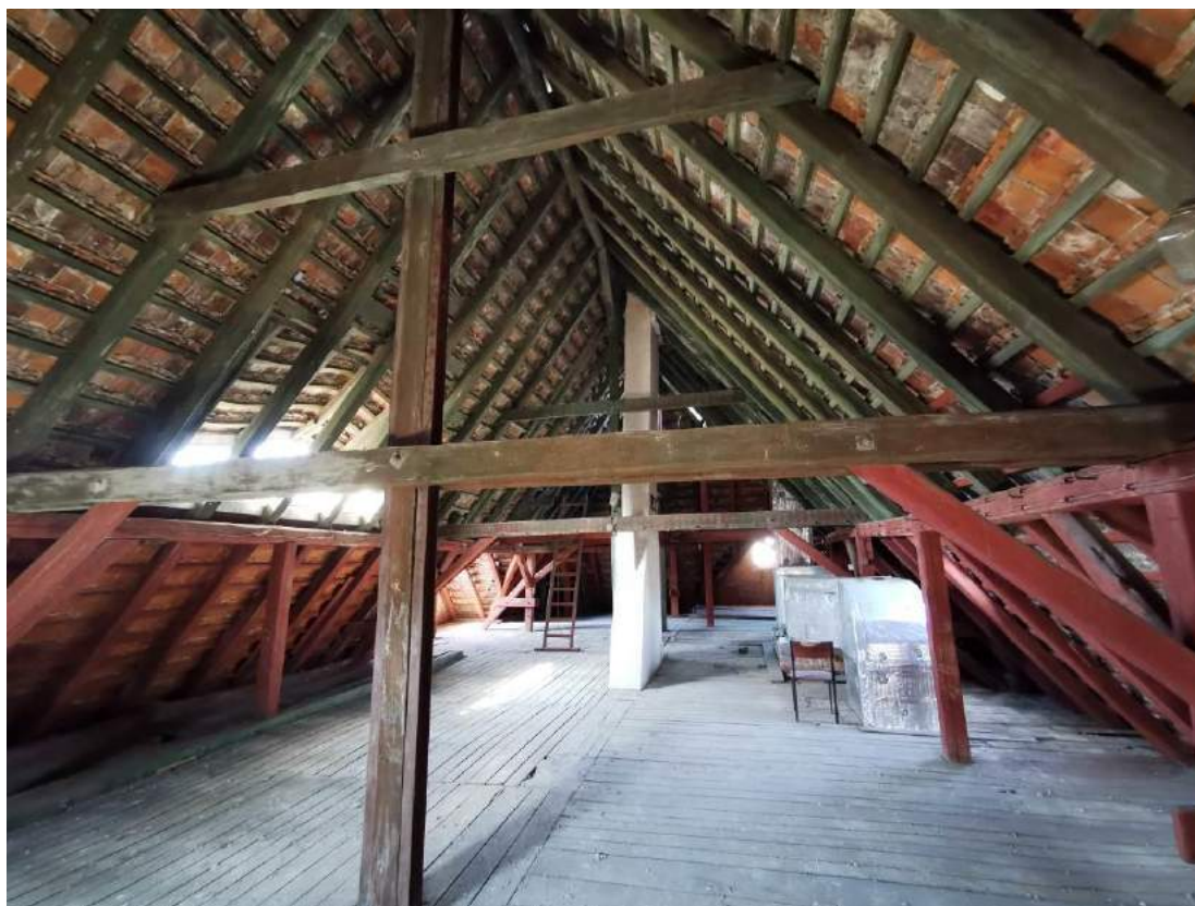
Fot.28. Widok na konstrukcję więźby – widoczne pęknięcia podłużne krokwi powodujące spadek właściwości mechanicznych elementu. Widoczne wzmocnienia mechaniczne – stalowe oraz drewniane słupa konstrukcyjnego.
