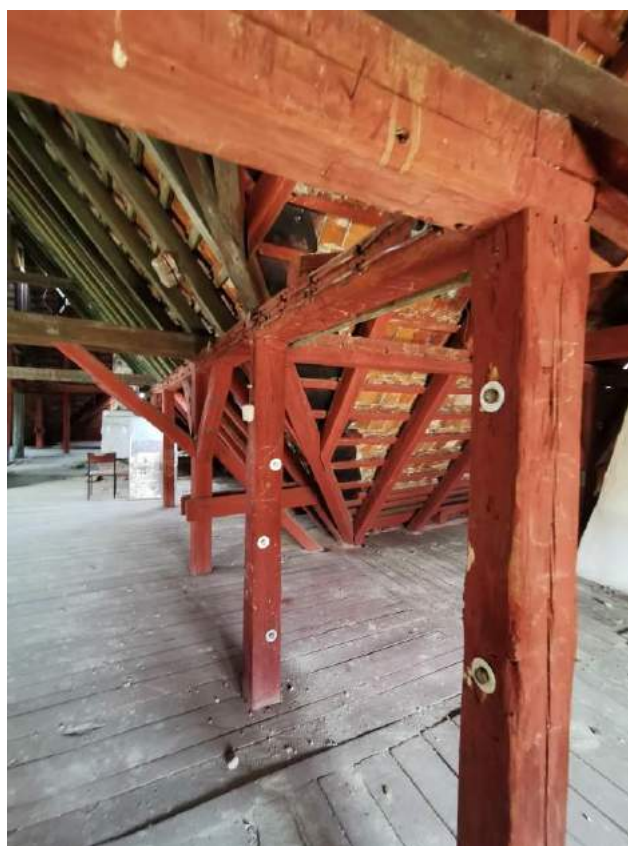
Fot.26. Widok na słupy konstrukcyjne, płatwie oraz krokwie - widoczne pęknięcia podłużne powodujące spadek właściwości mechanicznych elementu. Widoczne wzmocnienia mechaniczne – stalowe oraz drewniane.
