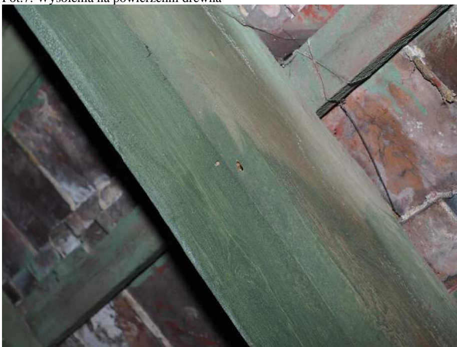
Fot.8. Otwory wylotowe po spuszczelu.
