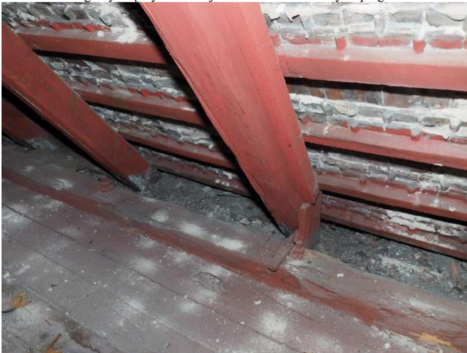
Fot.2. Belka porażona przez owady i grzyby w stanie nieaktywnym
