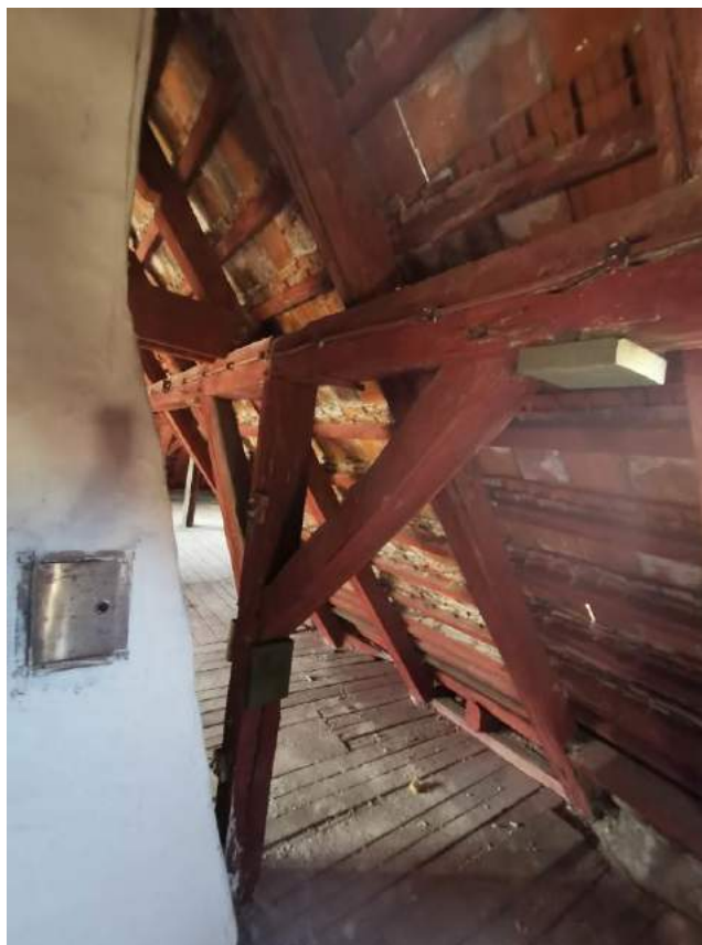
Fot.18. Zbliżenie na miecze oraz płatew - widoczne pęknięcie podłużne powodujące spadek właściwości mechanicznych elementu.
