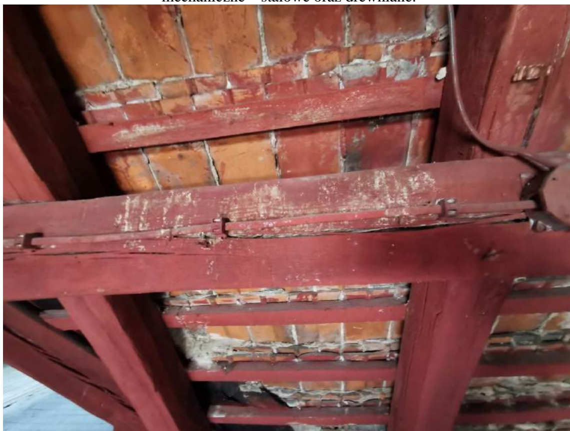
Fot.32. Widok na płatwie - widoczne pęknięcia podłużne powodujące spadek właściwości mechanicznych elementu.
