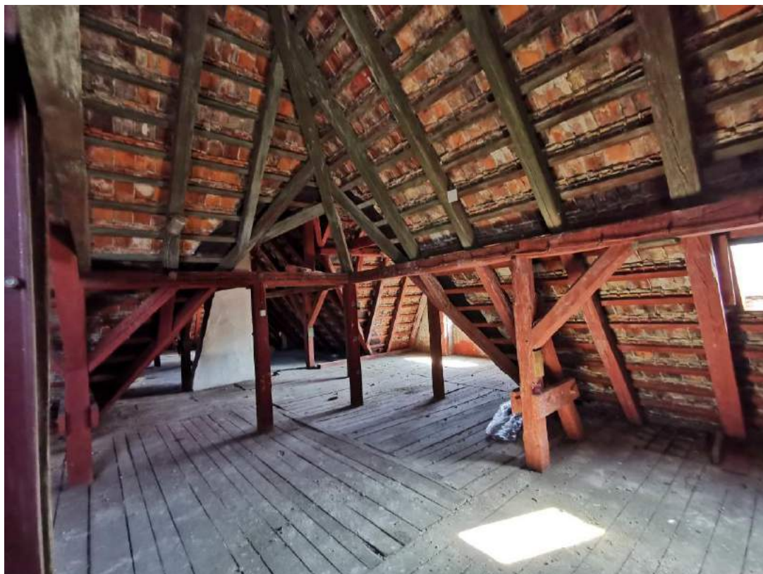
Fot.29. Widok na słupy konstrukcyjne, płatwie oraz krokwie - widoczne pęknięcia podłużne powodujące spadek właściwości mechanicznych elementu. Widoczne wzmocnienia mechaniczne – stalowe oraz drewniane.
