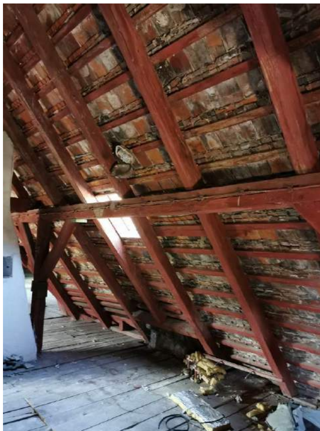
Fot.10. Zbliżenie na płatew oraz krokwie – miejscowe odcinkowe pęknięcia podłużne powodujące spadek właściwości sprężystych elementu.
