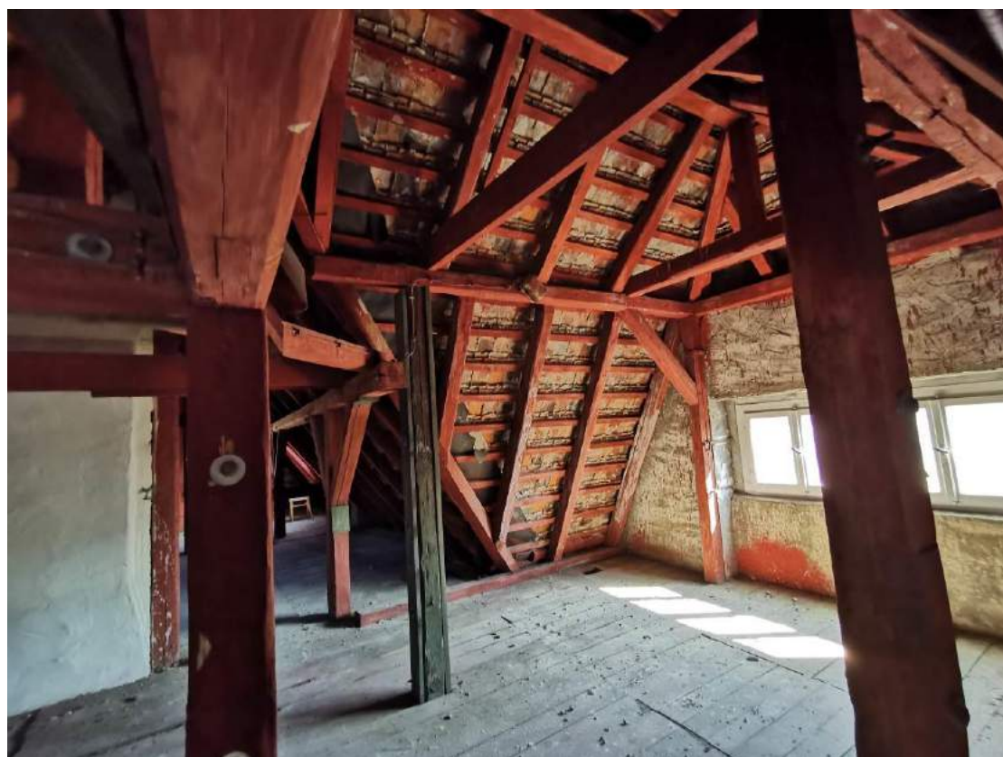
Fot.22. Widok na słupy konstrukcyjne, płatwie oraz krokwie - widoczne pęknięcia podłużne powodujące spadek właściwości mechanicznych elementu. Widoczne wzmocnienia mechaniczne – stalowe.
