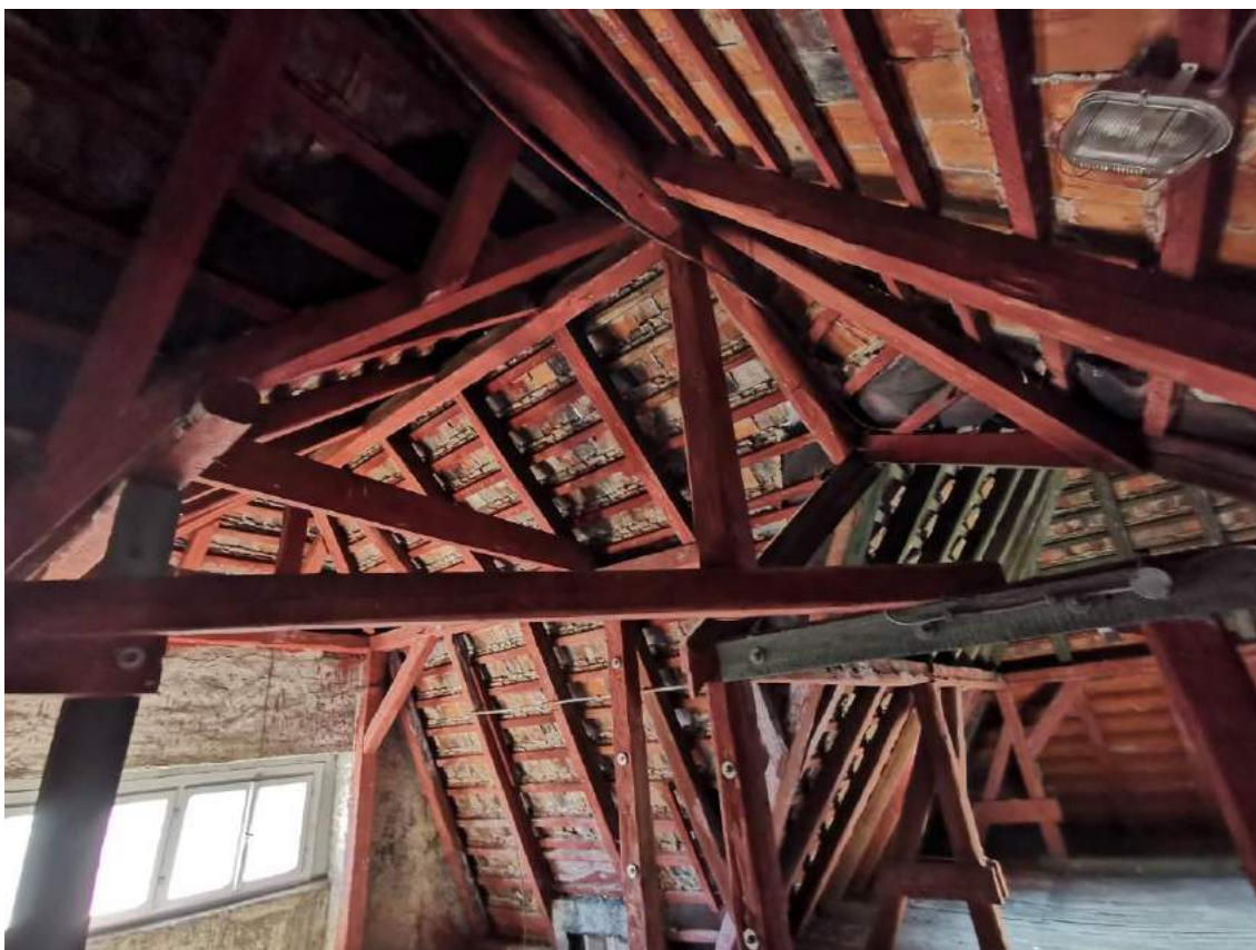
Fot.31. Widok na słupy konstrukcyjne, płatwie oraz krokwie - widoczne pęknięcia podłużne powodujące spadek właściwości mechanicznych elementu. Widoczne wzmocnienia mechaniczne – stalowe oraz drewniane.
