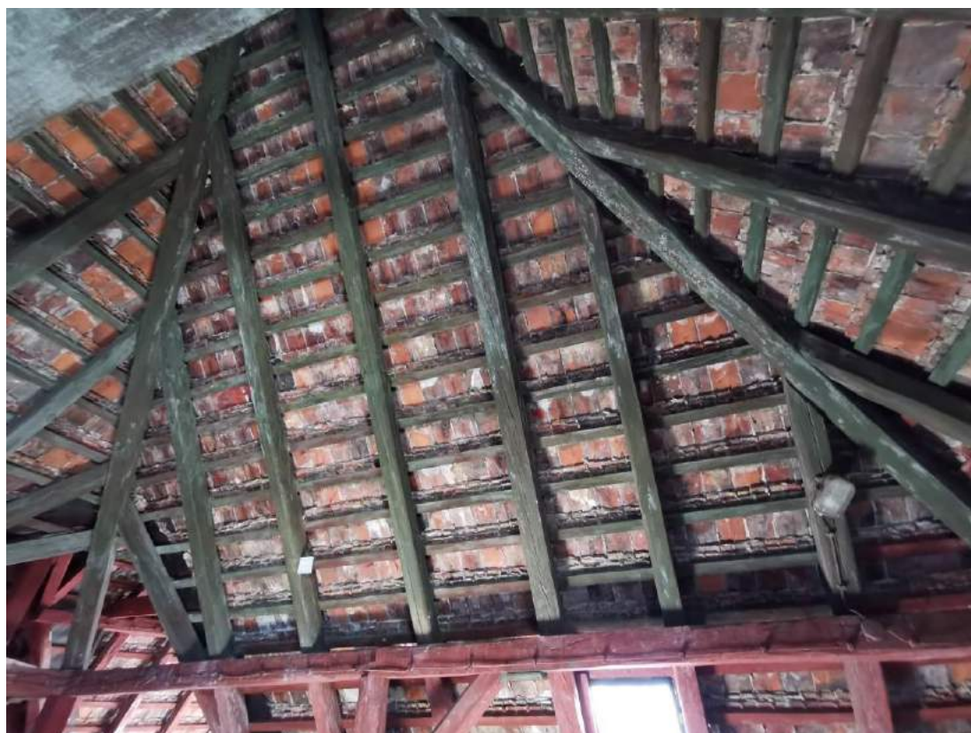
Fot.30. Widok na płatwie oraz krokwie - widoczne pęknięcia podłużne powodujące spadek właściwości mechanicznych elementu. Widoczne wysolenia po zastosowanym impregnacji.
