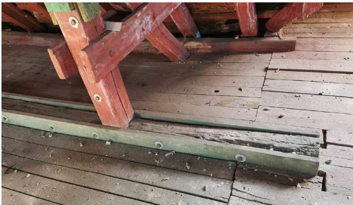
Fot.35. Zbliżenie na podwalinę - widoczne ubytki spowodowane korozją biologiczną. Wykonane istniejące wzmocnienie belki podwalinowej umożliwia pozostawienie takiego rozwiązania pod warunkiem zaimpregnowania postępującej korozji biologicznej podwaliny pierwotnej.
