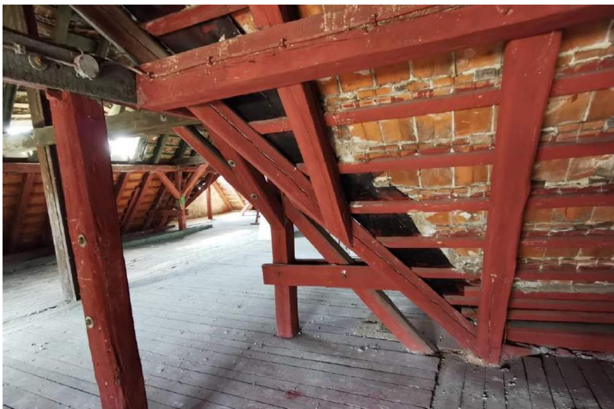
Fot.2. Pęknięcie poziome krokwi koszowej w połowie wysokości przekroju powodujące utratę nośności elementu.
