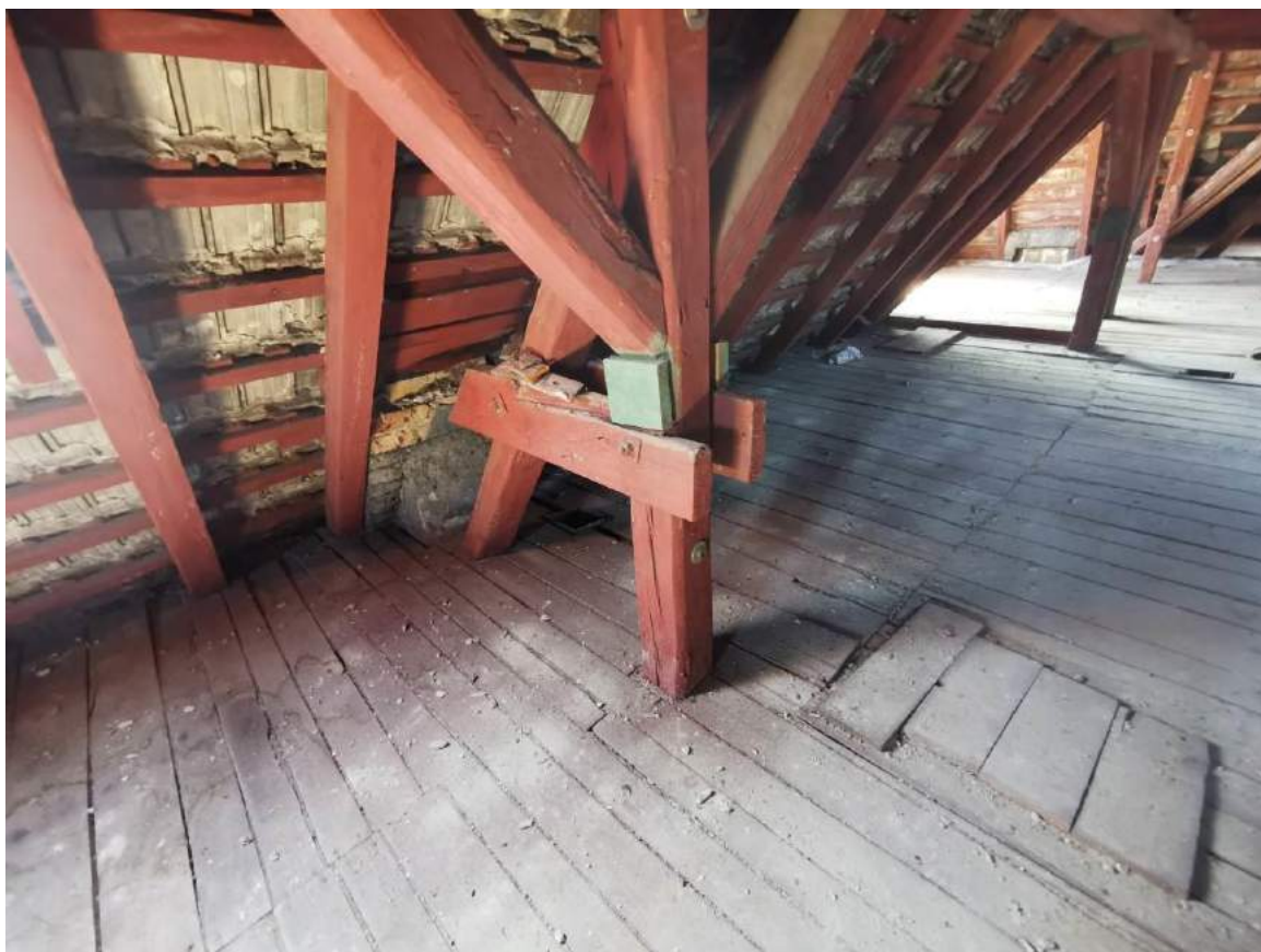
Fot.15. Zbliżenie na miecze - widoczne pęknięcia podłużne powodujące spadek właściwości mechanicznych elementu.
