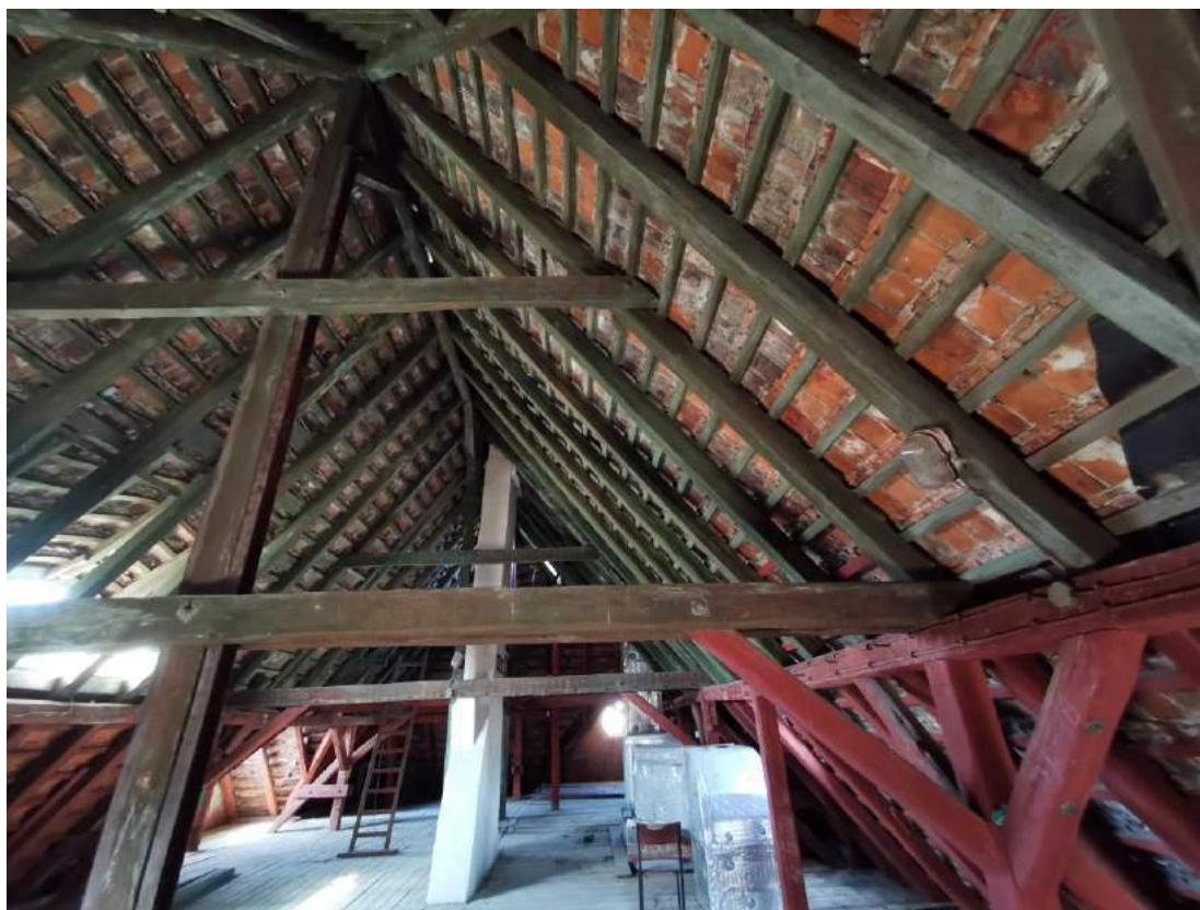
Fot.27. Widok na konstrukcję więźby – widoczne pęknięcia podłużne krokwi powodujące spadek właściwości mechanicznych elementu. Widoczne wzmocnienia mechaniczne – stalowe oraz drewniane słupa konstrukcyjnego.
