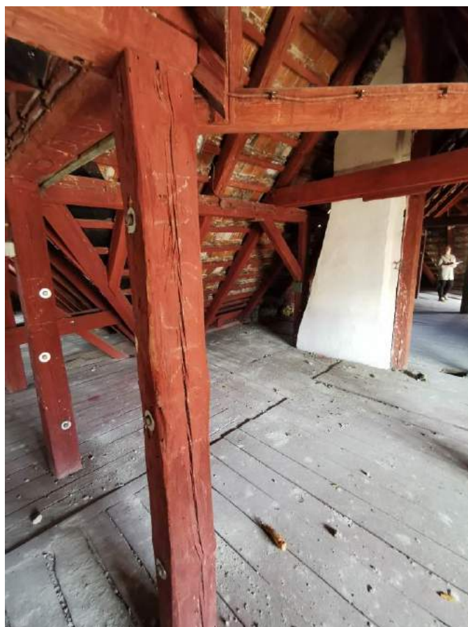
Fot.24. Widok na słup konstrukcyjny - widoczne pęknięcia podłużne powodujące spadek właściwości mechanicznych elementu. Widoczne wzmocnienia mechaniczne – stalowe.
