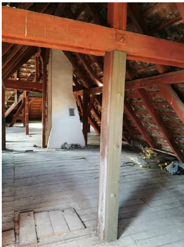
Fot.9. Zbliżenie na istniejące wzmocnienie słupa oraz widoczne przebarwienia powierzchni słupa spowodowane działaniem wilgoci i wytrąceń zasolenia.
