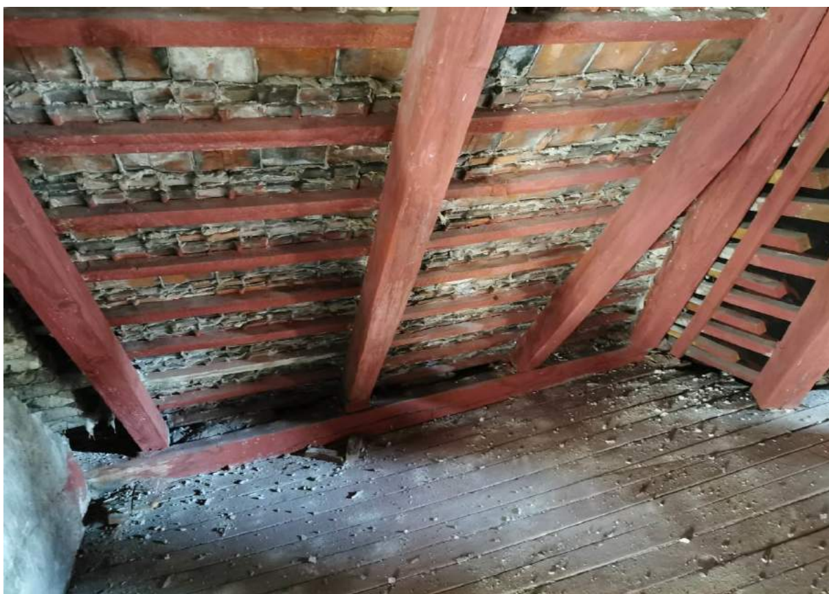
Fot.4. Widok na murłatę – obecność grzybów budowlanych (pleśń szara w lewym narożniku ) spowodowana oddziaływaniem okresowej wilgoci na element.
