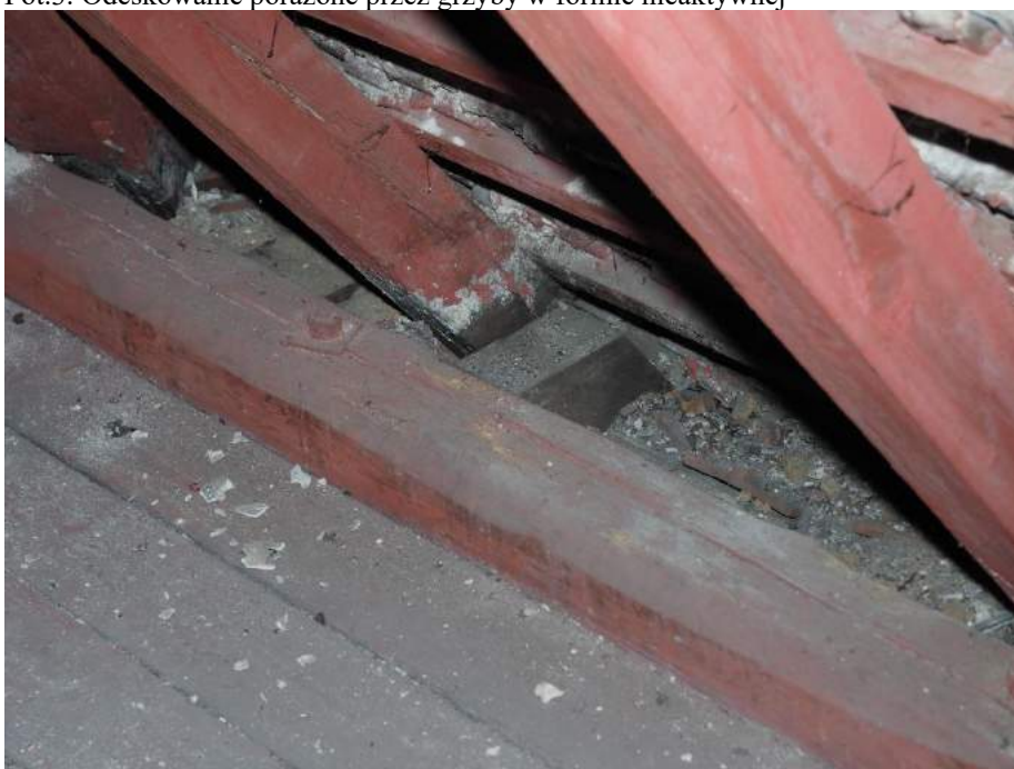
Fot.4. Widoczne połączenie krokwi z belką stropową widoczny powierzchniowy rozkład szary
