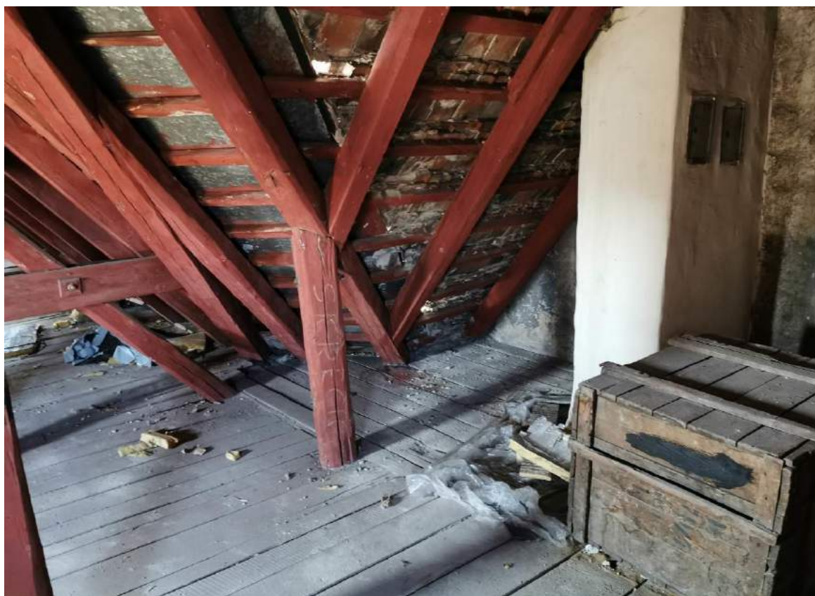
Fot.6. Zbliżenie na słup podpierający krokiew koszową – widoczne pęknięcie podłużne powodujące spadek właściwości mechanicznych elementu.
