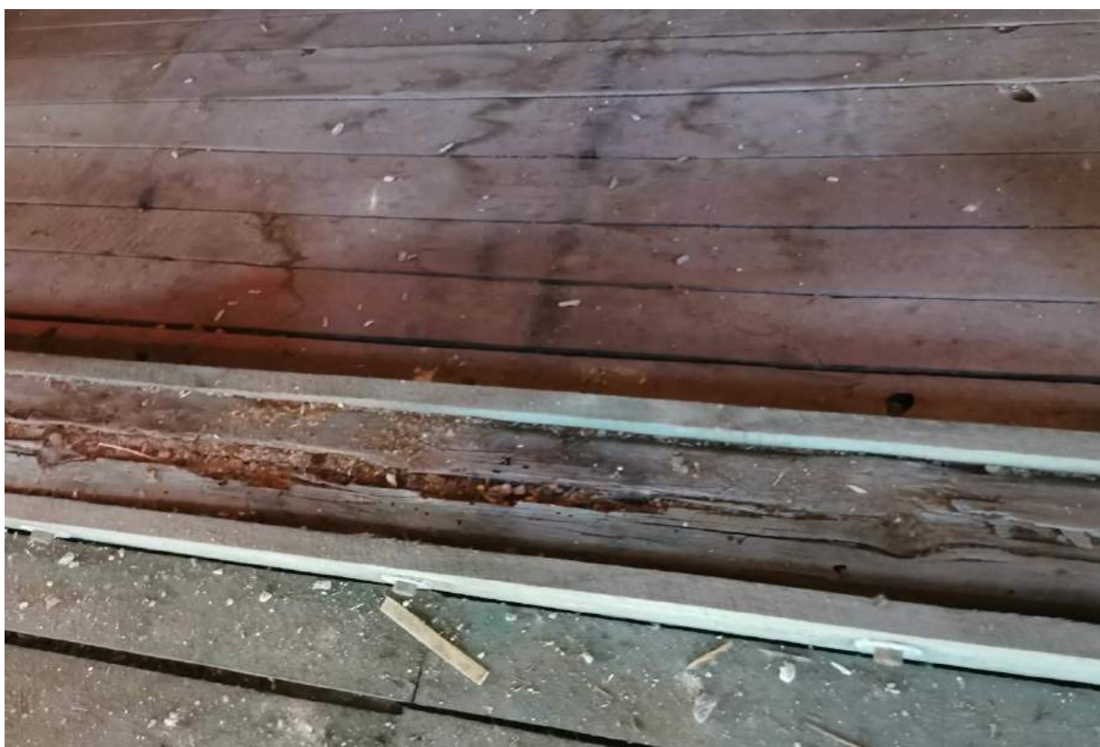
Fot.36. Zbliżenie na podwalinę - widoczne ubytki spowodowane korozją biologiczną.
