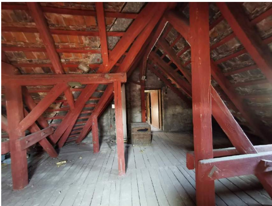
Fot.11. Zbliżenie na słup podpierający krokiew koszową – widoczne pęknięcie podłużne powodujące spadek właściwości sprężystych oraz zwiększenie podatności na lokalne wyboczenie elementu.
