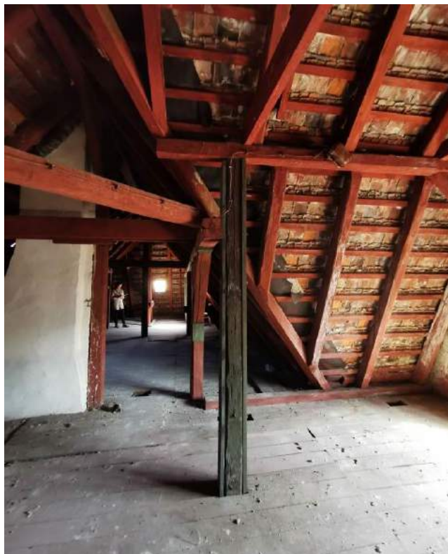
Fot.25. Widok na słupy konstrukcyjne, płatwie oraz krokwie - widoczne pęknięcia podłużne powodujące spadek właściwości mechanicznych elementu. Widoczne wzmocnienia mechaniczne – stalowe oraz drewniane.
