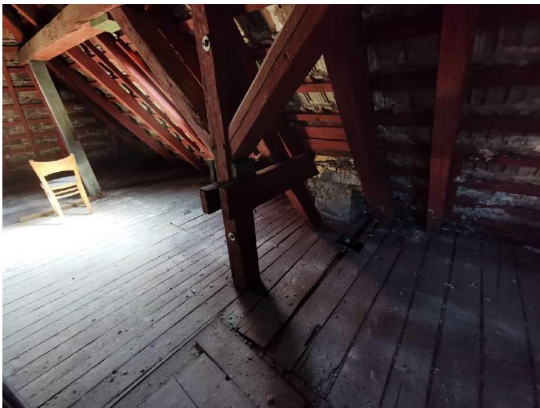
Fot.13. Zbliżenie na miecze - widoczne pęknięcie podłużne powodujące spadek właściwości mechanicznych elementu. Widok na podłogę drewnianą z miejscowymi ubytkami desek.
