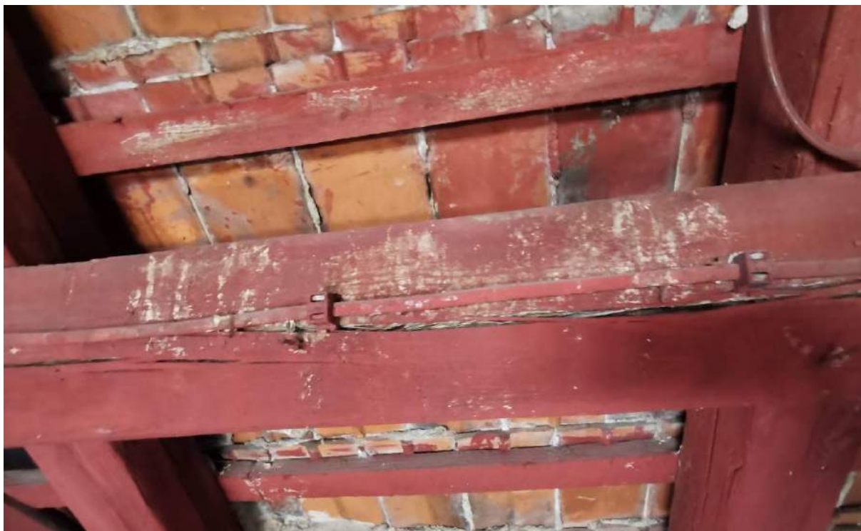
Fot.3. Pęknięcie poziome płatwi pośredniej w połowie wysokości przekroju powodujące utratę nośności elementu.
