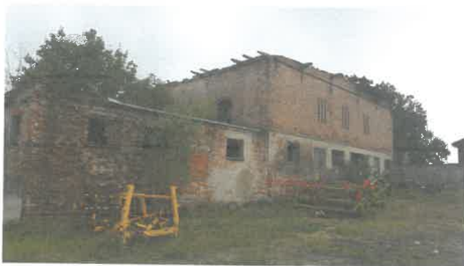
Fot. 17 – Elewacja zachodnia (uszkodzony dach i ściany)
