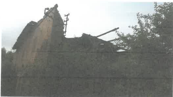
Fot. 15 – Narożnik obory płn./wsch. (uszkodzone ściany i zerwany dach)
