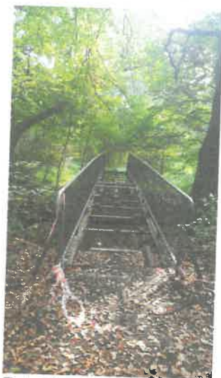
Fot. 38 – Mostek – widok ogólny (zabezpieczyć wejścia siatką)
