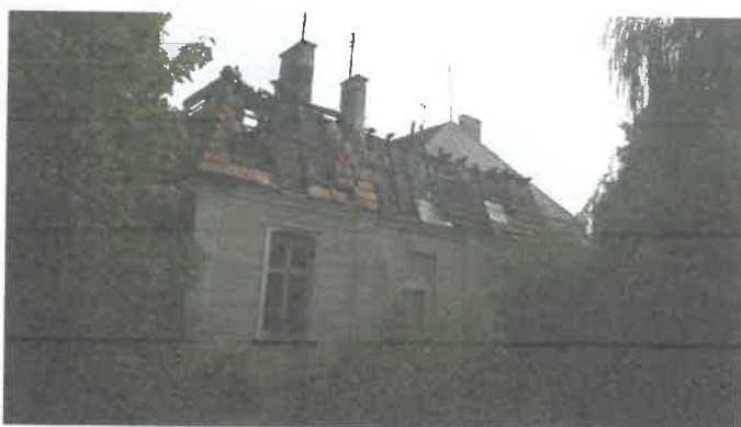
Fot. 5 – Narożnik dworku ptn./zach. (spalony dach)
