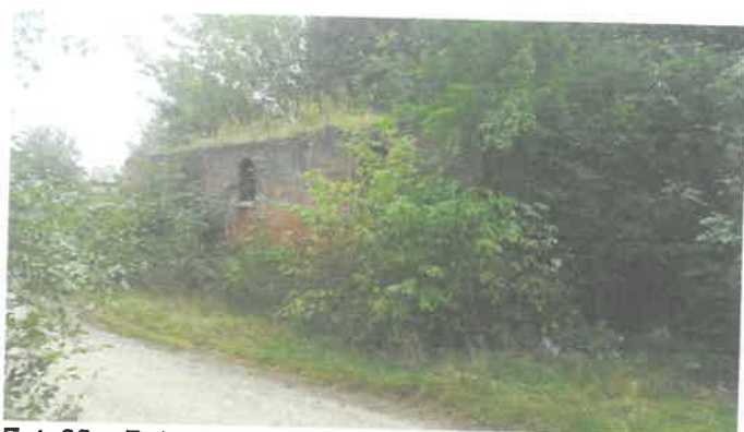
Fot. 32 – Ruiny budynku gospodarczego – Elewacja północna
