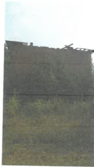
Fot. 9 – Elewacja zach.(spalony dach)
