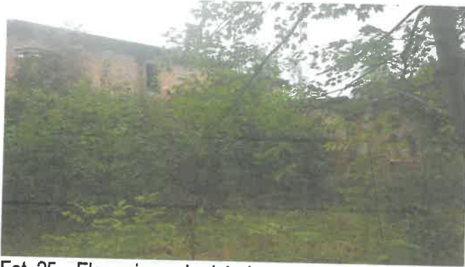
Fot. 25 – Elewacja wschodnia (zarośnięta krzakami)
