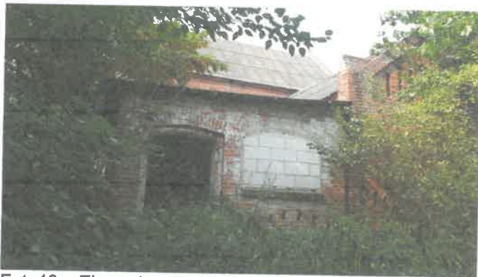
Fot. 13 – Elewacja wschodnia (zarośnięta krzakami)
