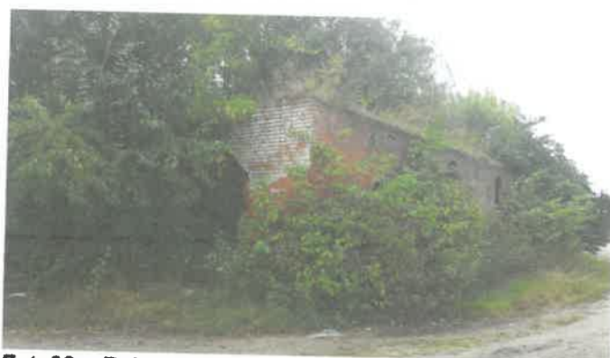
Fot. 33 – Ruiny budynku gospodarczego – Elewacja półn./wsch.
