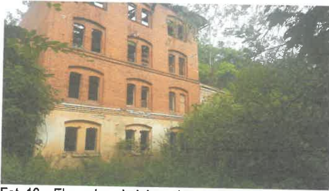
Fot. 10 – Elewacja południowa (spalony dach)
