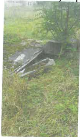
Fot. 28 – Otwór przed stajnią (#1x3 m) – do zabezpieczenia – szt. 1
