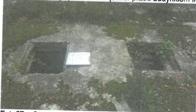
Fot. 27 – Otwory na płycie zbiornika na gnojowicę (#60x60 cm), do zabezpieczenia – szt. 3
