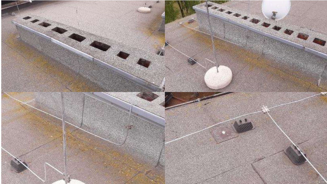
Zdjęcia przedstawiają kominy wentylacyjne z otworami do góry, luźne łączniki instalacji odgromowej i ich brak na budynku internatu.
