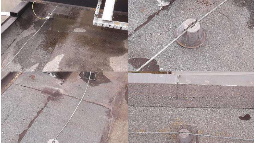
Zdjęcia przedstawiają zastoiny wody w miejscu podparcia konstrukcji nośnej alternatywnego ogrzewania oraz luźną instalację odgromową na budynku łącznika.
