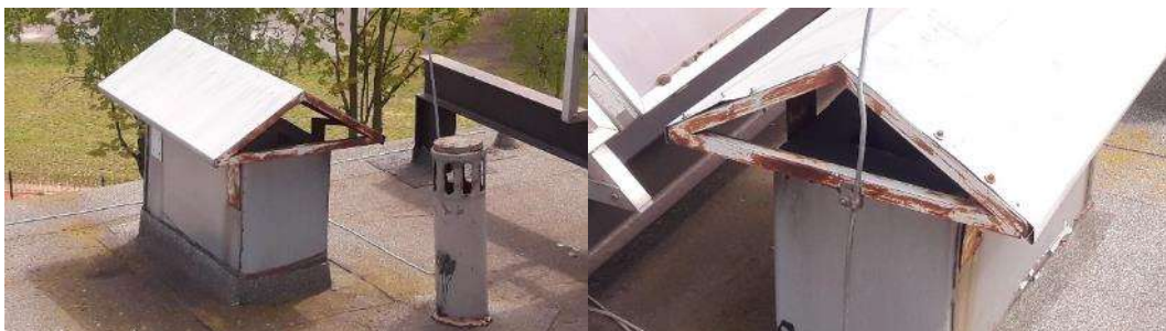
Zdjęcia przedstawiają wywiewki zbiorcze wentylacji – stalowe, ze śladami korodowania na budynku internatu.
