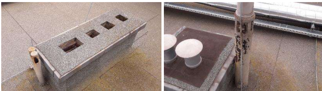
Zdjęcia przedstawiają kominy wentylacyjne z otworami usytuowanymi do góry i zardzewiały kominek wentylacji kanalizacyjnej na budynku łącznika.
