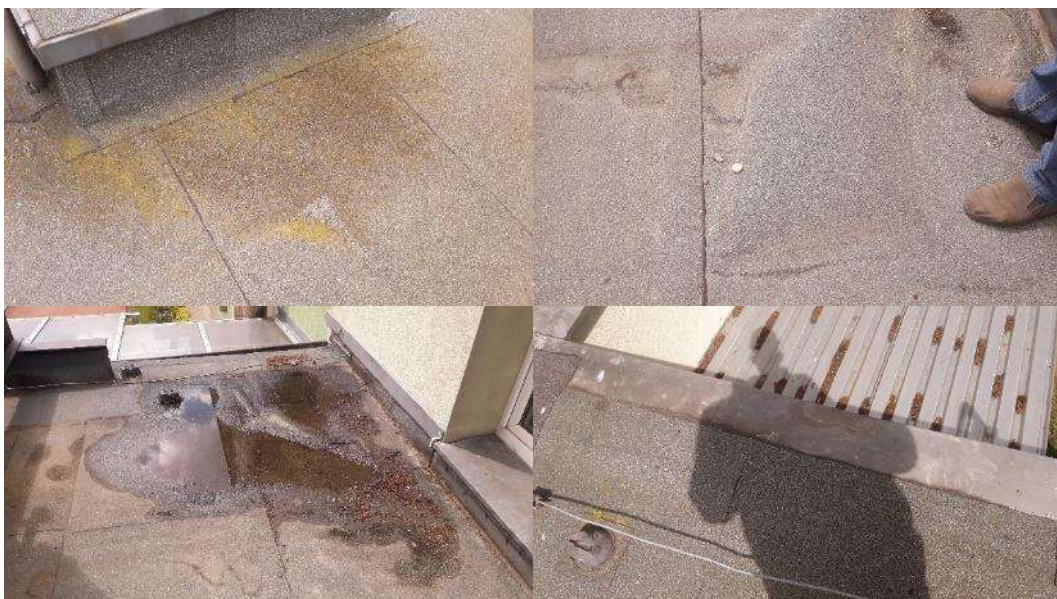
Zdjęcia przedstawiają zastoiny wody na połaci dachowej oraz pęcherze powstałe pod papą termozgrzewalną, biodegradację połaci, i rdzewiejące obróbki na budynku łącznika.
