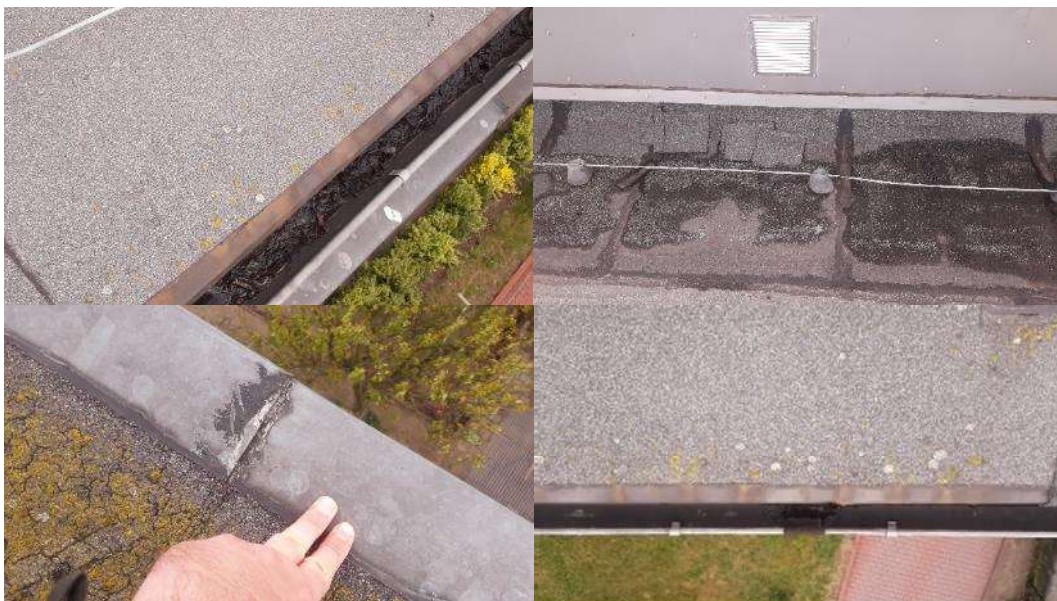
Zdjęcia przedstawiają rdzewiejące obróbki blacharskie oraz łaty papy w miejscach prawdopodobnych nieszczelności na budynku internatu.
